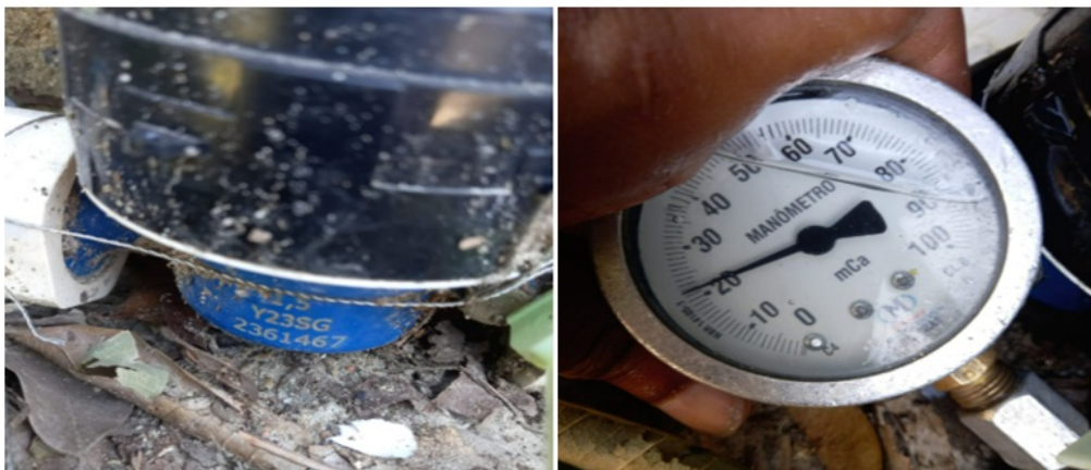
Foto 08 - Pressão no momento da vistoria técnica, 21 mca
