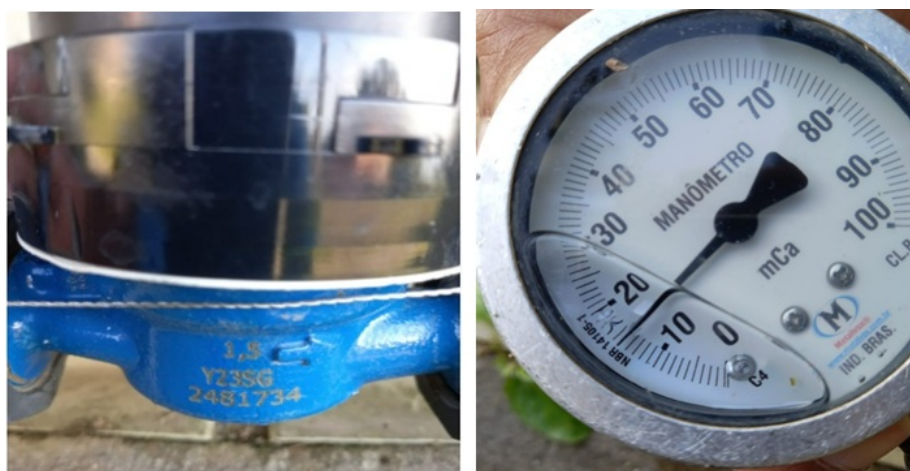
Foto 15 - Pressão no momento da vistoria técnica, 15 mca
