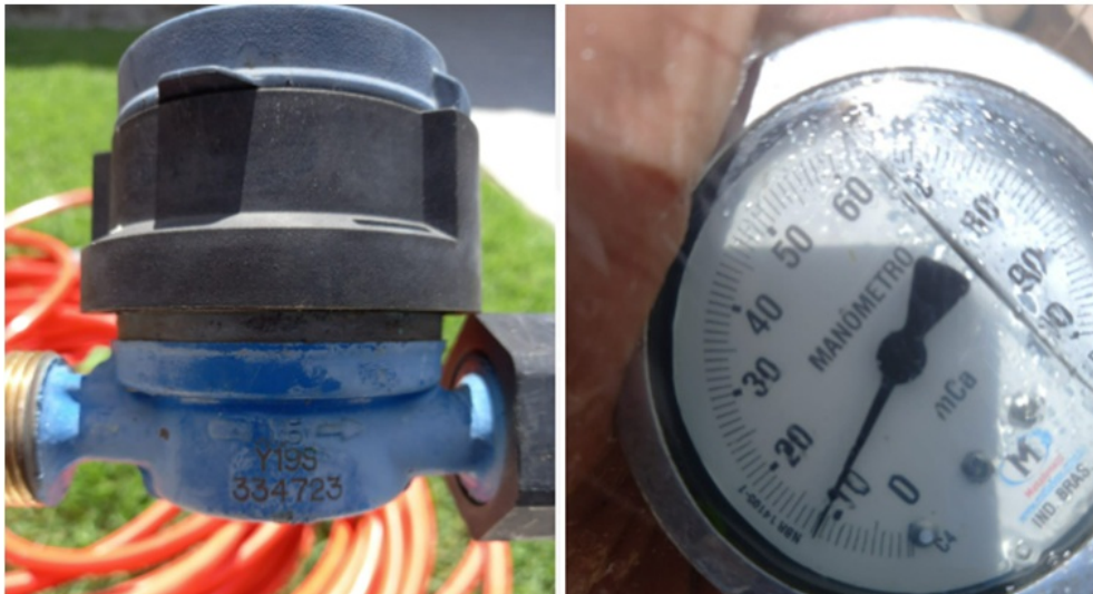
Foto 17 - Pressão no momento da vistoria técnica, 15 mca
