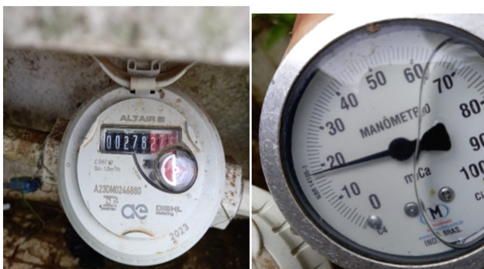
Foto 13 - Pressão no momento da vistoria técnica, 18 mca
