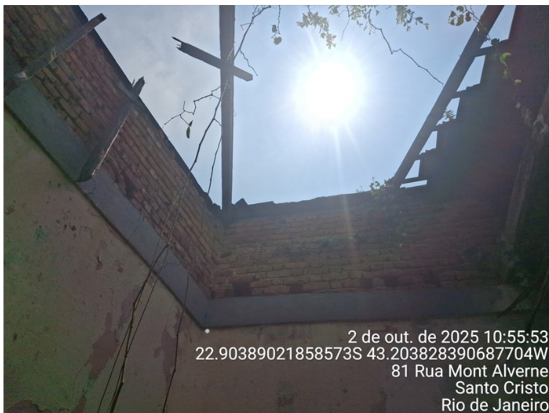
Foto 9 – Cobertura colapsada casa operador
