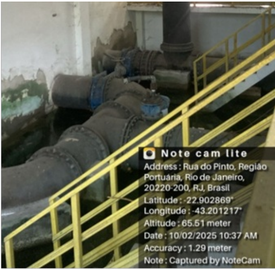
Foto 17 – Barrilete do reservatório
