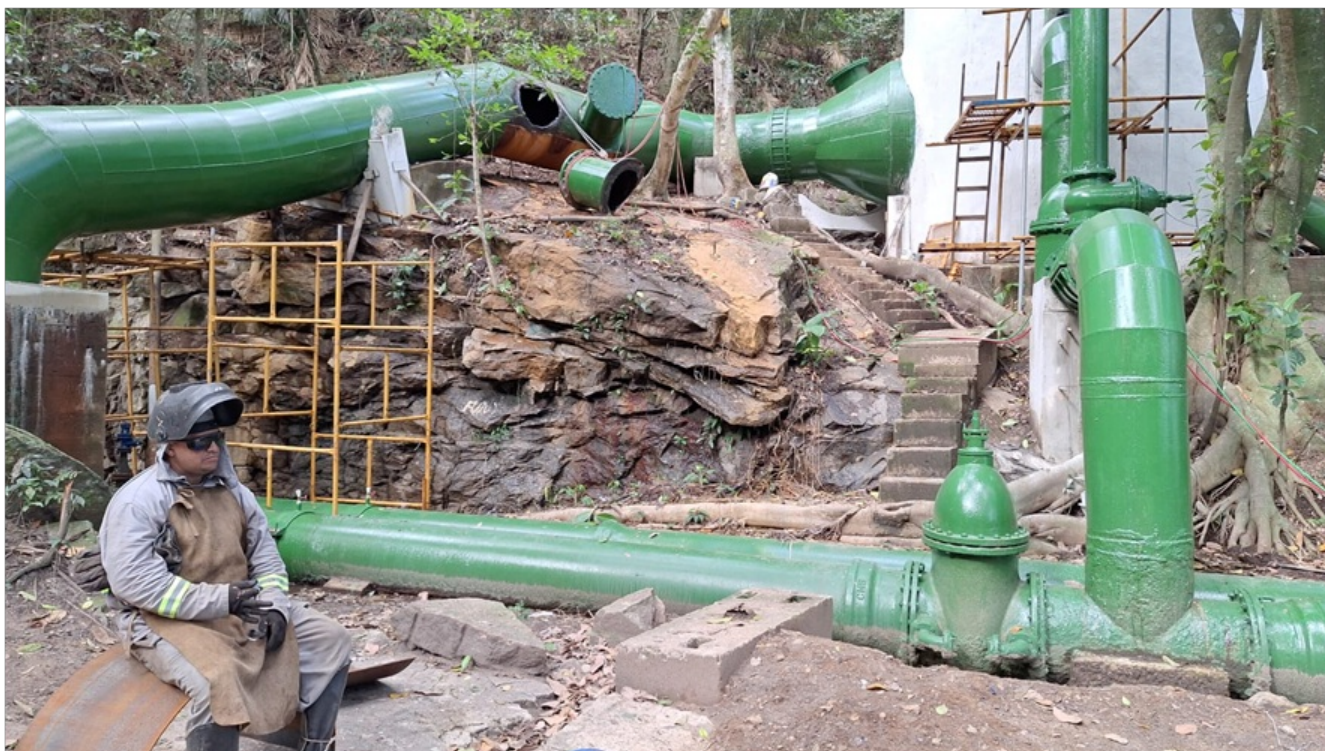
Foto 1 – Vista do “garrafão” responsável pelo abastecimento de água de parte da Zona Sul (origem no reservatório dos Macacos)
