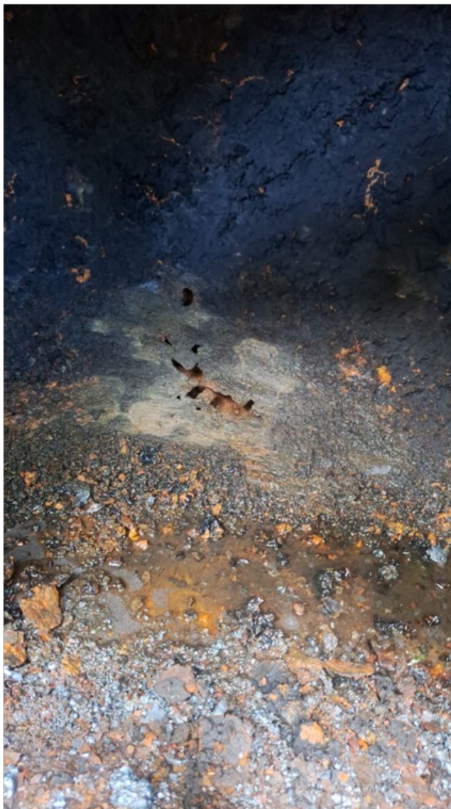
Foto 7 – Vista interna da tubulação DN 1000 mm (tubulação desgastada)
