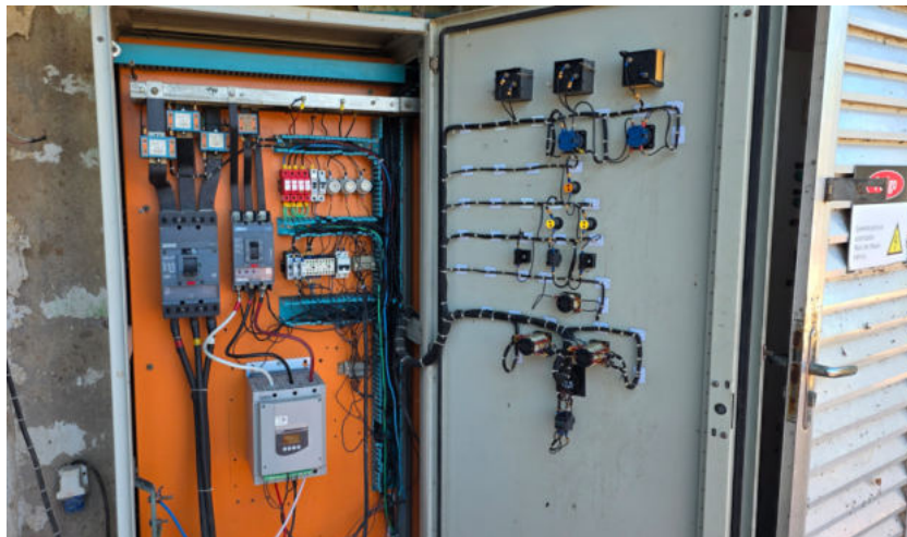
Foto 96 – Painel elétrico da EEEB no abrigo
