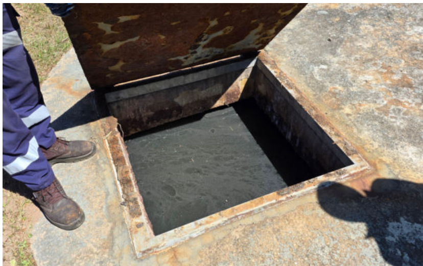
Foto 97 – Poço da chegada do esgoto sem gradeamento para remoção dos sólidos
