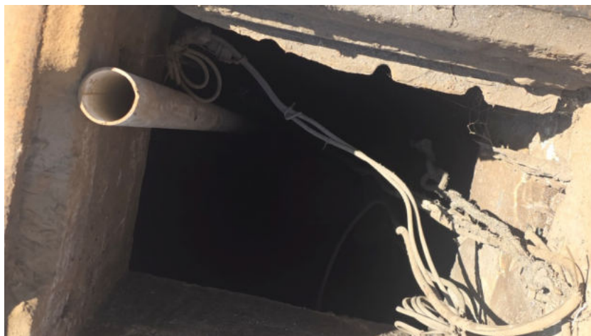
Foto 6 – Poço de sucção onde estão instalados os conjuntos motobombas submersos
