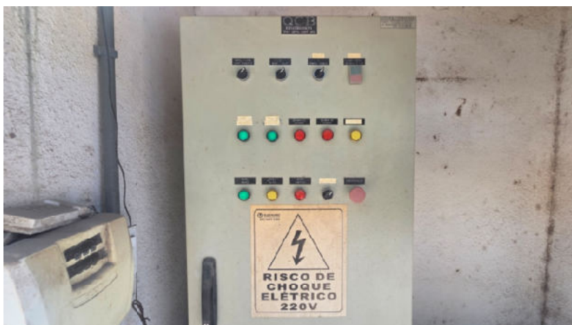
Foto 8 – Painel da EEEB no abrigo
