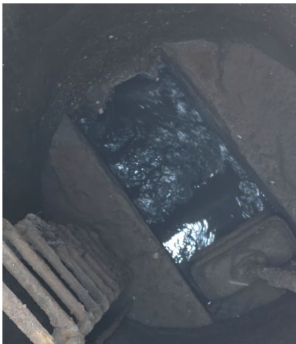
Foto 68 – Poço da chegada do esgoto sem gradeamento para remoção dos sólidos
