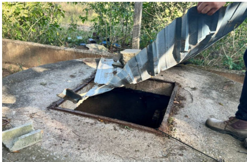
Foto 114 – Poço de sucção onde estão instalados os conjuntos motobombas submersos
