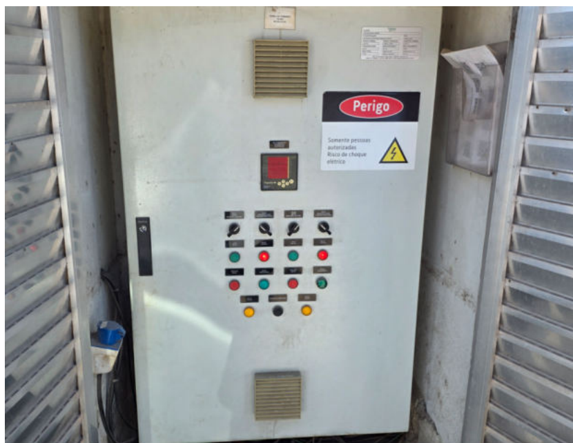
Foto 33 – Painel da EEEB no abrigo
