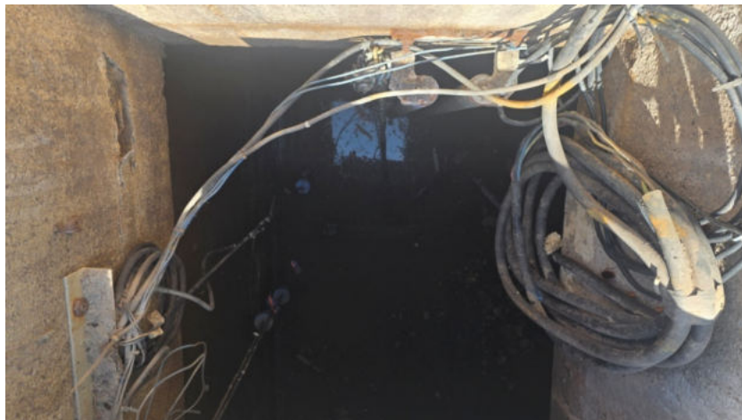
Foto 11 – Poço de sucção onde estão instalados os conjuntos motobombas submersos
