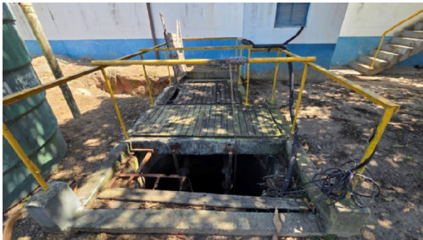
Foto 31 – Poço de sucção onde estão instalados os conjuntos motobombas submersos
