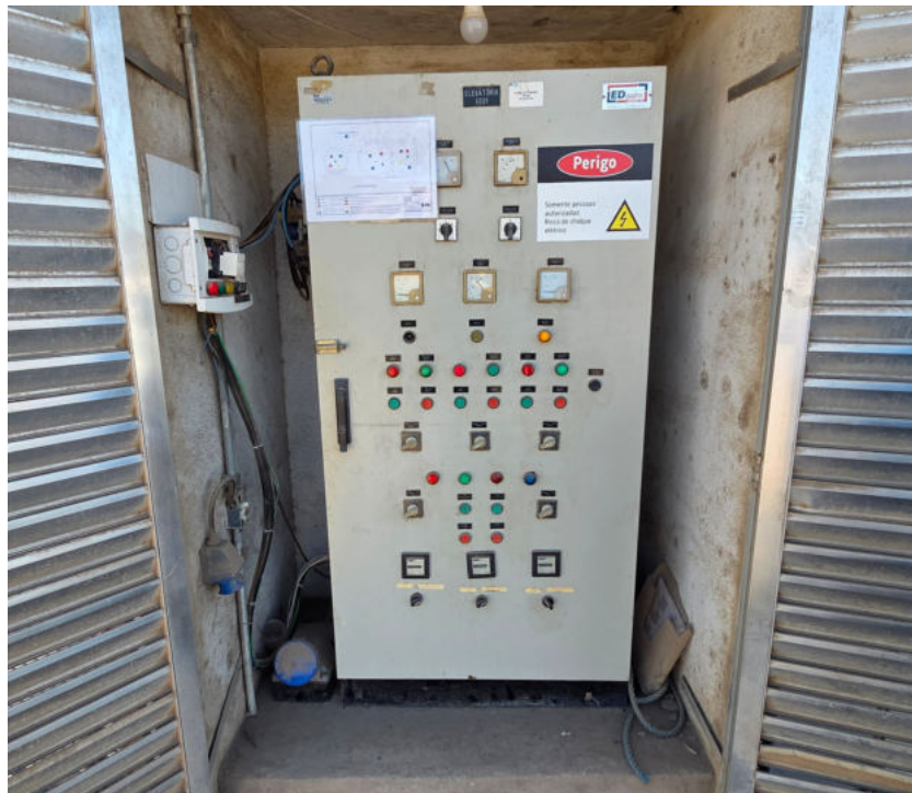
Foto 58 – Painelelétrico da EEEB
