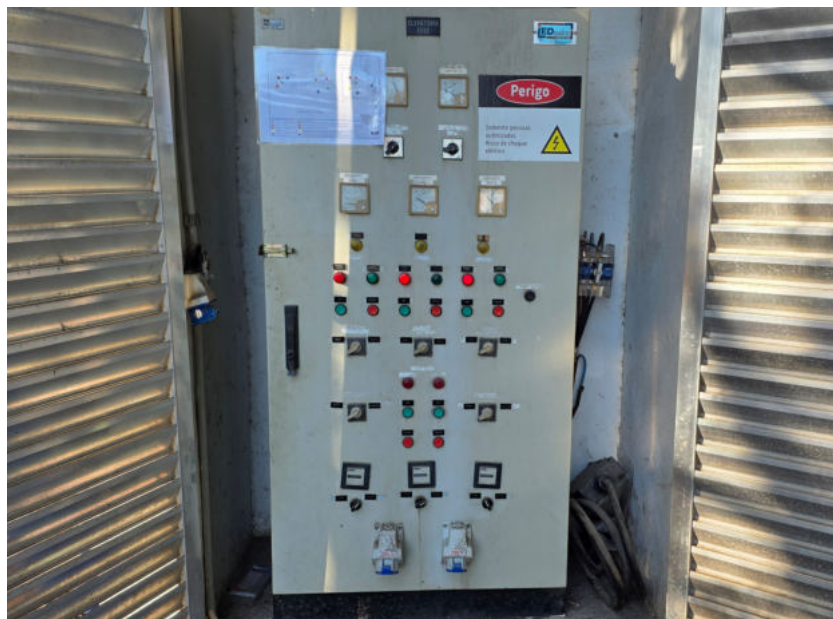
Foto 66 – Painelelétrico da EEEB
