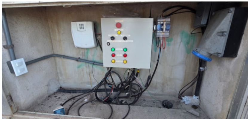
Foto 71 – Pannel elétrico da EEEB no abrigo
