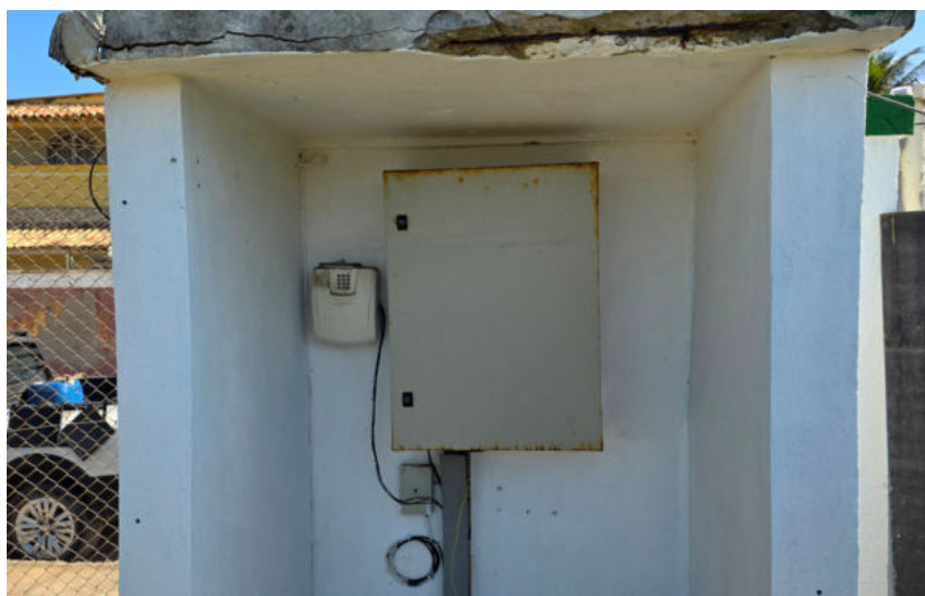
Foto 41 – Painel da EEEB no abrigo sem sinalização de risco
