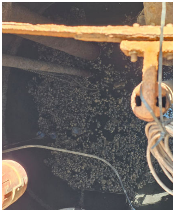
Foto 85 – Poço de sucção onde estão instalados os conjuntos motobombas submersos
