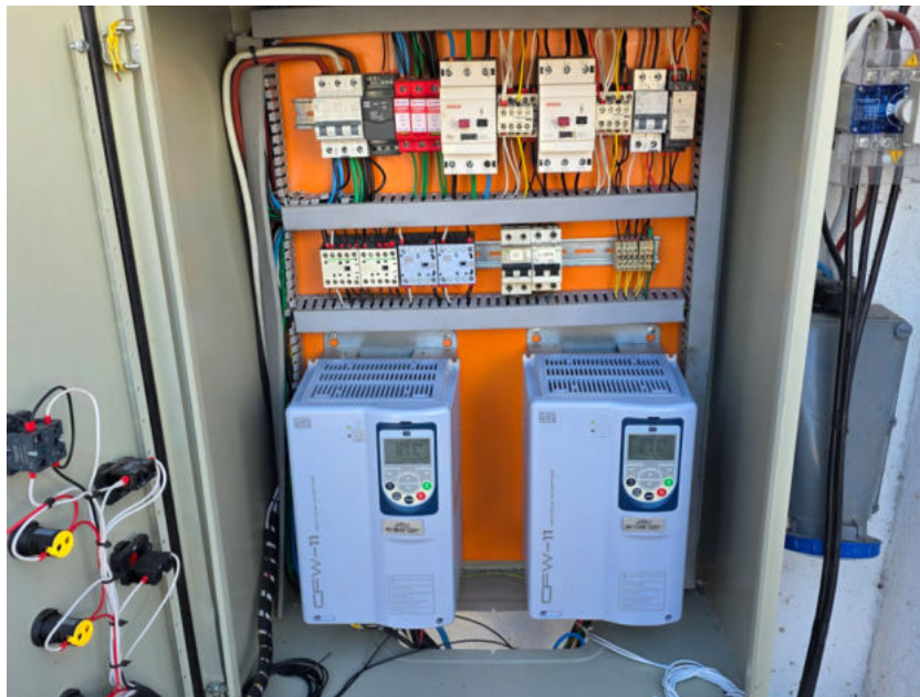
Foto 51 – Painel elétrico da EEEB
