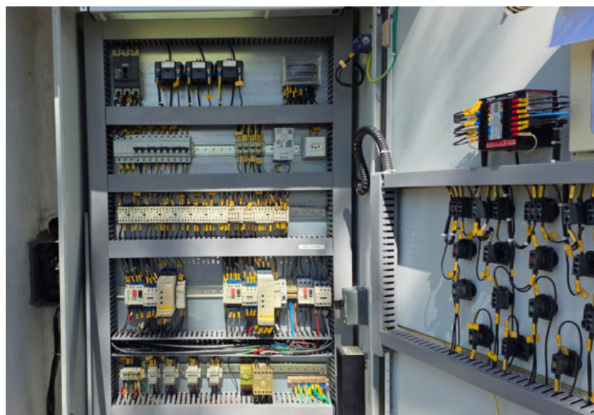
Foto 84 – Painel elétrico da EEEB
