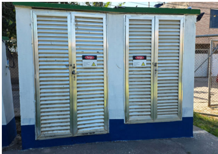
Foto 46 –Abrigo do painel da EEEB
