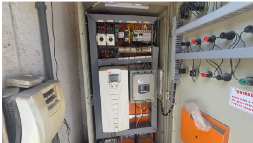
Foto 9 – Paineleletrico da EEEB
