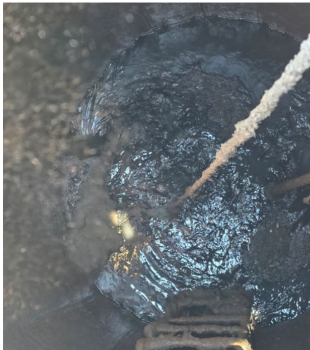
Foto 48 – Poço da chegada do esgoto sem gradeamento para remoção dos sólidos
