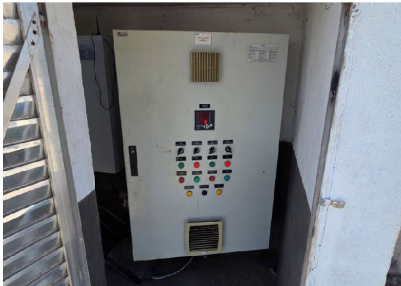
Foto 13 – Pannel da EEEB no abrigo
