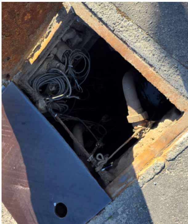
Foto 64 – Poço de sucção onde estão instalados os conjuntos motobombas submersos
