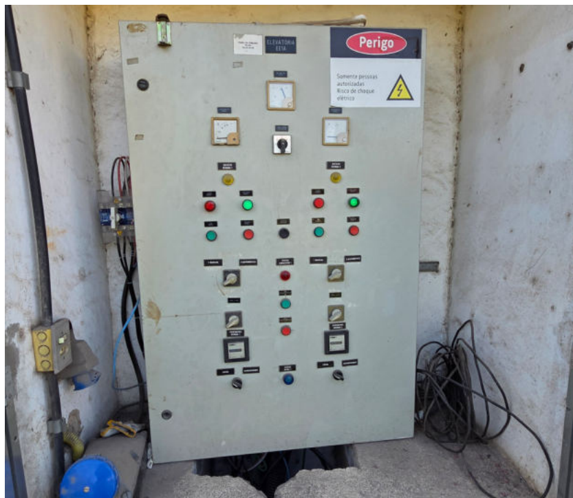
Foto 47 – Painel elétrico da EEEB
