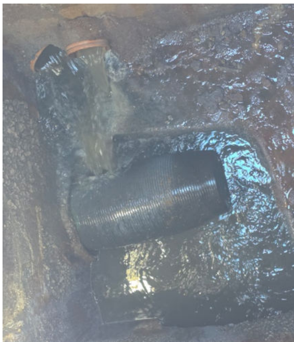
Foto 93 – Poço da chegada do esgoto sem gradeamento para remoção dos sólidos
