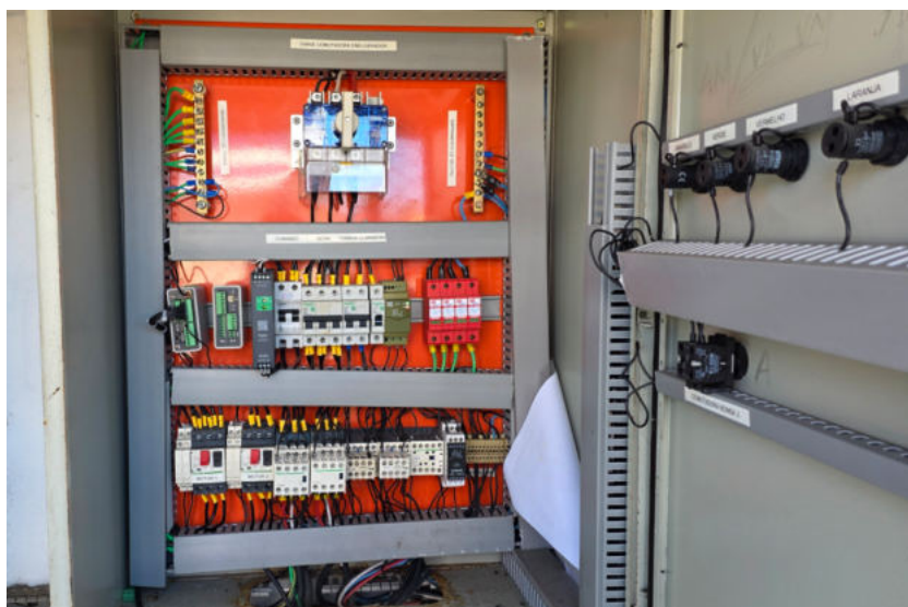
Foto 38 – Painele elétrico da EEEB
