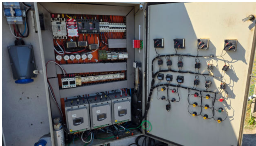
Foto 107 – Painelelétrico da EEEB
