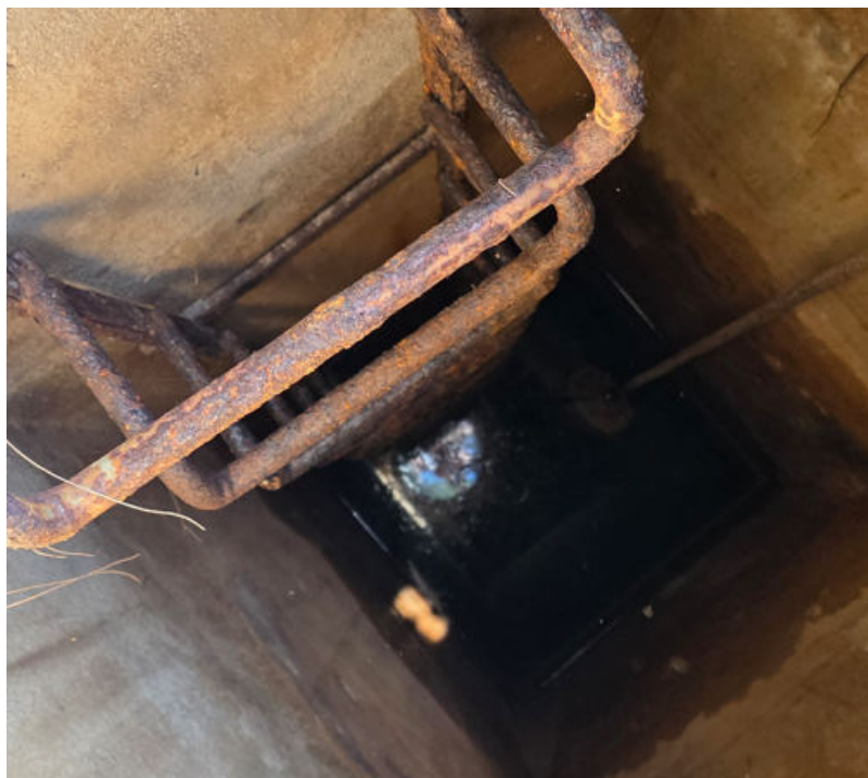
Foto 42 – Poço da chegada do esgoto sem gradeamento para remoção dos sólidos
