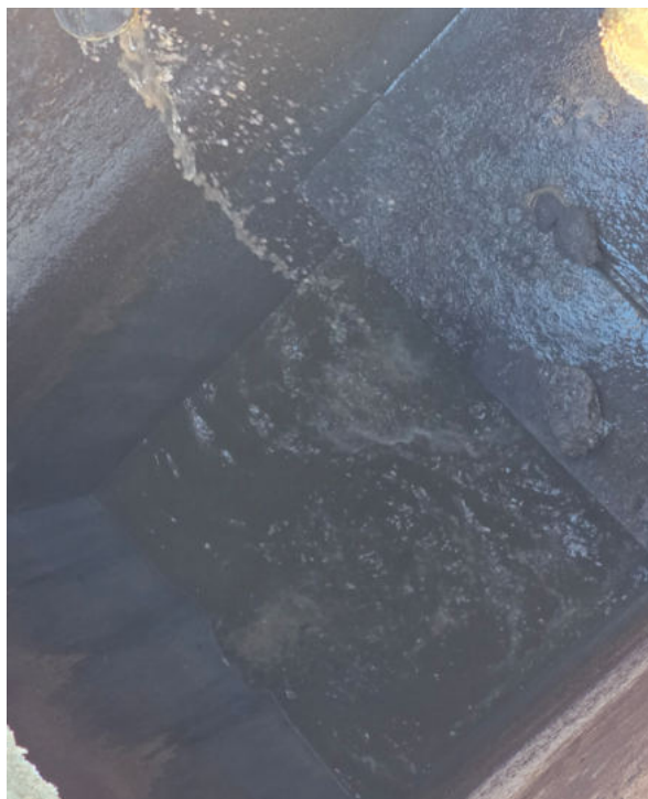
Foto 108 – Poço da chegada do esgoto sem gradeamento para remoção dos sólidos
