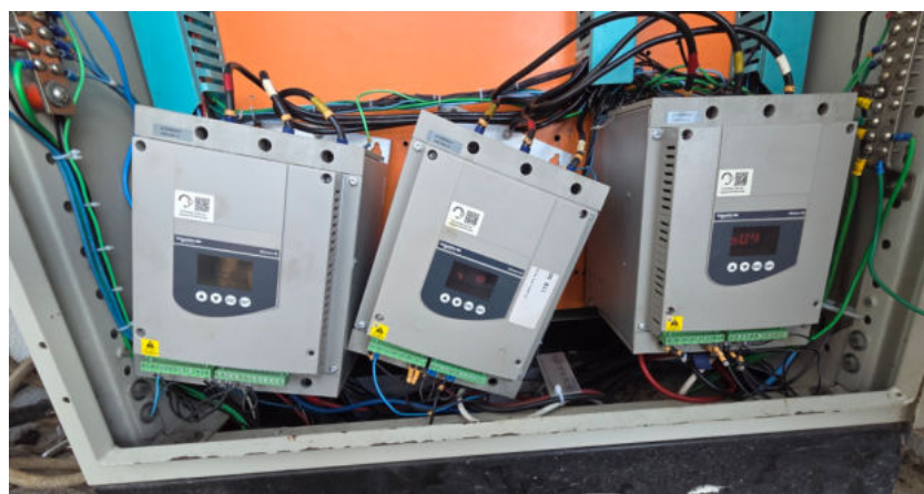
Foto 72 – Pannel elétrico da EEEB
