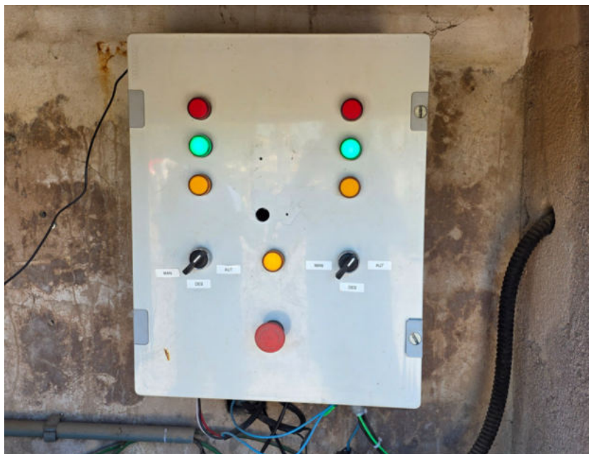
Foto 25 – Painel da EEEB no abrigo
