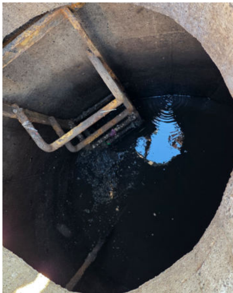
Foto 55 – Poço da chegada do esgoto sem gradeamento para remoção dos sólidos
