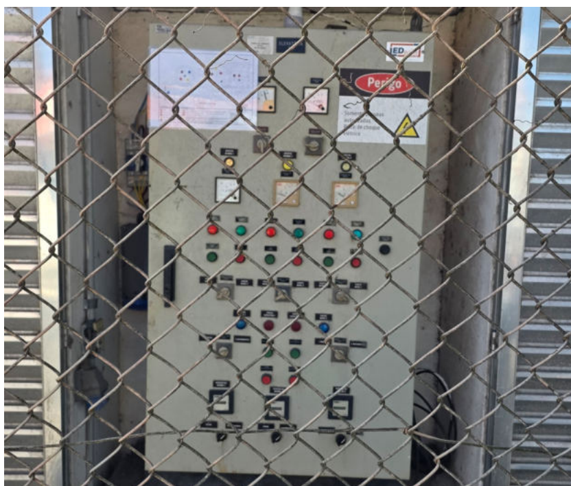
Foto 54 – Painel elétrico da EEEB
