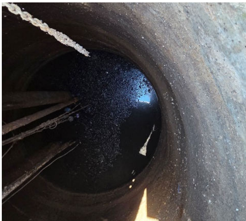
Foto 35 – Poço de sucção onde estão instalados os conjuntos motobombas submersos
