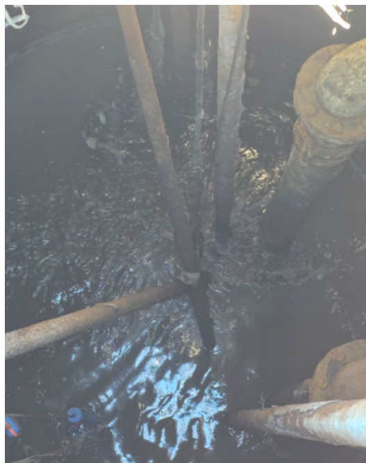
Foto 109 – Poço de sucção onde estão instalados os conjuntos motobombas submersos
