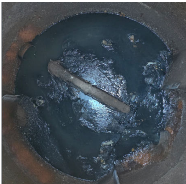
Foto 63 – Poço da chegada do esgoto sem gradeamento para remoção dos sólidos
