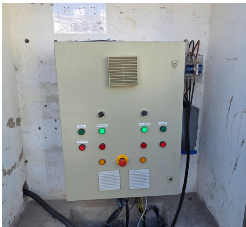
Foto 50 – Painel elétrico da EEEB
