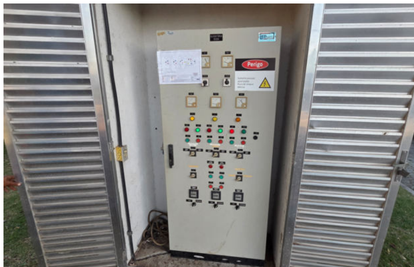
Foto 71 – Pannel elétrico da EEEB no abrigo
