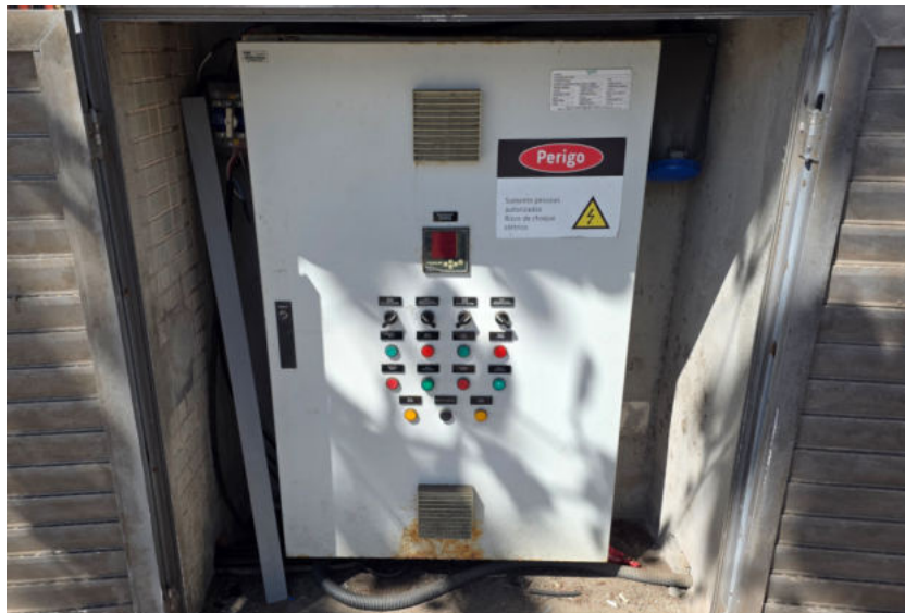
Foto 80 – Painelelétrico da EEEB no abrigo
