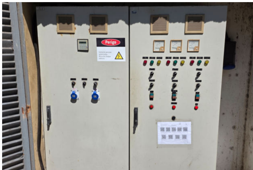
Foto 91 – Painel elétrico da EEEB no abrigo
