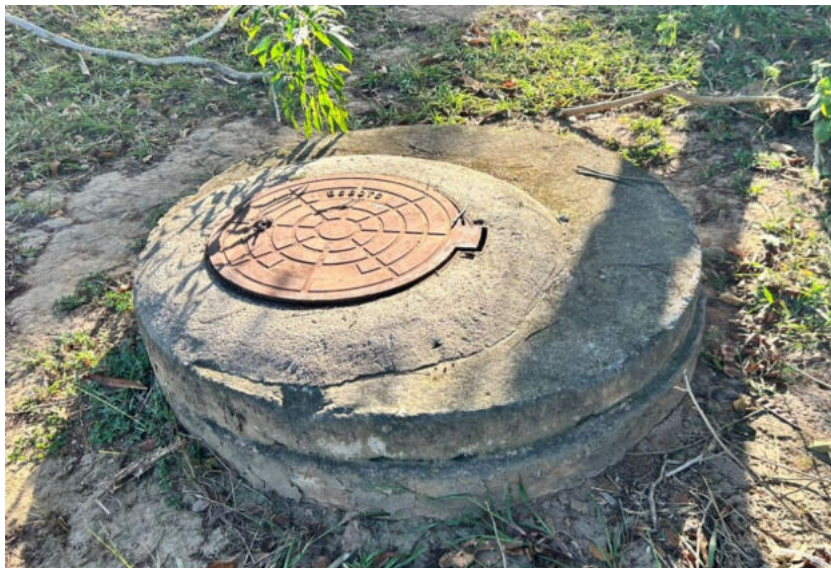
Foto 113 – Poço da chegada do esgoto sem gradeamento para remoção dos sólidos
