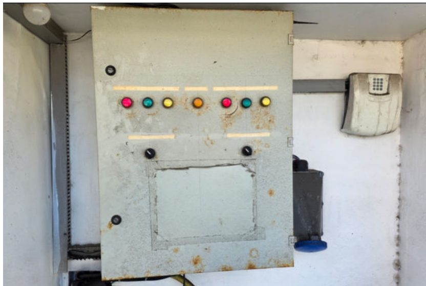
Foto 37 – Painele da EEEB no abrigo
