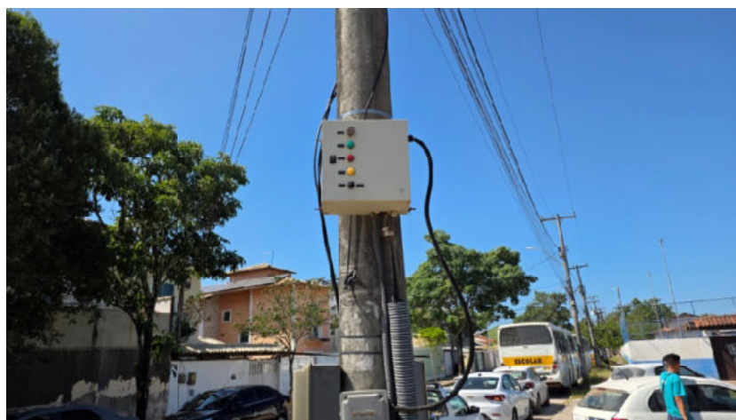
Foto 18 – Painel elétrico do poço de visita sem sinalização de risco
