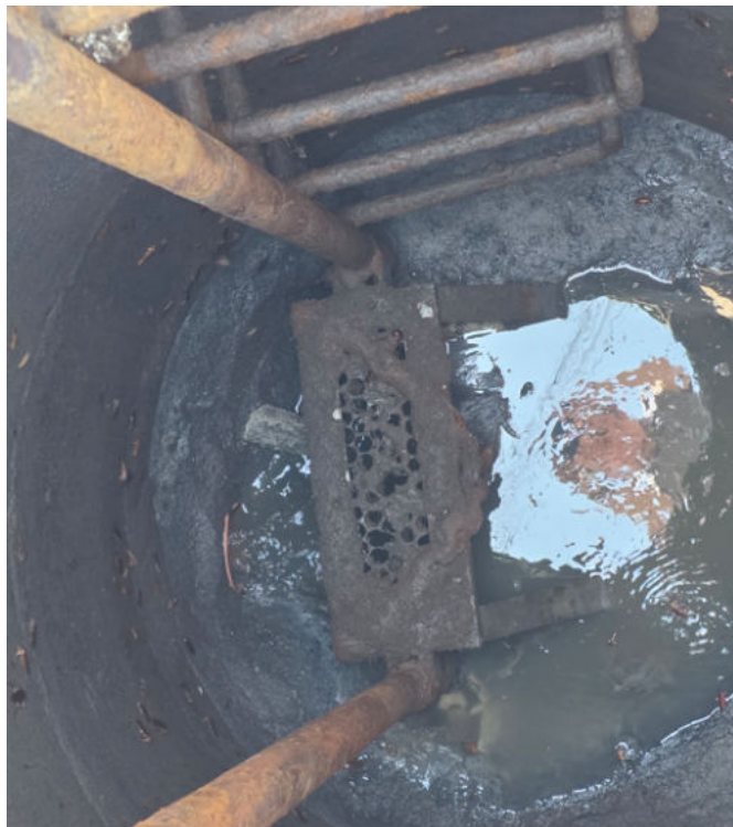
Foto 39 – Poço da chegada do esgoto com gradeamento para remoção dos sólidos
