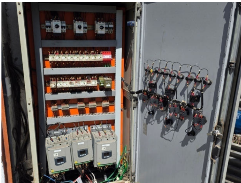
Foto 88 – Painel elétrico da EEEB
