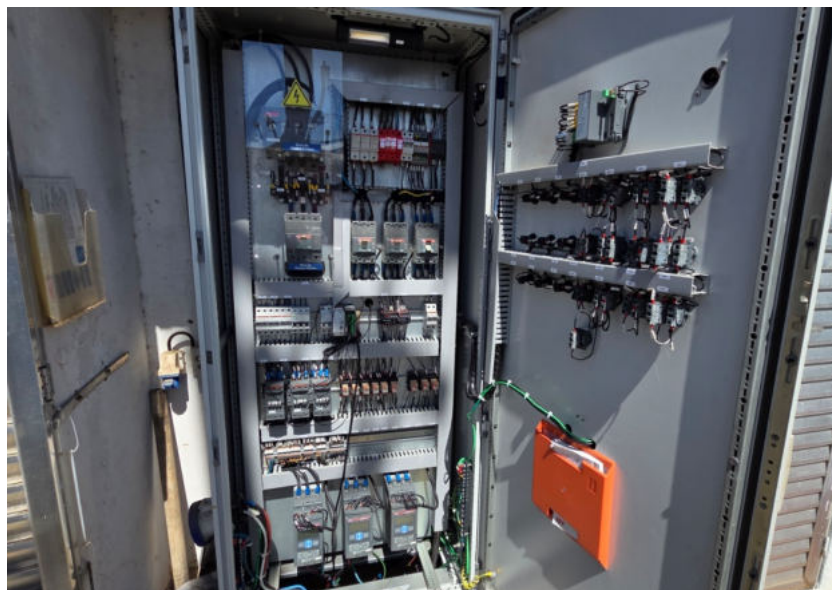
Foto 102 – Painel elétrico da EEEB
