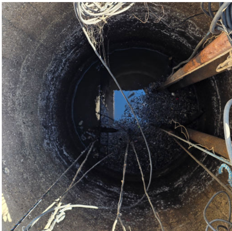
Foto 44 – Poço de sucção onde estão instalados os conjuntos motobombas submersos
