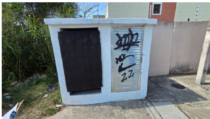
Foto 22 – Falta de identificação da EEEB
