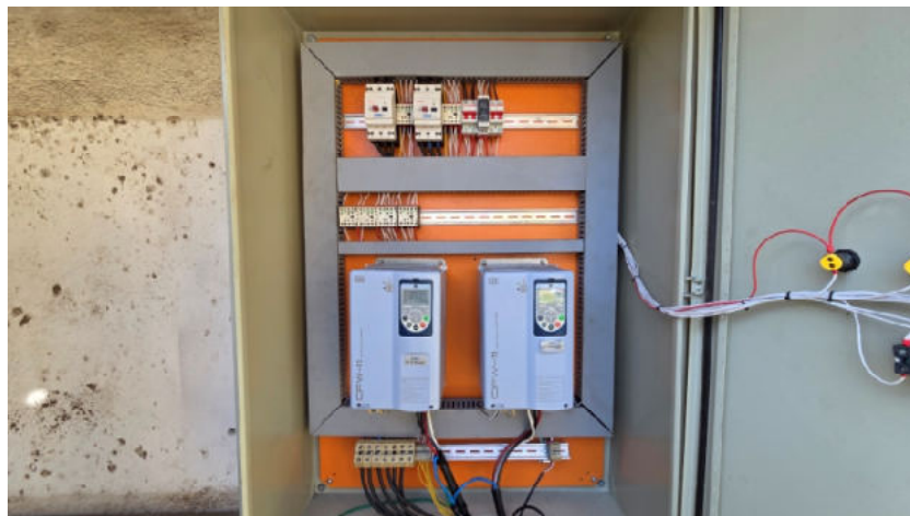
Foto 21 – Painel elétrico da EEEB
