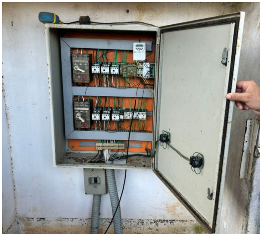
Foto 112 – Pannel elétrico da EEEB
