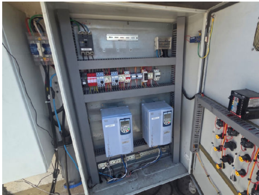
Foto 3 – Painel elétrico da EEEB
