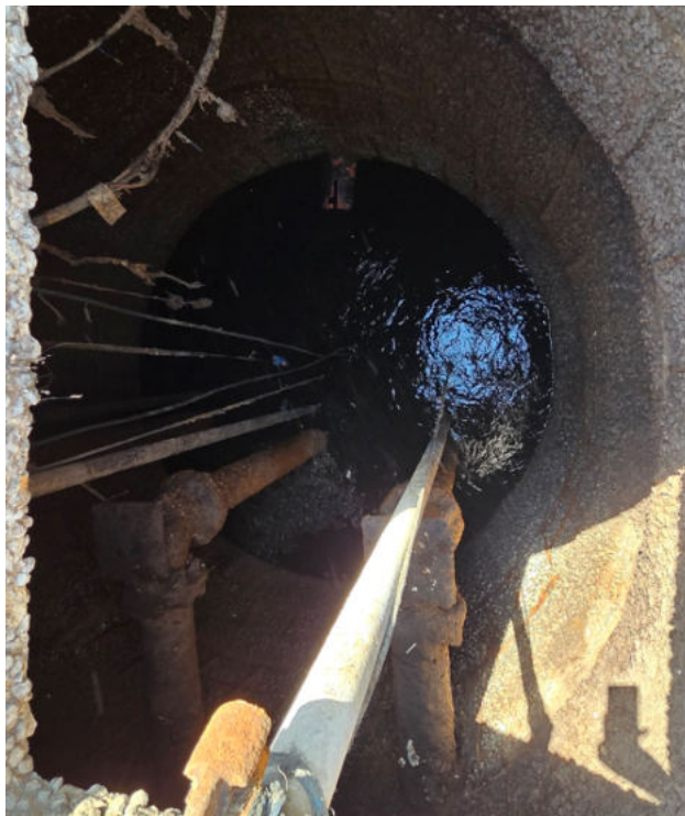
Foto 23— Poço de sucção onde estão instalados os conjuntos motobombas submersos
