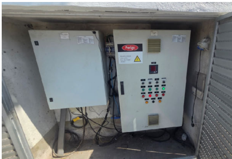
Foto 2 – Painel da EEEB no abrigo
