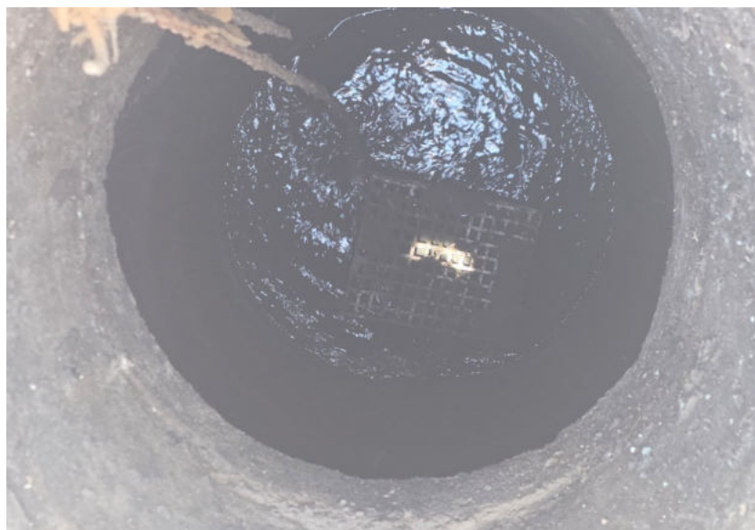
Foto 4 – Poço da chegada do esgoto com gradeamento para remoção dos sólidos
