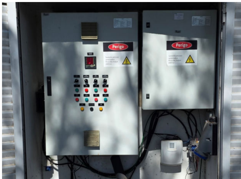
Foto 83 – Painel elétrico da EEEB no abrigo
