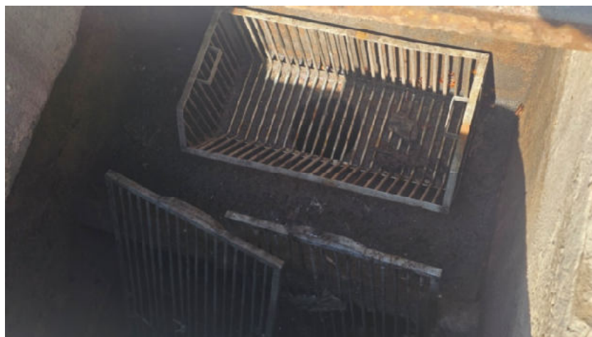
Foto 10 – Poço de chegada do esgoto com gradeamento para remoção dos sólidos
