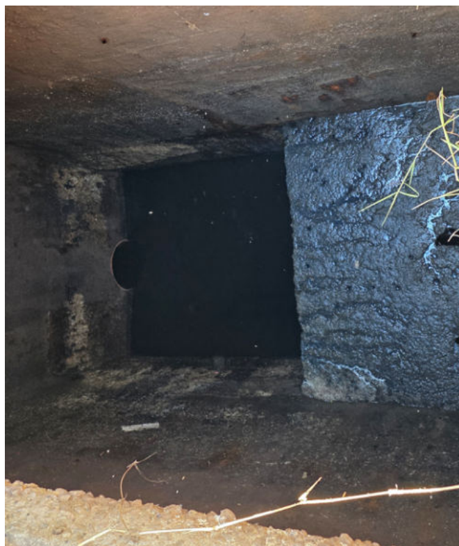
Foto 22 – Poço da chegada do esgoto sem gradeamento para remoção dos sólidos
