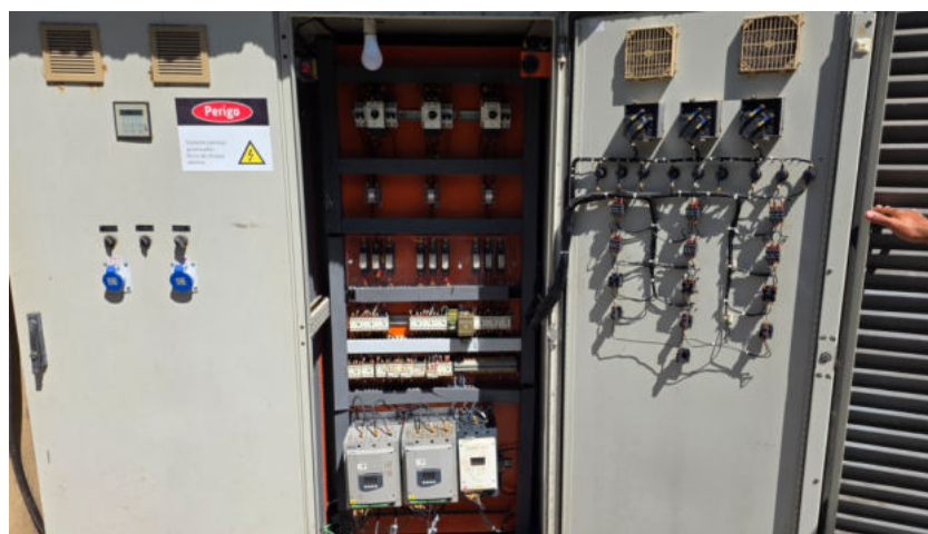
Foto 92 – Painel elétrico da EEEB
