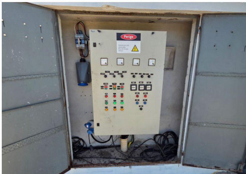
Foto 106 – Painel elétrico da EEEB
