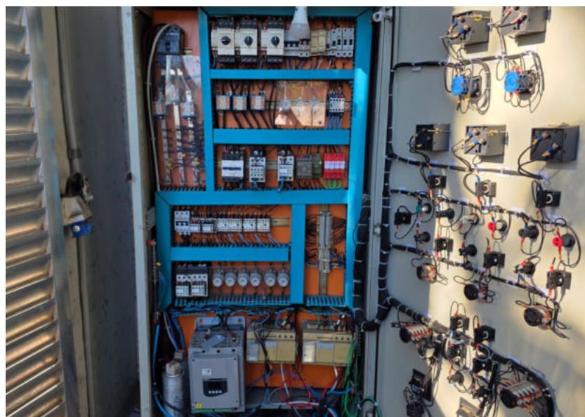
Foto 67 – Painelelétrico da EEEB
