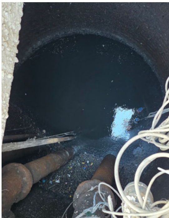
Foto 52 – Poço de sucção onde estão instalados os conjuntos motobombas submersos
