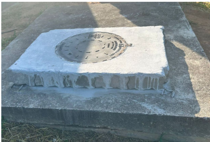
Foto 116 – Poço de sucção onde estão instalados o conjunto motobomba submerso
