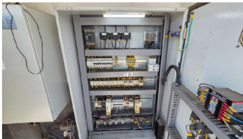
Foto 14 – Pannel da EEEB no abrigo
