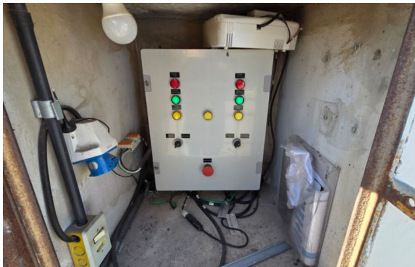
Foto 61 – Painel elétrico da EEEB
