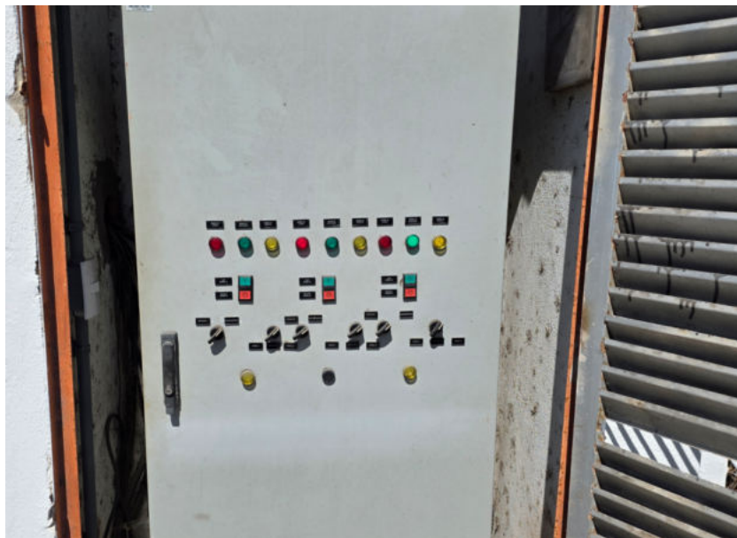
Foto 87 – Painel elétrico da EEEB no abrigo
