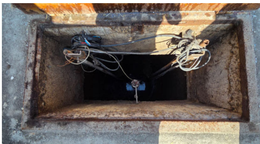
Foto 16 – Poço de sucção onde estão instalados os conjuntos motobombas submersos
