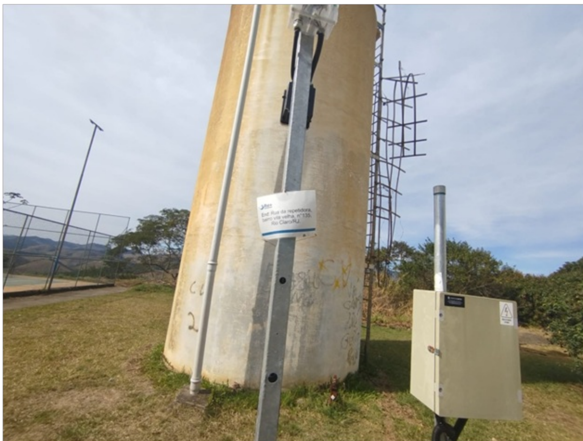
Foto 1 sinais de corrosão no reservatório.
