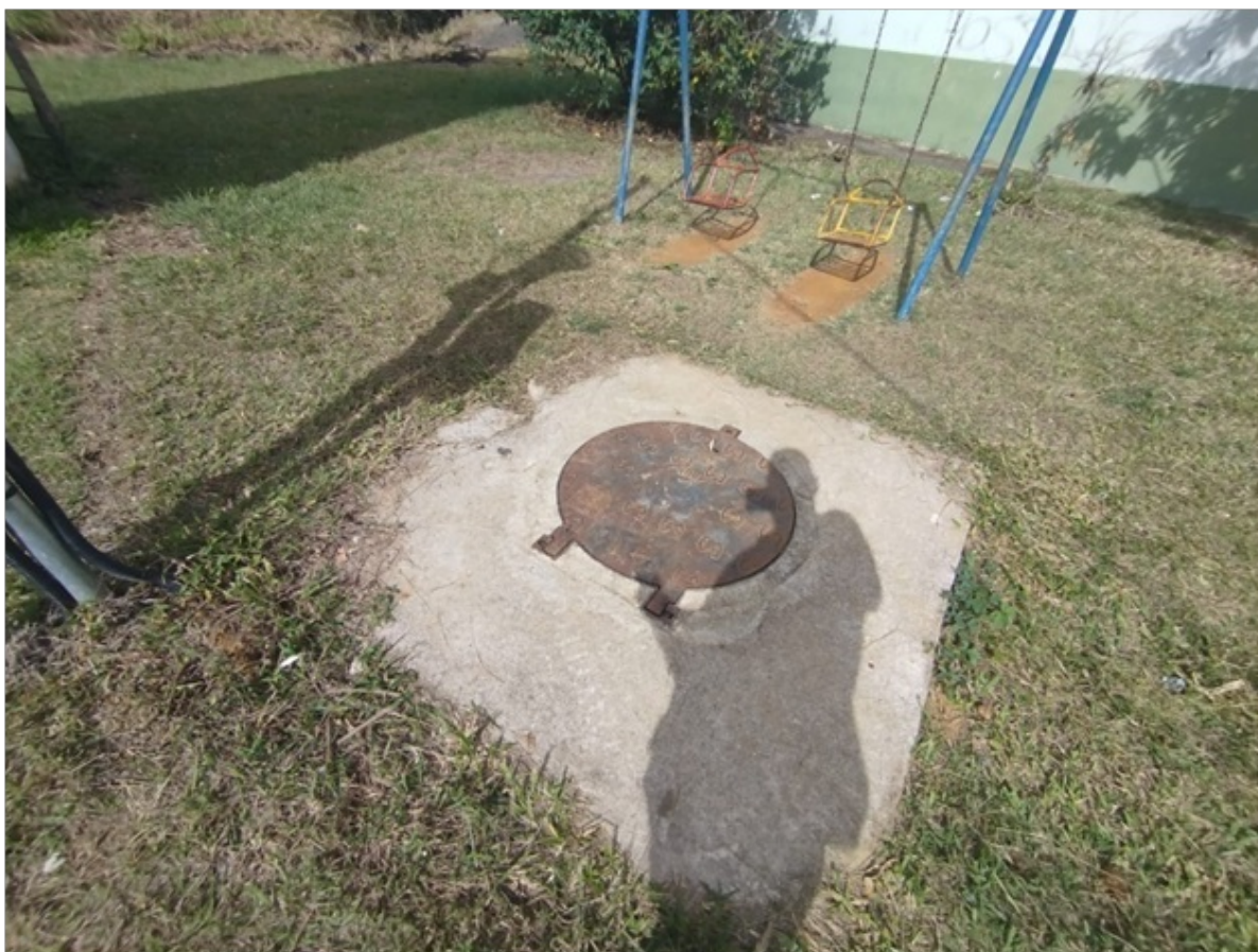
Foto 4 Local de instalação do macromedidor.
