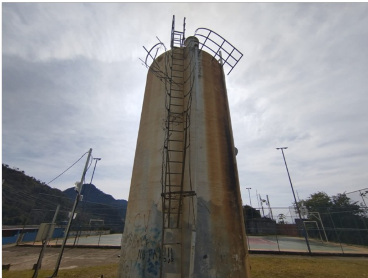
Foto 3 Escadas danificada e degradação do reservatório.
