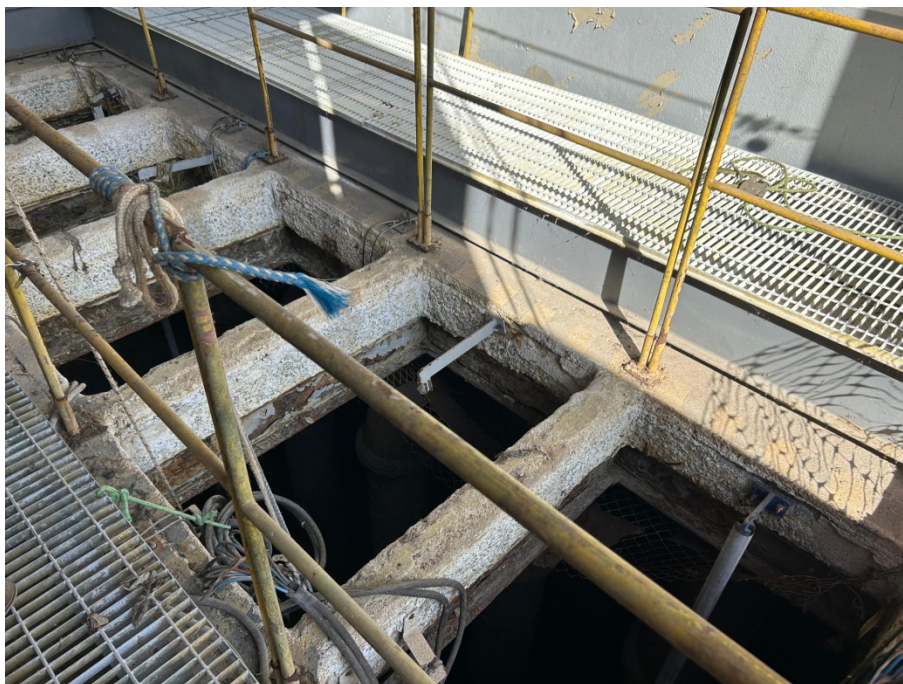
4 Poço de sucção
