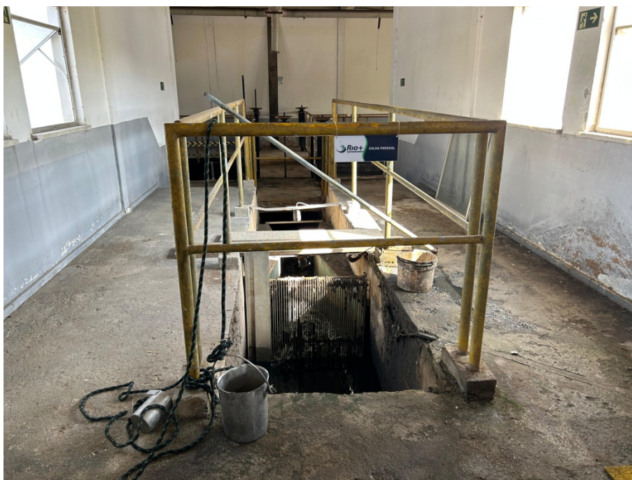
6 Calha Parshal + gradeamento fino
