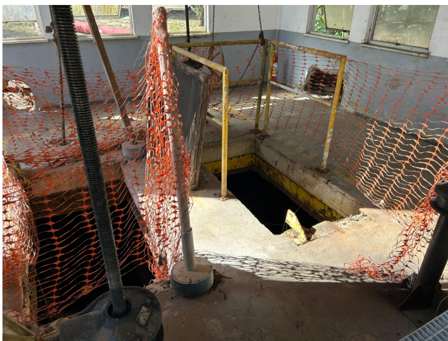
3 Elevatória de esgoto bruto da unidade
