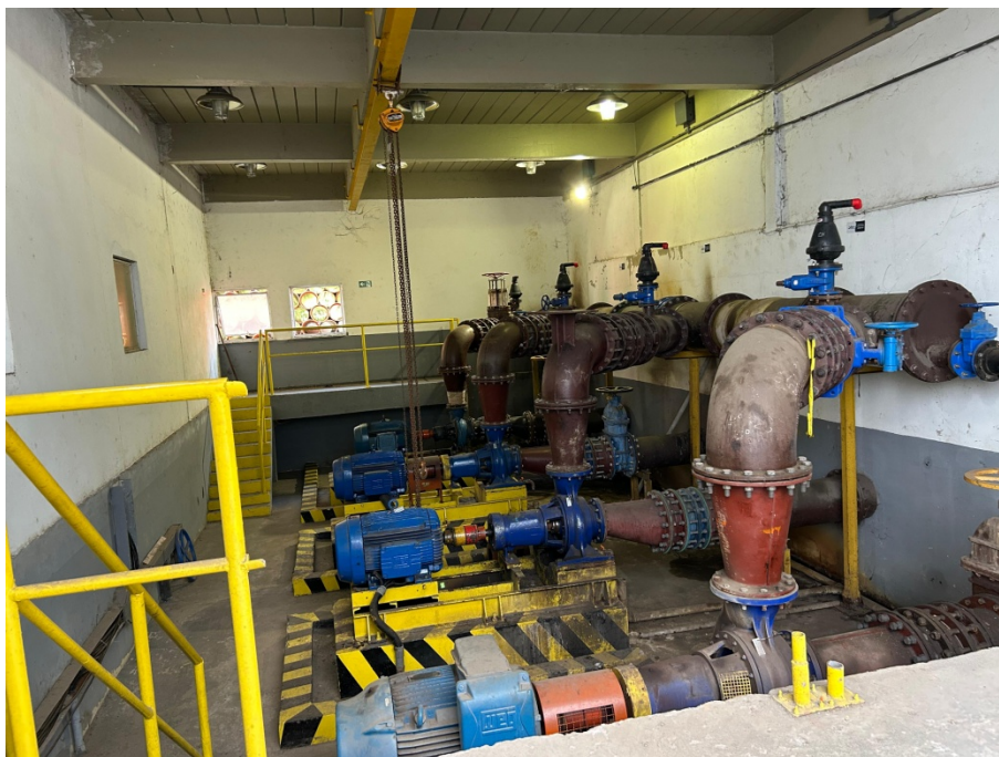
15 Elevatória de esgoto tratado
