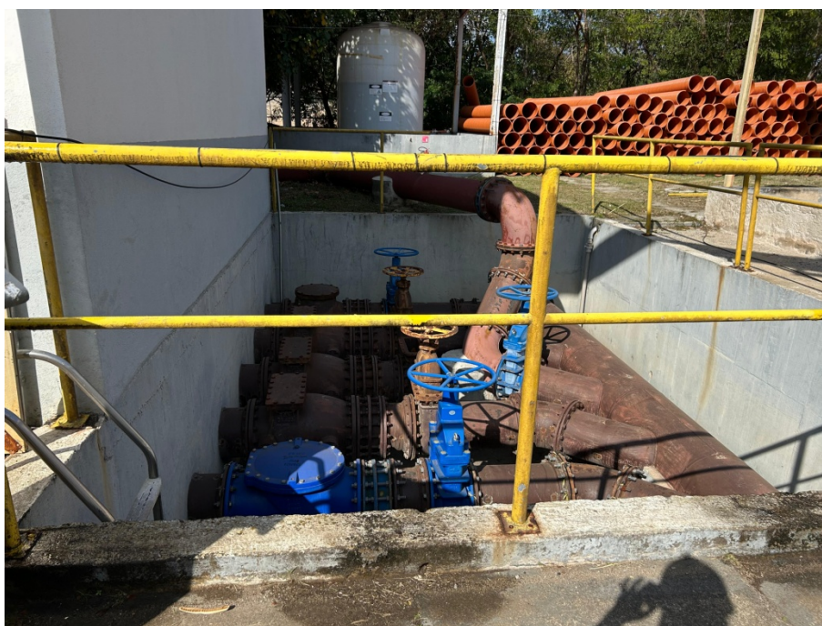
5 Barrilhete de recalque
