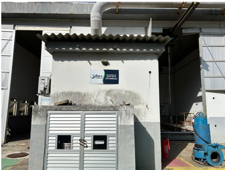
2 Elevatória de esgoto bruto da unidade
