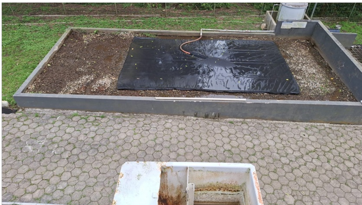
Foto 16 – O lodo é armazenado em bag e drenado na bacia de contenção
