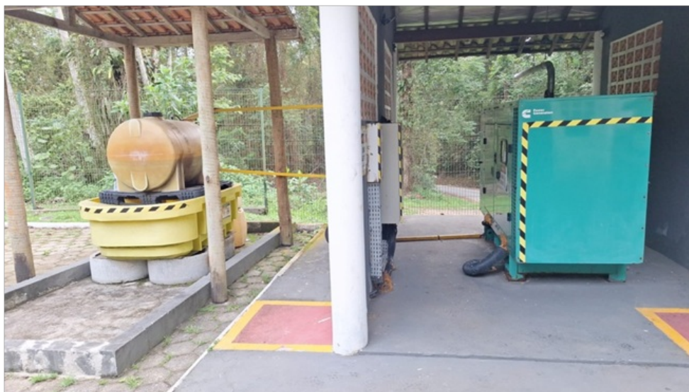
Foto 8 – Gerador para segurança operacional, com seu tanque de diesel sobre bacia de contenção
