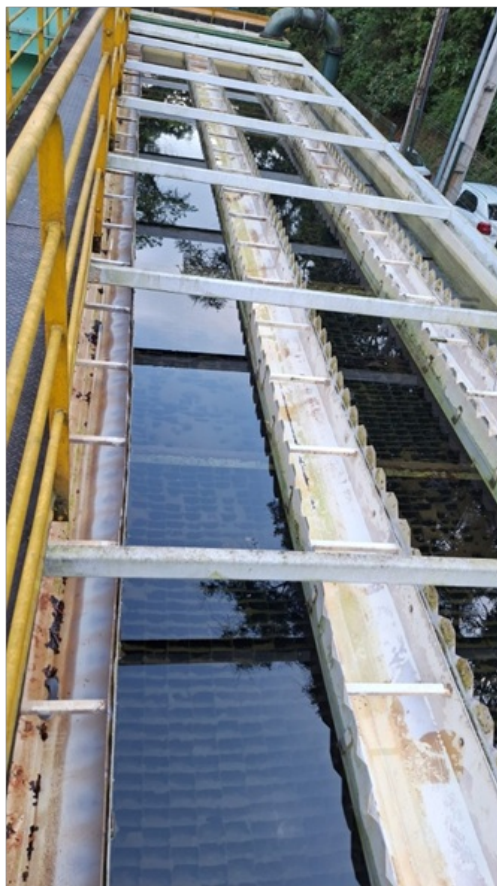
Foto 14 – Vista do decantador com calha de água decantada (sedimentada)
