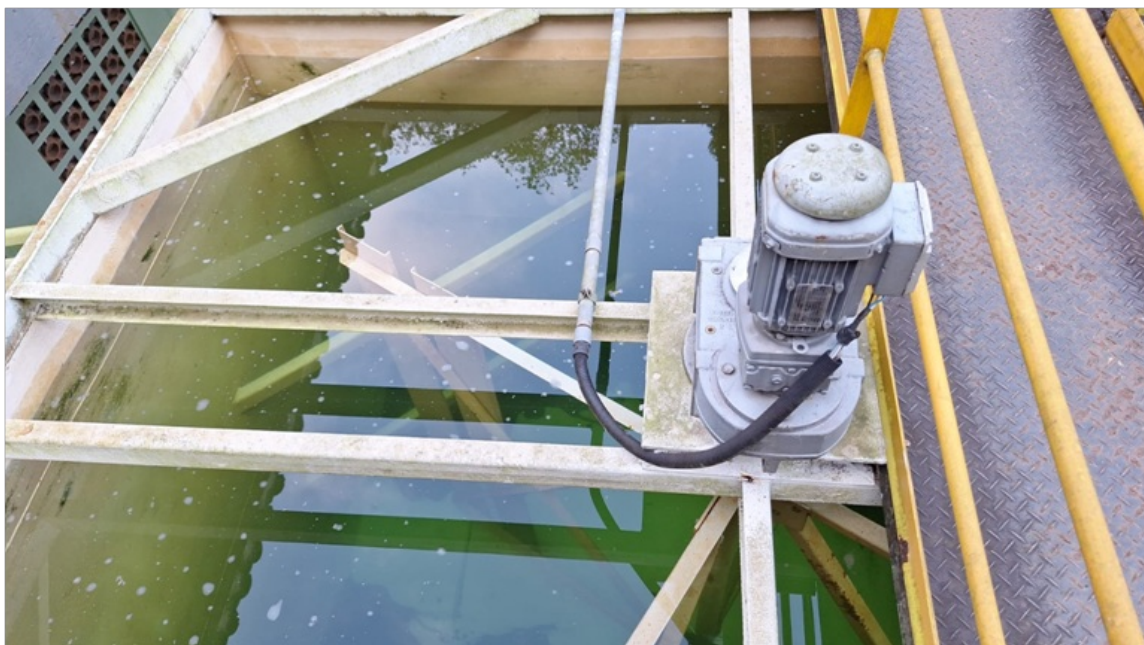
Foto 13 – Vista do floculador
