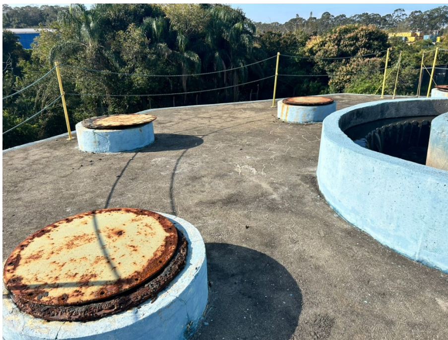
Foto 08- Tampas dos poços de inspeção com elevada oxidação
