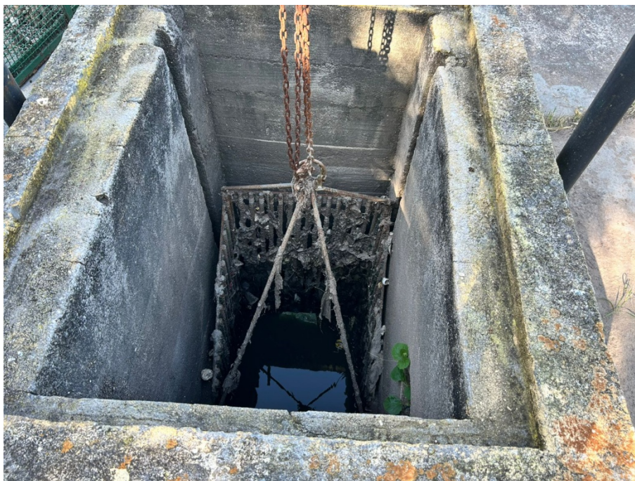
Foto 02 - Cesto coletor de detritos e caixa de chegada
