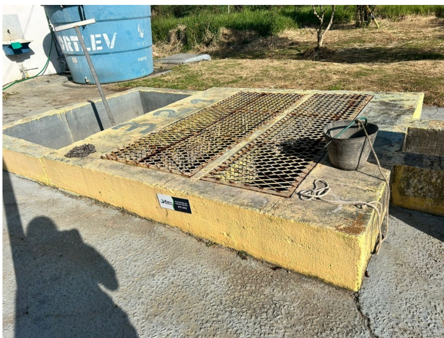
Foto 05 - Elevatória de esgoto bruto
