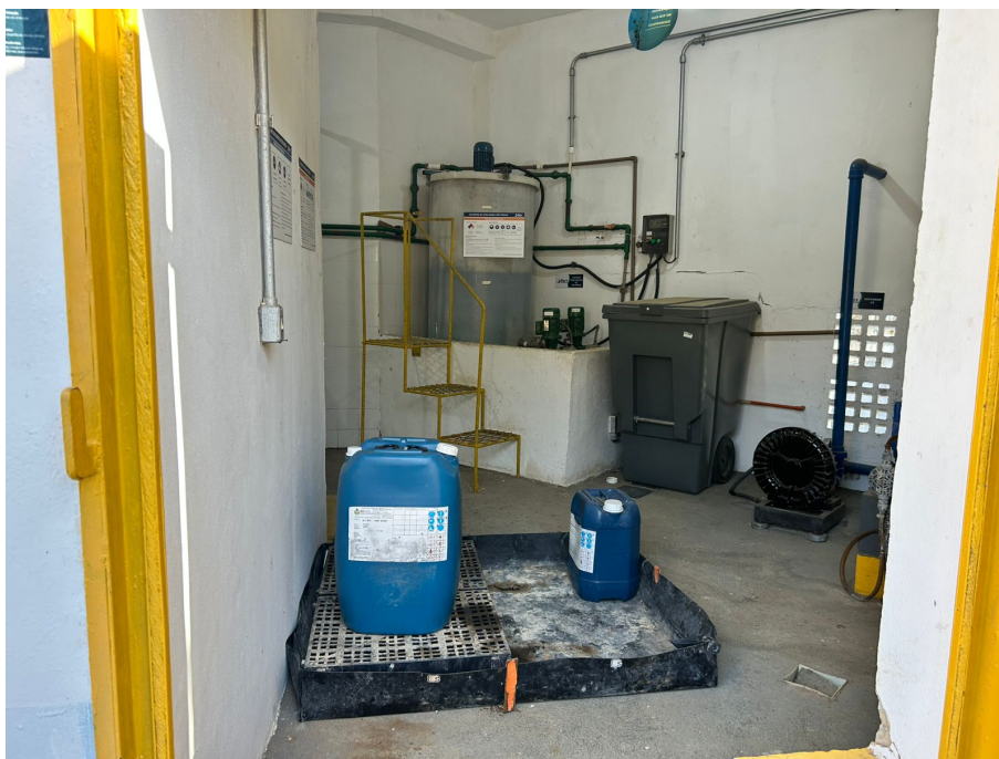
Foto 14 - Tanque de polímero e bombas injetoras
