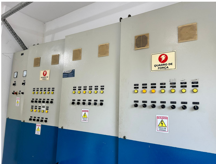
Foto 19 - Quadro de automação e elétrica
