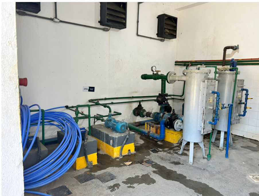
Foto 15 - Casa de bombas + Flotflux
