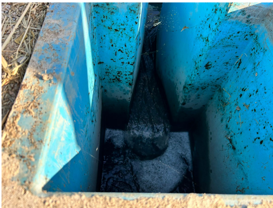
Foto 20 - Calha Parshal de saída do efluente tratado
