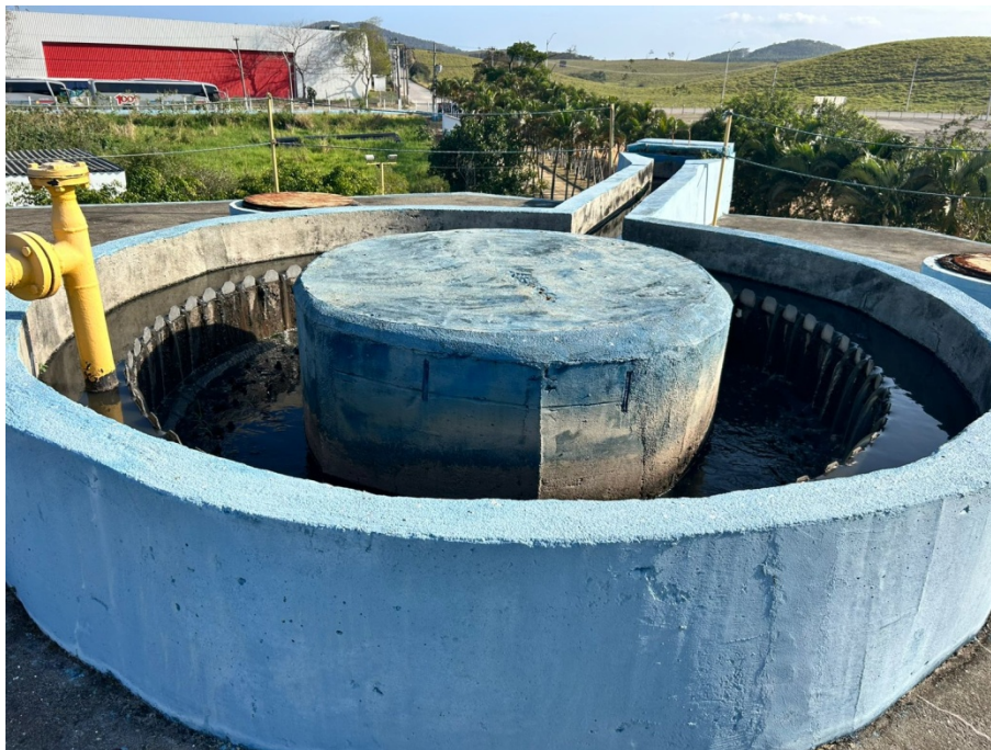
Foto 07 - Chegada do efluente ao reator
