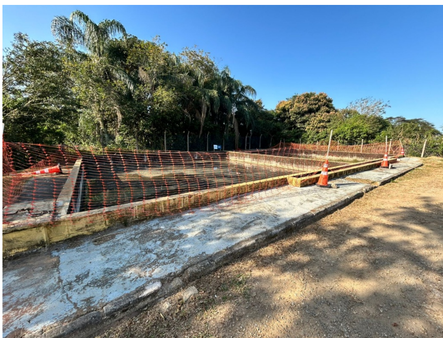
Foto 16 - Leitos de secagem
