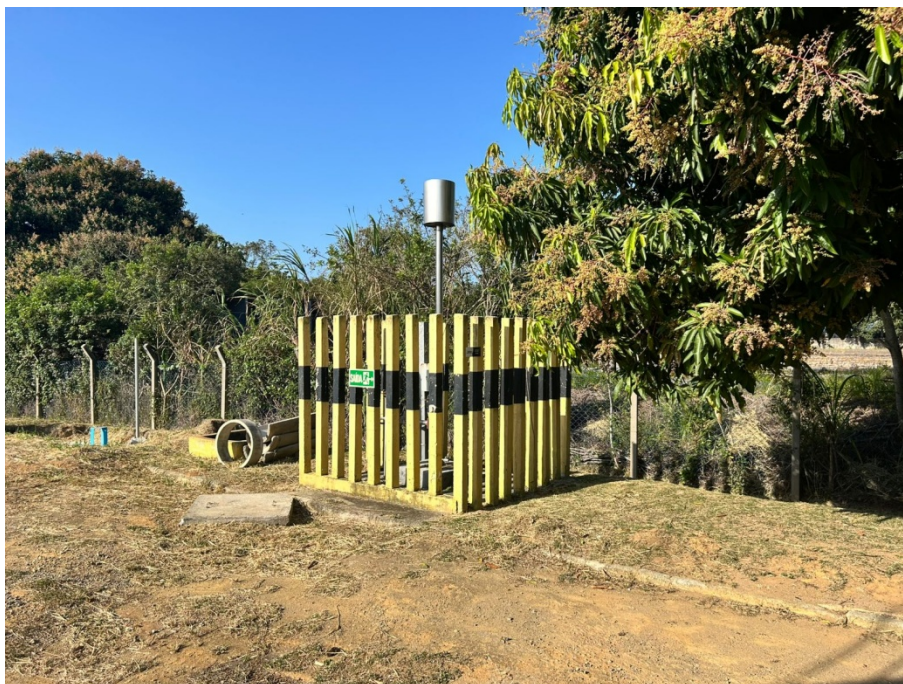
Foto 09 - Queimador de gás sem funcionamento desde o início da operação
