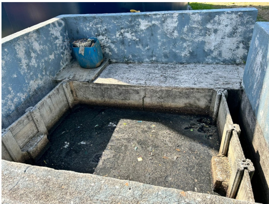
Foto 04 - Caixa de gordura
