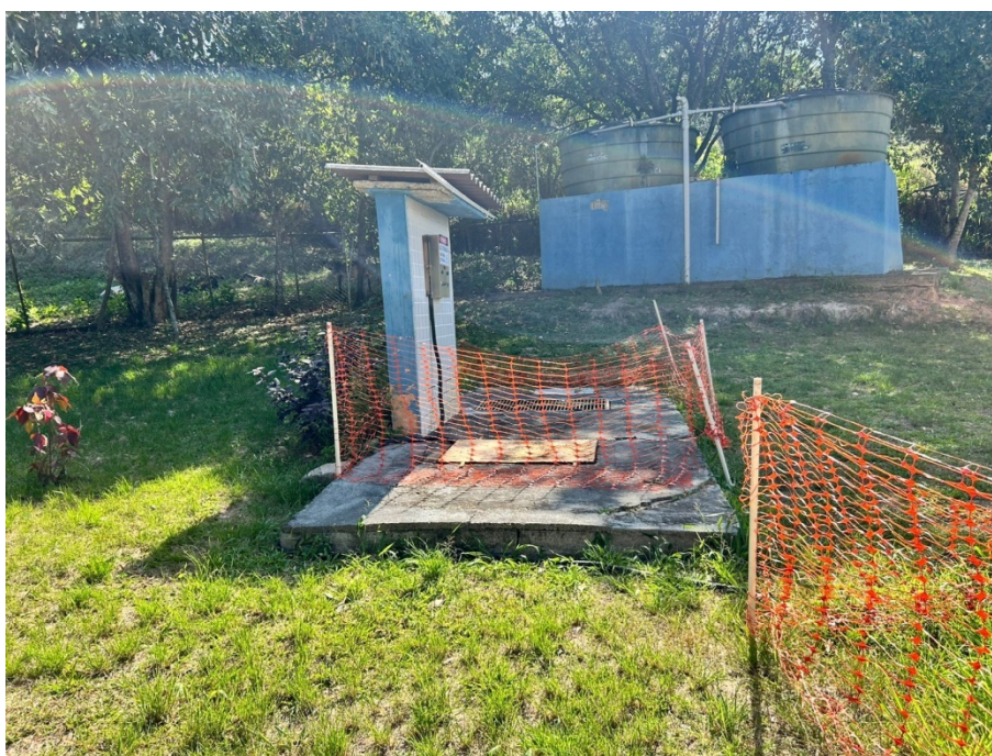
Foto 05 - Elevatória de esgoto bruto
