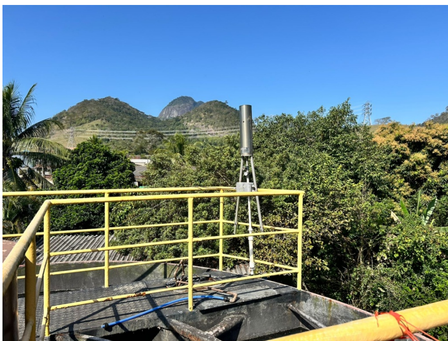
Foto 11 - Queimador de gás da unidade fora de operação por conta da baixa emissão de gás
