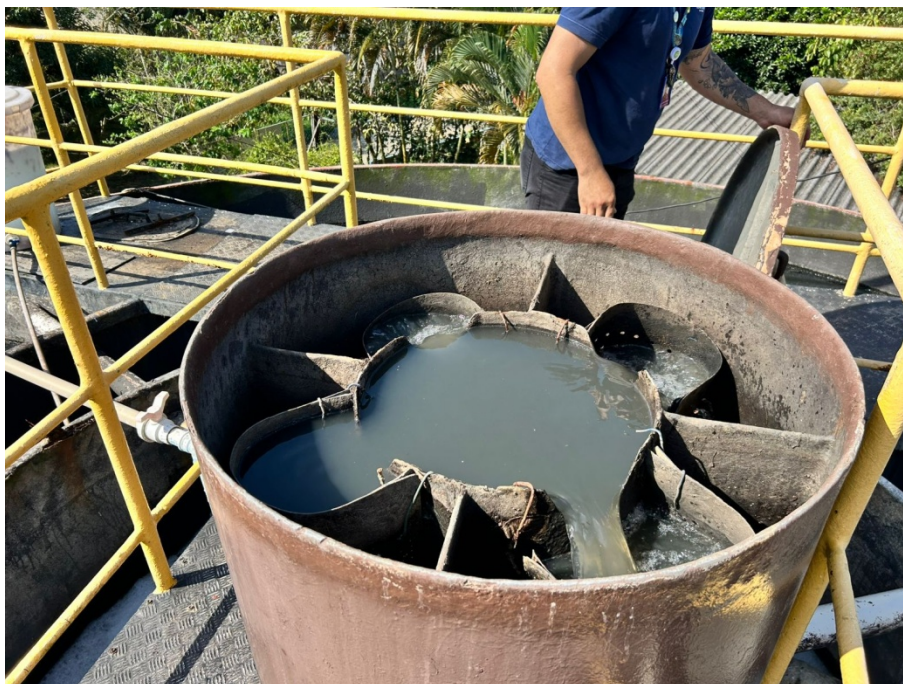
Foto 08 - Entrada do esgoto no reator UASB
