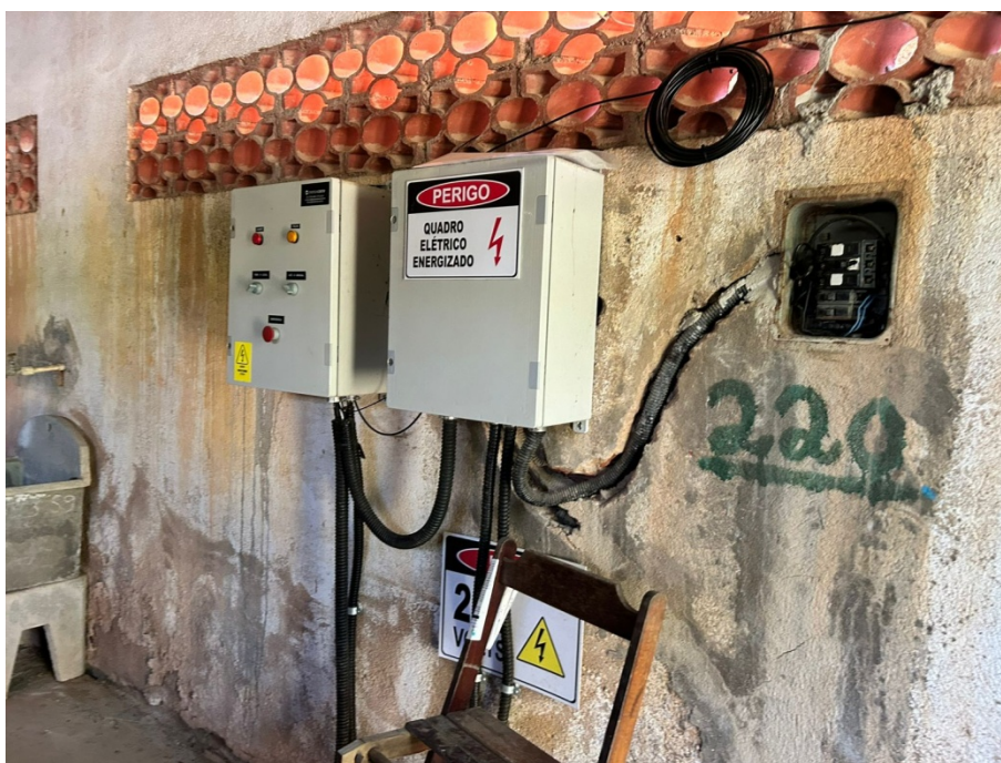
7 Quadro elétrico da unidade
