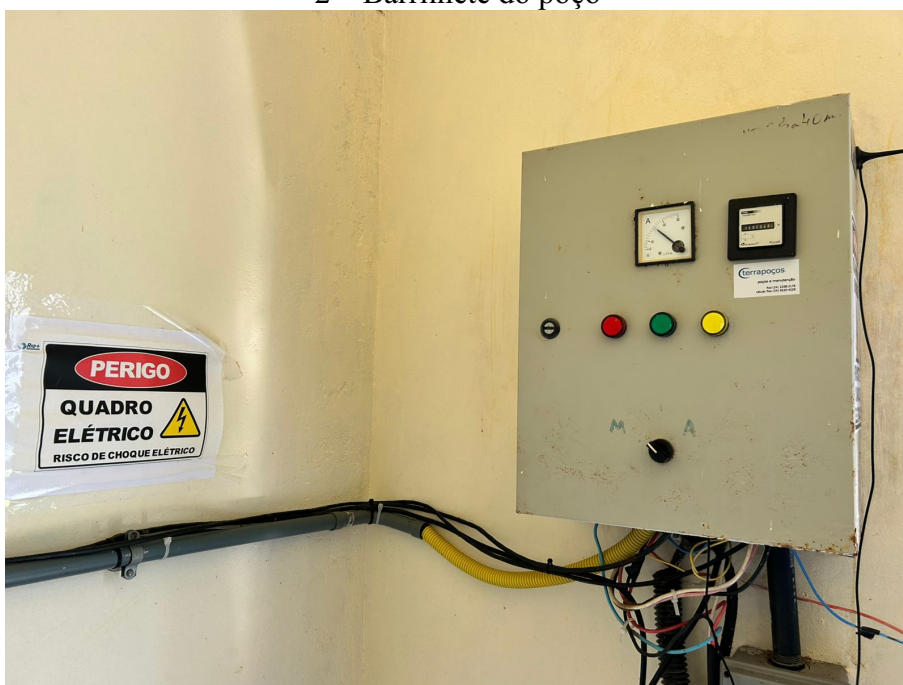
3 Quadro elétrico da unidade
