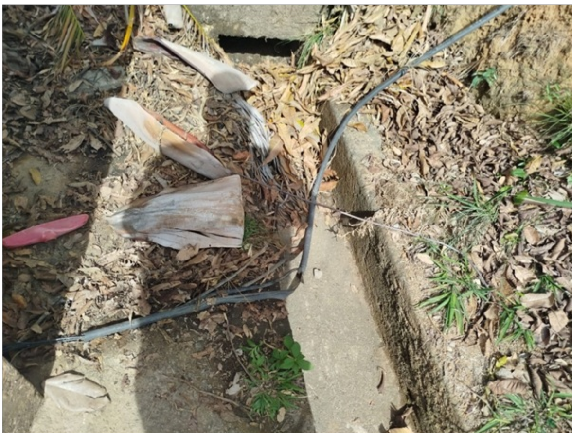
Foto 9 Cabos de ligação elétrica aparente
