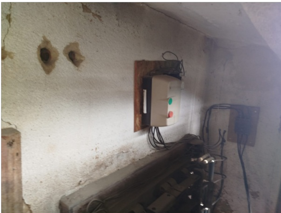
Foto 8 Chave de partida instalada na cabine elétrica
