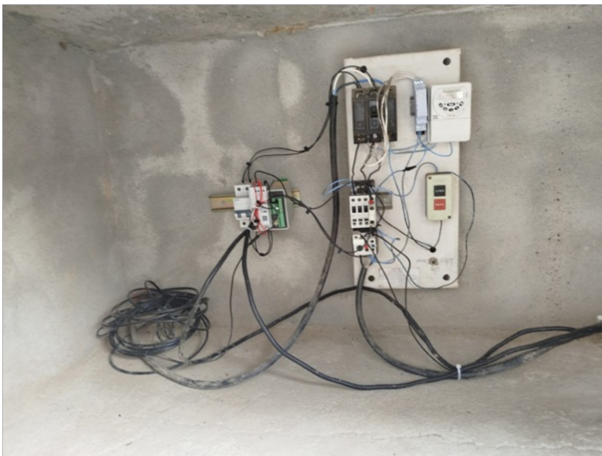
Foto 2 Paineleltrico - O painel eltrico apresenta desorganizaço e fora dos padrões e normas estabelecidas
