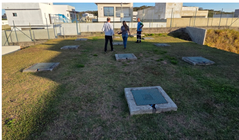
Foto 6 – Tampas de acesso ao reservatório
