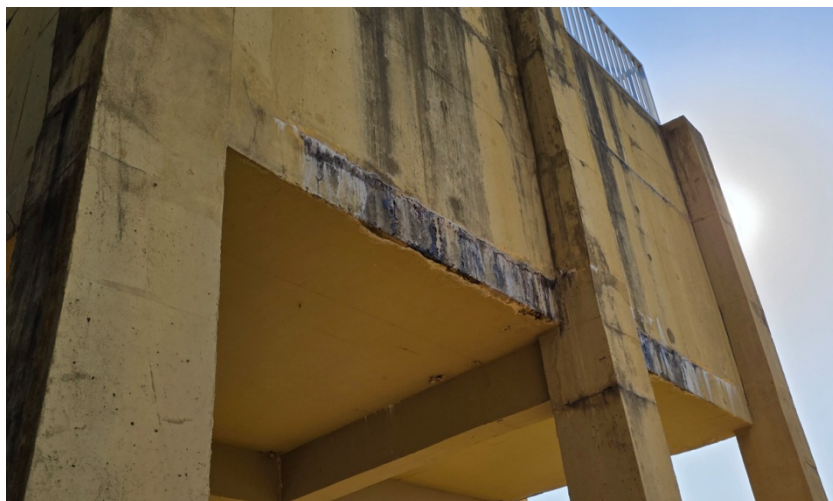
Foto 11 – Ferragens aparentes na base do reservatório
