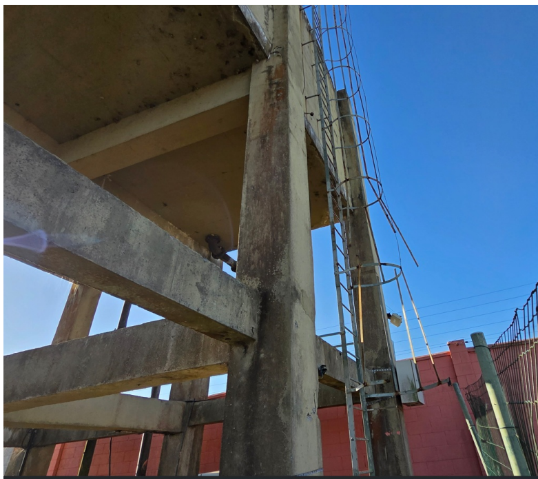
Foto 16 – Escada de acesso ao reservatório fora das condições seguras
