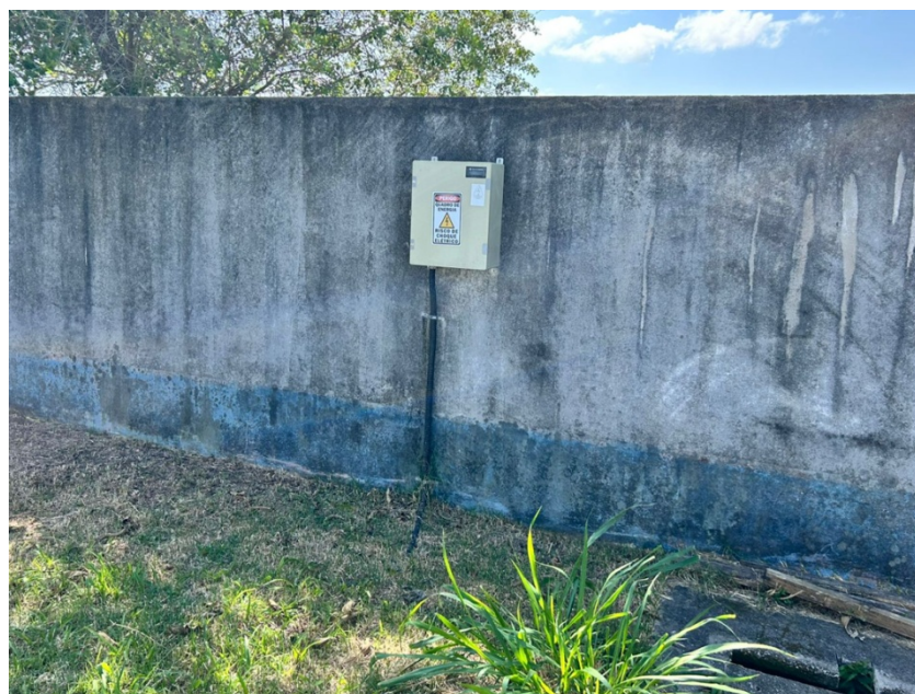
Foto 21 – Pannel com sinalização de risco
