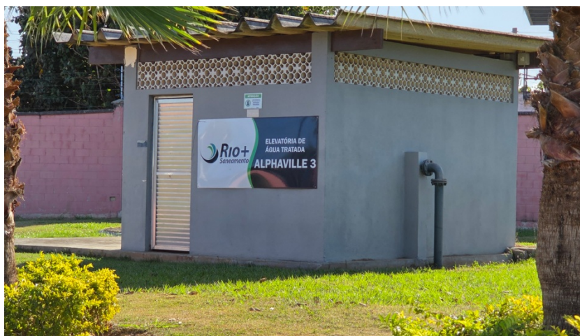
Foto 8 – Elevatória do reservatório
