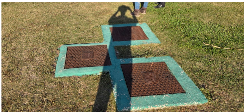
Foto 2 – Tampas de acesso ao reservatório
