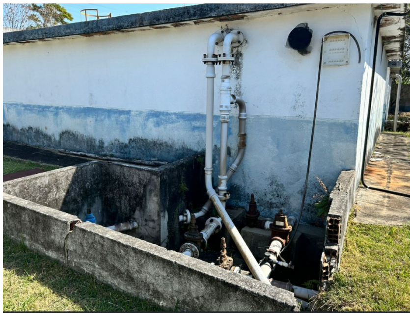
Foto 20 – Tubulações e duto com proteção
