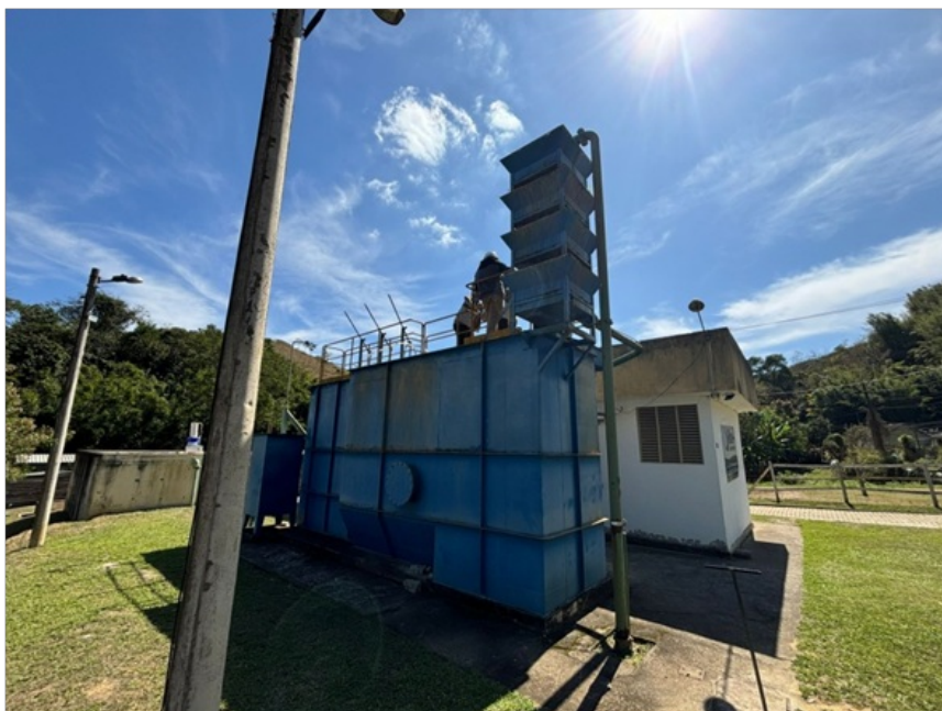
Figura 5 – ETA compacta Fazenda da Grama
