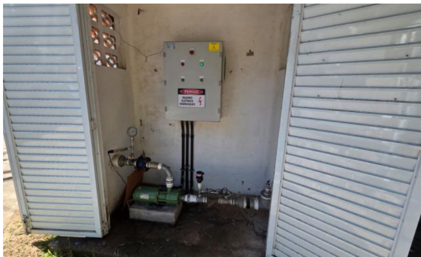
Foto 6 – Interior do abrigo da EEAT
