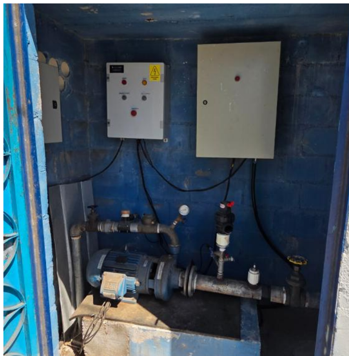
Foto 2 – Paineis da EEAT no abrigo
