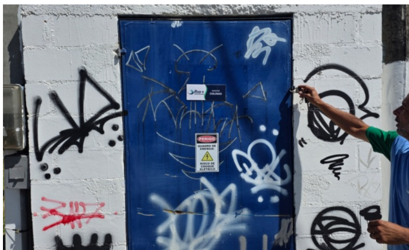
Foto 1 – Identificação da EEAT
