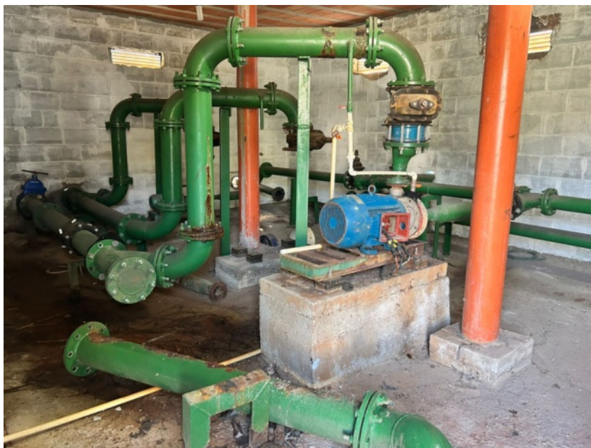
Foto 13 – Conjunto motobomba da EEAT
