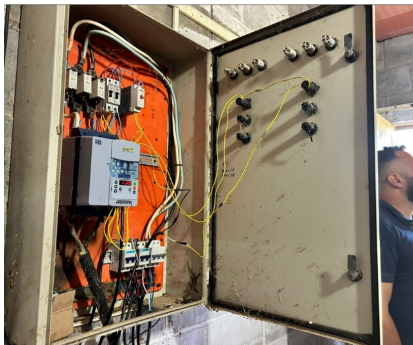
Foto 12 – Painel elétrico da EEAT
