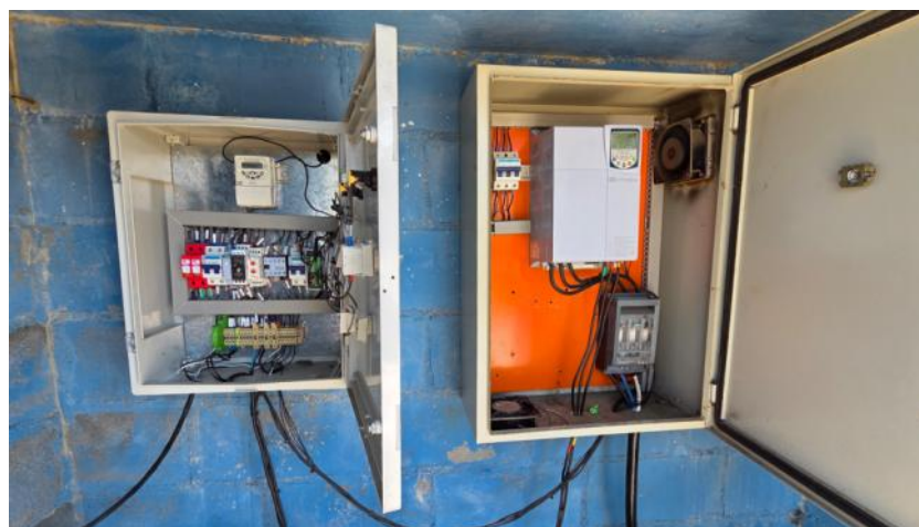
Foto 3 – Paineis elétricos da EEAT
