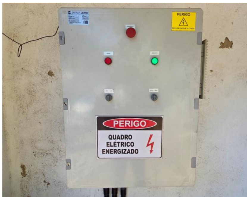
Foto 7 – Painelelétrico da EEAT
