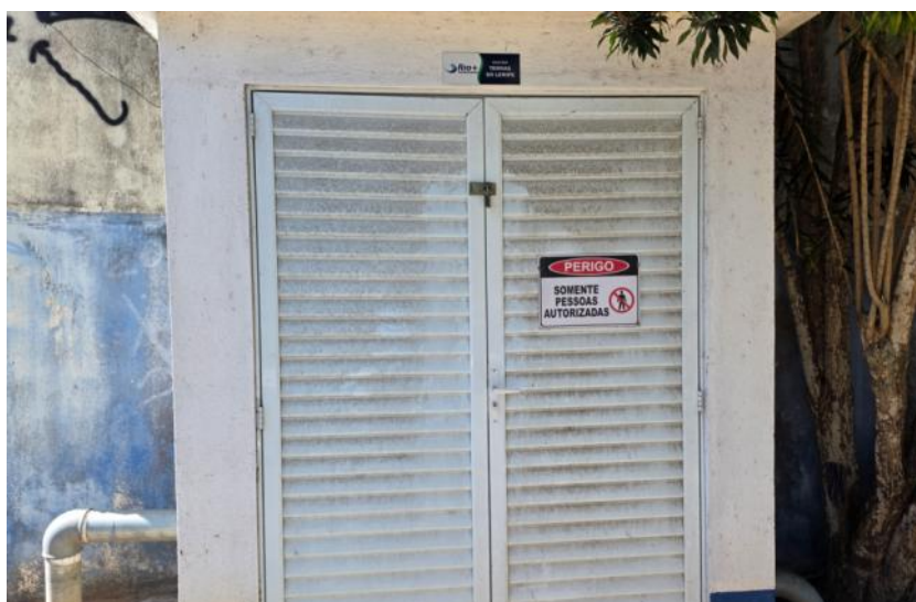
Foto 5 – Identificação da EEAT
