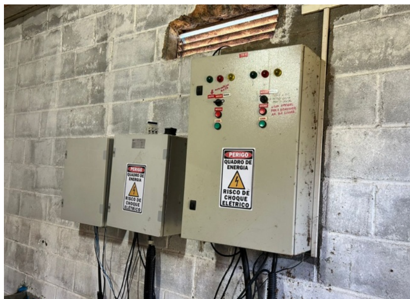
Foto 11 – Interior do abrigo da EEAT
