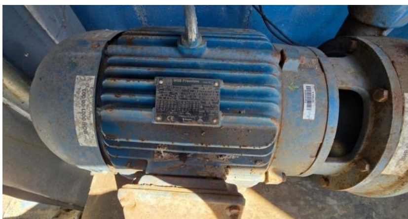
Foto 4 – Conjunto motorbomba da EEAT
