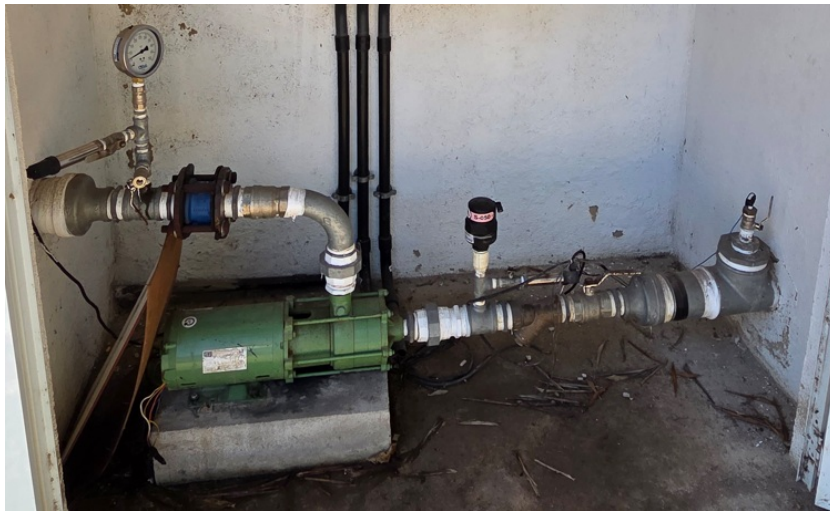
Foto 9 – Conjunto motorbomba da EEAT
