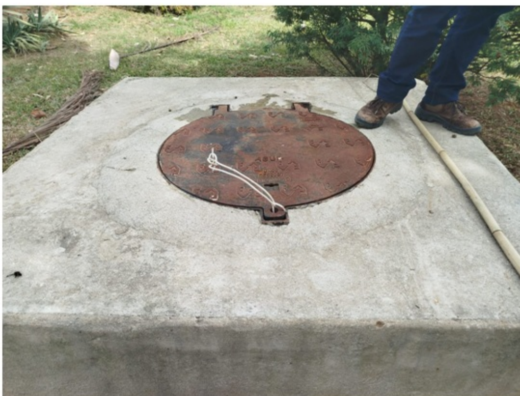
Foto 2 Local de instalação do Macromedidor
