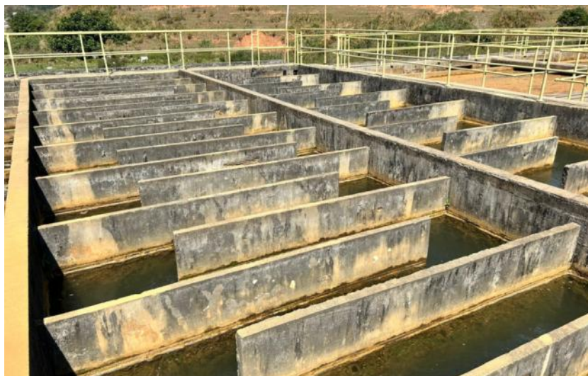
Foto 18 – Floculadores precisando de limpeza
