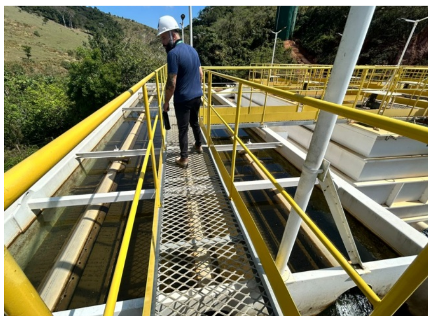
Foto 20 - Tanques de decantação da ETA Metálica
