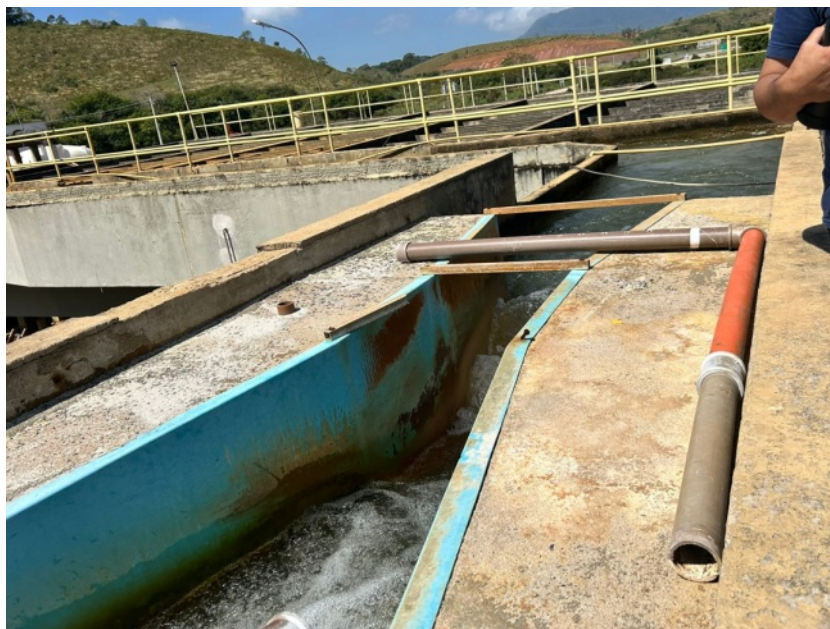
Foto 17 – Calha Parshall onde se inicia a dosagem do coagulante
