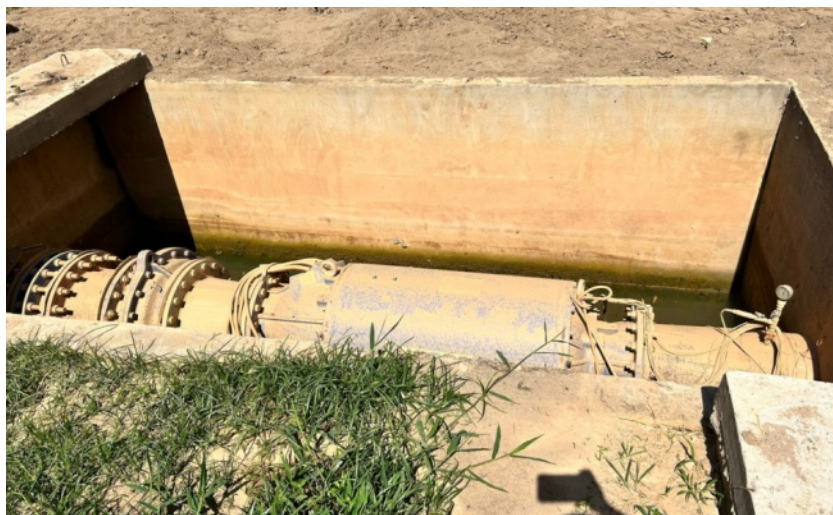
Foto 14 – Booster instalado na saída da captação
