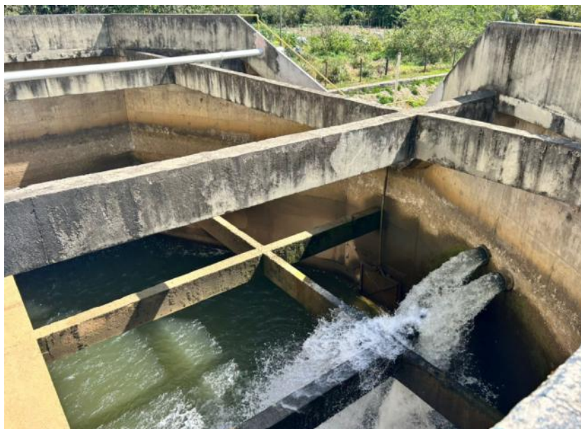
Foto 6 – Chegada da água bruta
