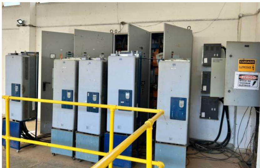
Foto 29 - Painel de automação dos conjuntos motobombas
