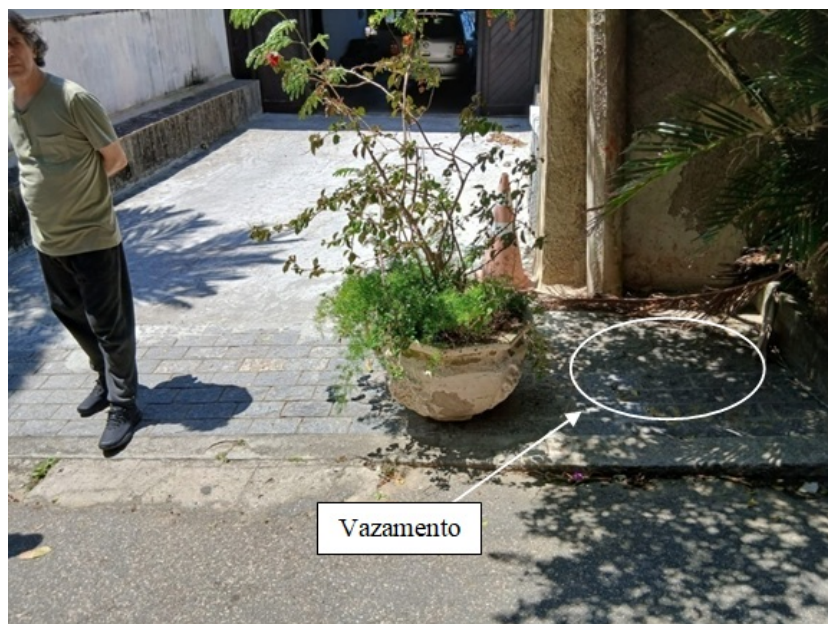
Foto 4 – Canteiro direito, passeio e local do vazamento
