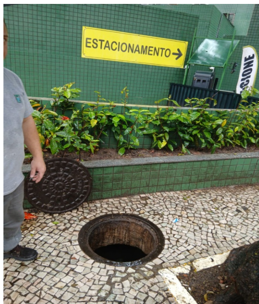
Foto 3 – Segundo PV da Rede de Esgotamento Sanitário
