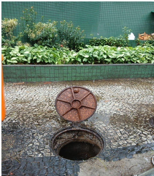
Foto 7 – Último PV da Rede de Esgotamento Sanitário – PV de ligação com a Galeria de Águas Pluviais
