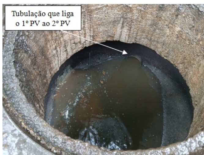
Foto 4 – Segundo PV - Efluente sendo encaminhado
