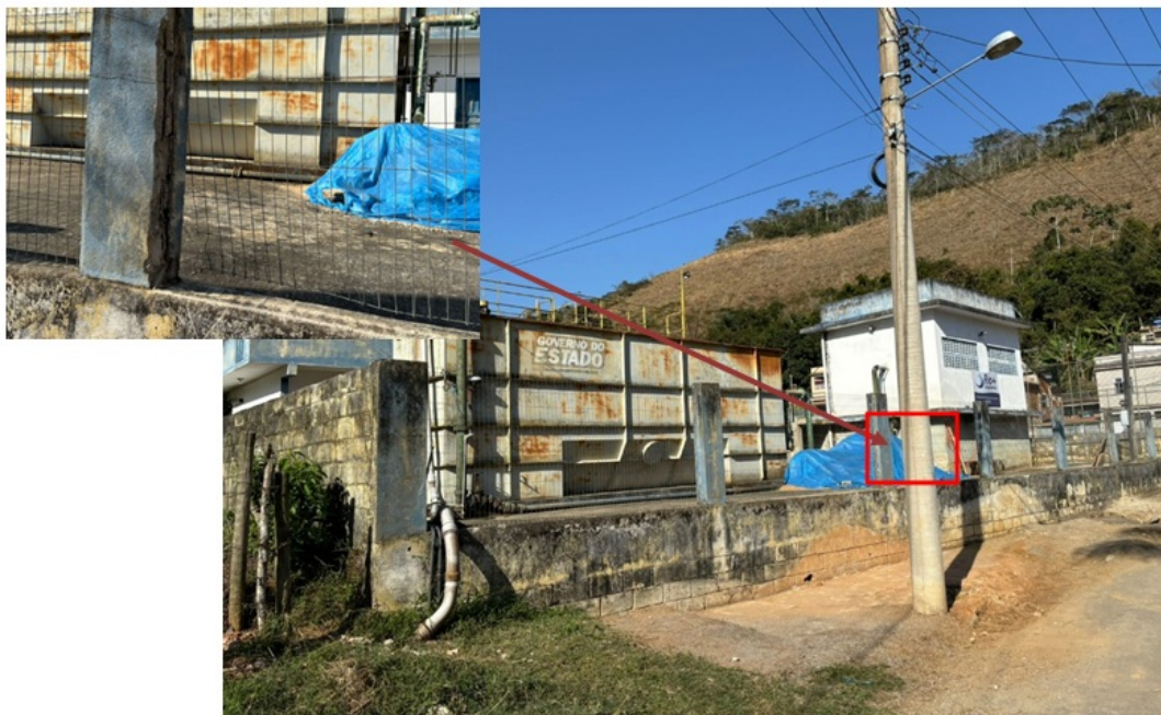
Foto 2 - Cerca danificada, calçamento precário e local da guarda da válvula e tubulação de saída da água da ETA com tampa quebrada com risco de acidente por falta de sinalização, não conformidades apontadas em relatórios anteriores.
