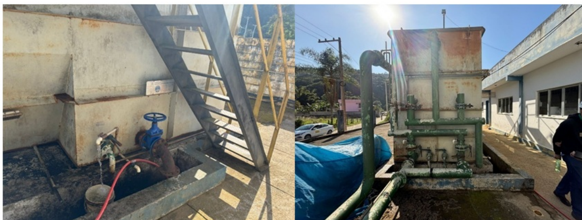
Foto 4 - Apesar de estar com a pintura desgastada e alguns pontos de corrosão, o módulo não apresenta vazamentos.
