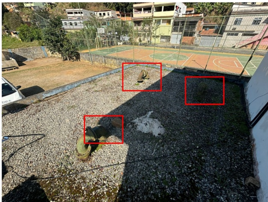
Foto 11 - Suspiros sem tela de proteção, não conformidade apontada em relatórios anteriores.
