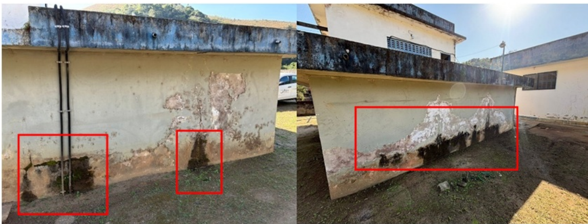
Foto 12 - Paredes laterais apresentando vazamentos, não conformidade apontada em relatórios anteriores
