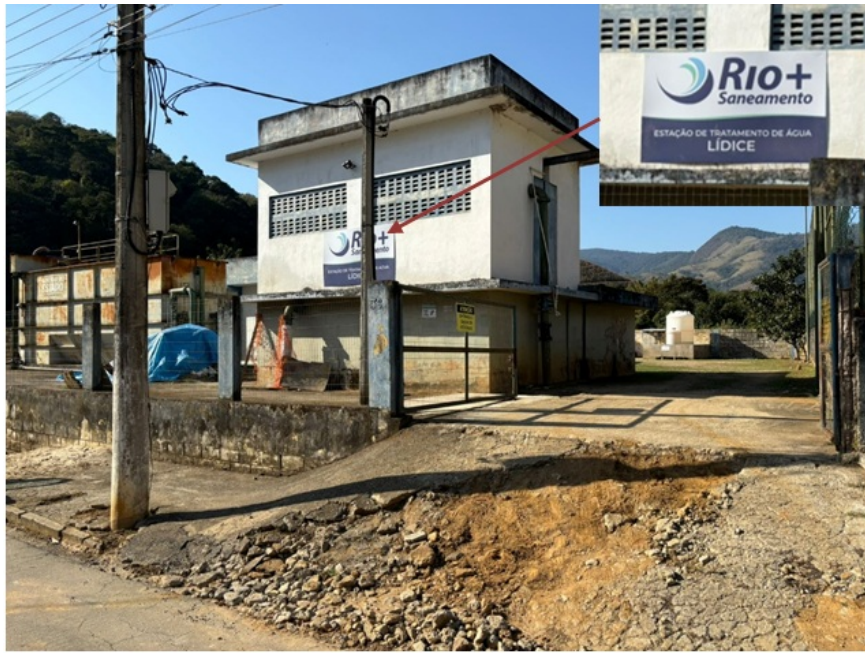
Foto1 - Precária entrada, não conformidade apontada nos relatórios anteriores
