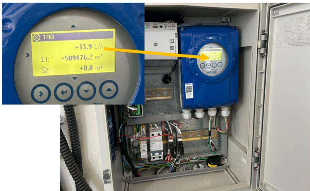
Foto 14 - Macromedidor de saída
