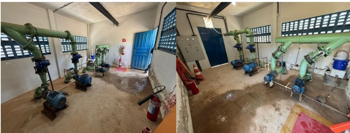
Foto 13 - Elevatória de água tratada, bombas para retrolavagem dos filtros
