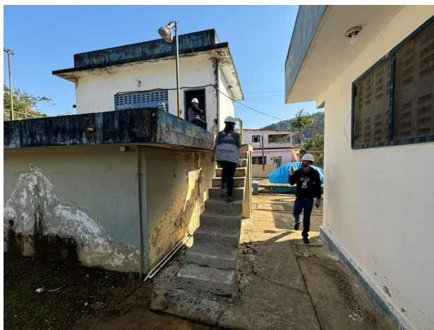
Foto 9 - Escada de acesso ao reservatório e elevatória sem guarda corpo, não conformidade apontada em relatórios anteriores.
