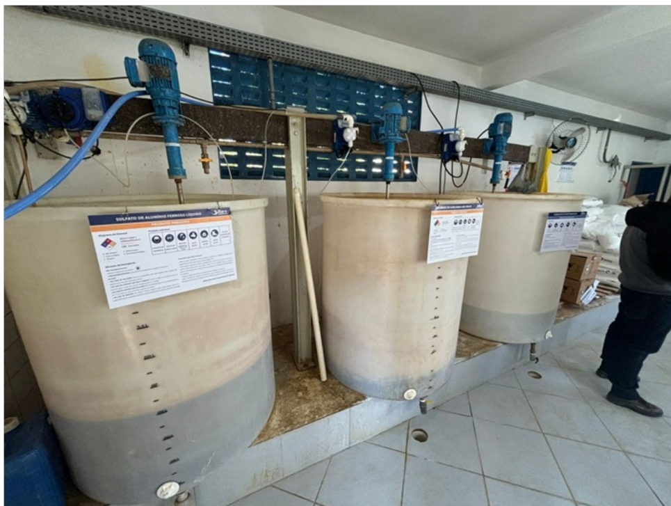
Foto 15 - Estoque e armazenamento de produtos químicos - Armazenamento com tanques sem diques de contenção para possíveis vazamentos, não conformidade apontada em relatórios anteriores
