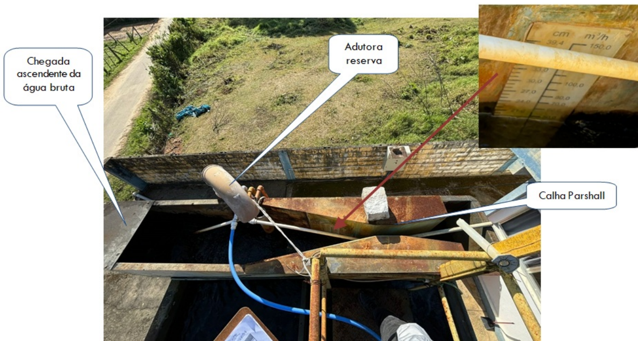
Foto 6 - Estação estava lavada e o tratamento estava em pleno funcionamento devido a excelente qualidade da água.
