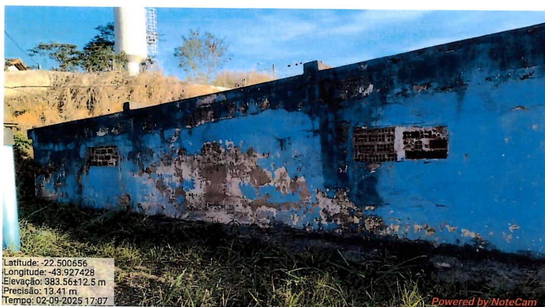
Foto 23: Mura lateral do reservatório com infiltrações.
