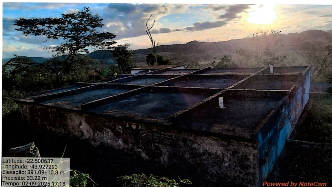
Foto 22: Estrutura do reservatório em condição insatisfatória de conservação.
