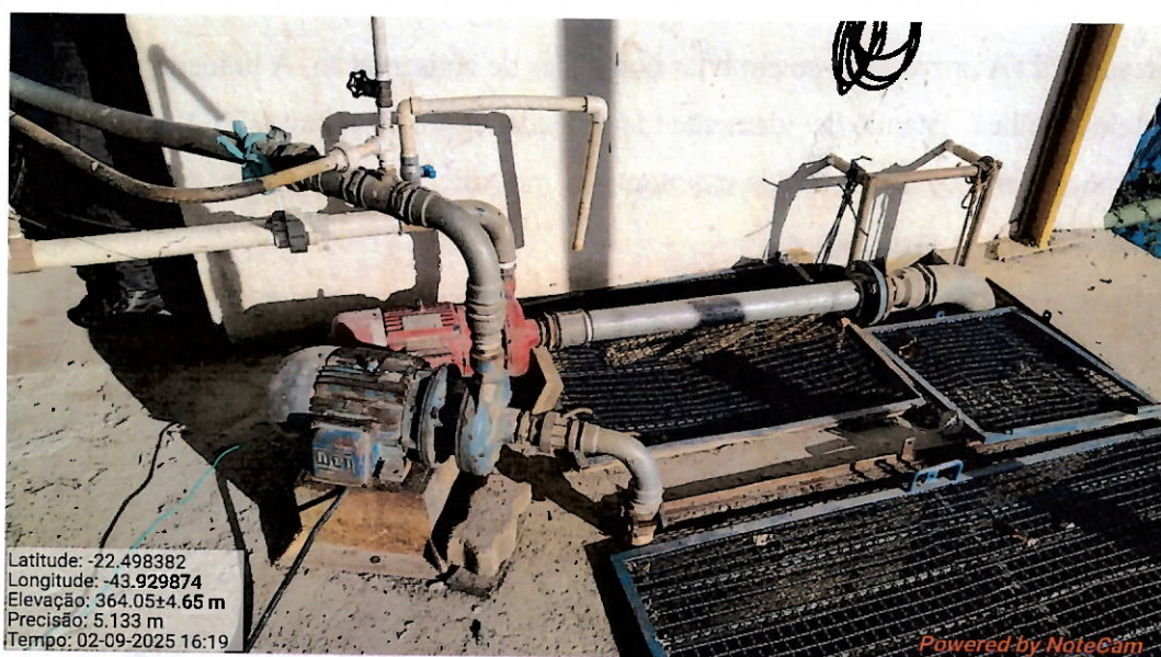
Foto 2: Bombas de potência 7,5 cv cada.
