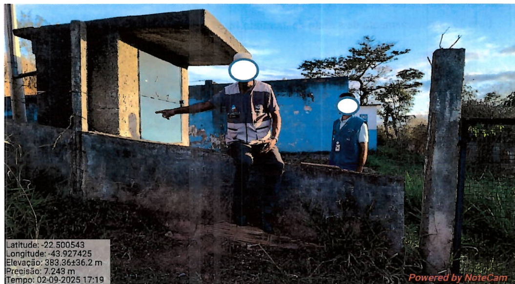
Foto 21: Muro de cercamento com altura reduzida, possibilitando o acesso de pessoas não autorizadas à área do reservatório.
