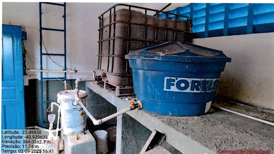
Foto 19: armazenamento de sulfato de alumínio (nota-se a ausência de bacia de contenção).
