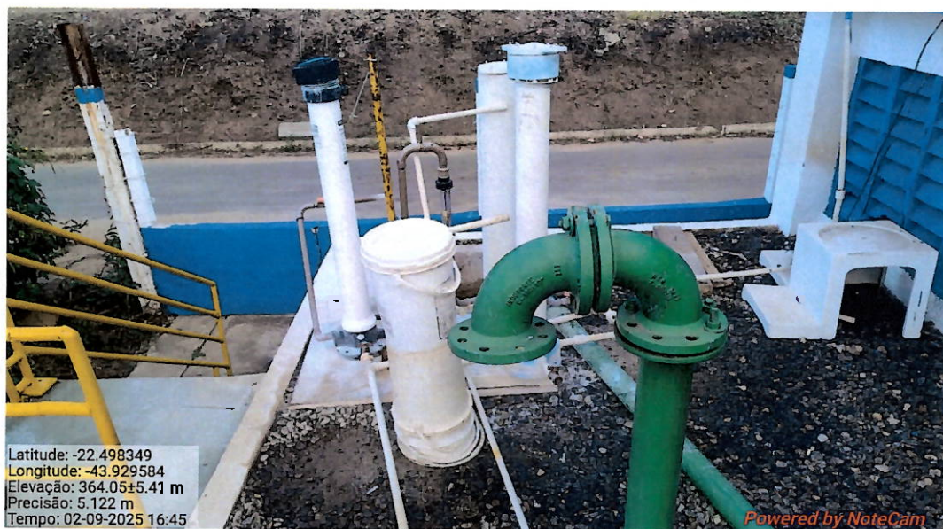
Foto 12: Sistema de cloração.
