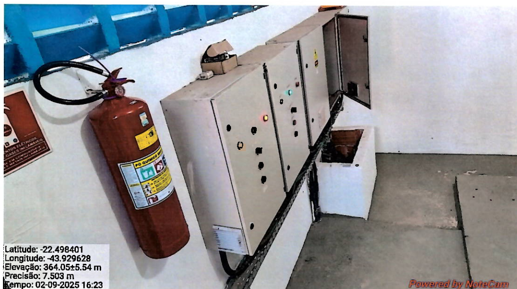
Foto 5: Extintor de incêndio
