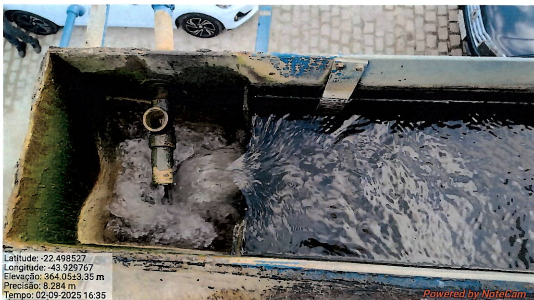
Foto 8: Entrada de água bruta na ETA.
