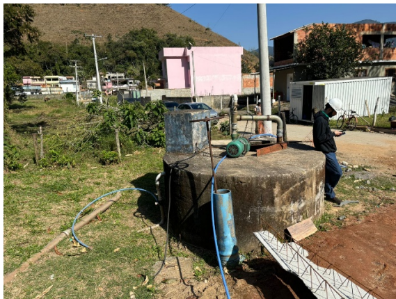
Foto 3 - Conjunto motobomba e tubulações sem proteção.
