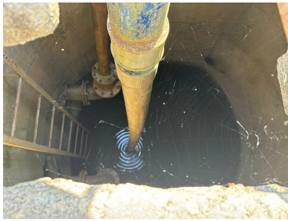
Foto 5 - Poço da captação sempre com a tampa aberta.
