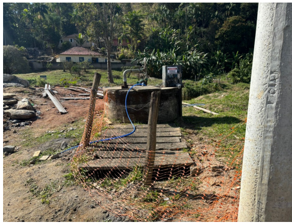
Foto1 - Captação - Local sem cercas, placas de concretos quebradas ou rachadas.
