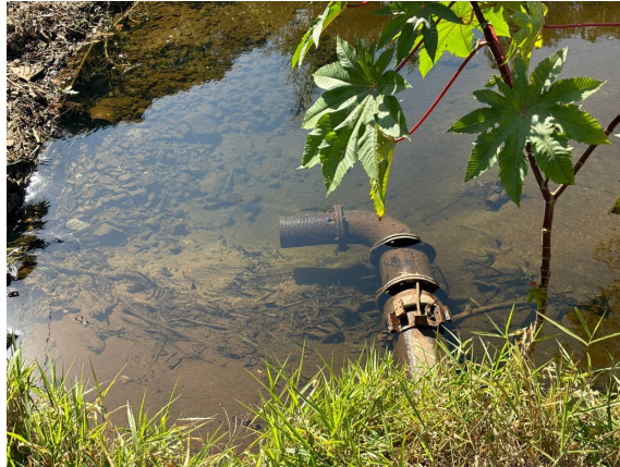
Foto 6 - Tubulação que capta água para o poço com o crivo.
