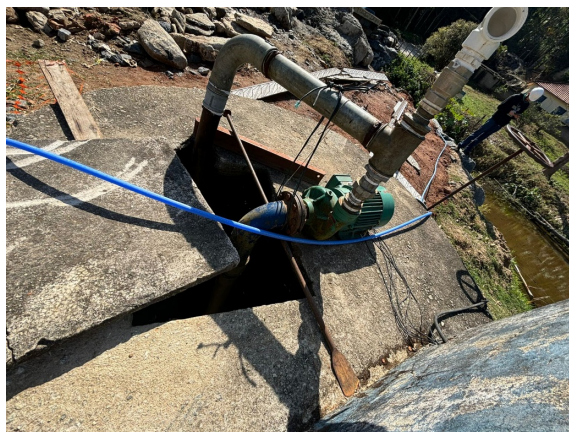
Foto 4 - Poço da captação sempre com a tampa aberta.
