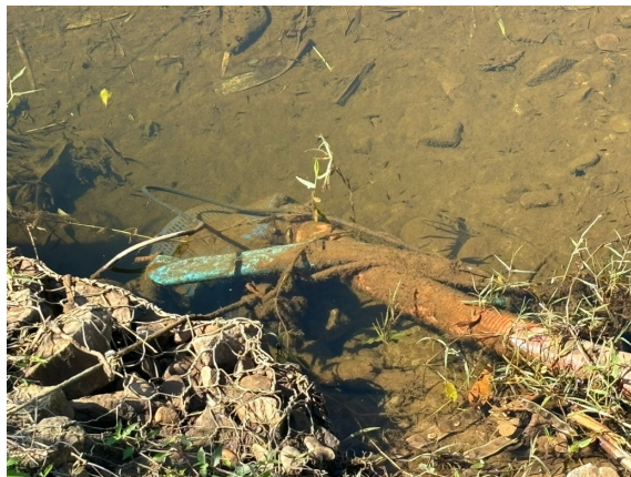
Foto 7 - Conjunto motobomba da captação reserva.
