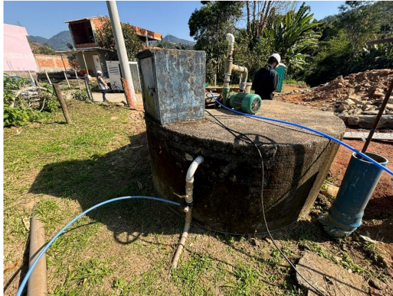
Foto 2 - Conjunto motobomba e tubulações sem proteção.
