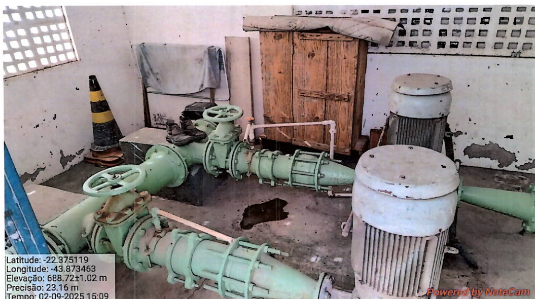
Foto 13: Conjuntos motobombas de potência 15 cv cada.
