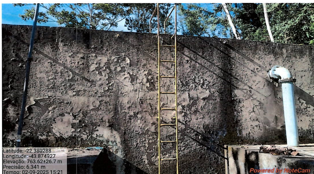
Foto 20: Escada sem gaiola de proteção.
