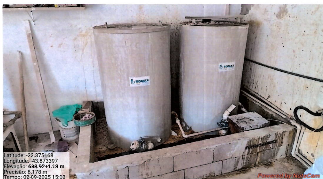
Foto 17: Armazenamento de sulfato de alumínio.
