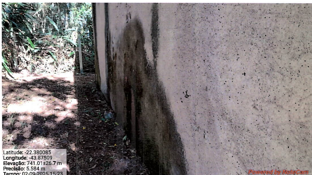
Foto 19: Parede com infiltração.
