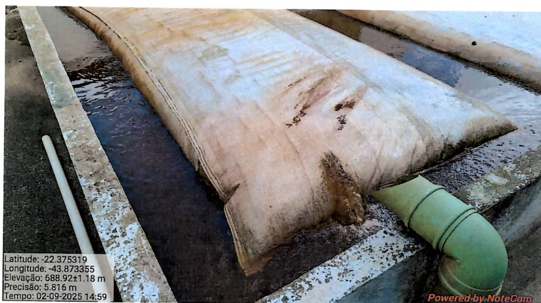
Foto 12: Geobag danificado necessitando de reparo ou substituição.
