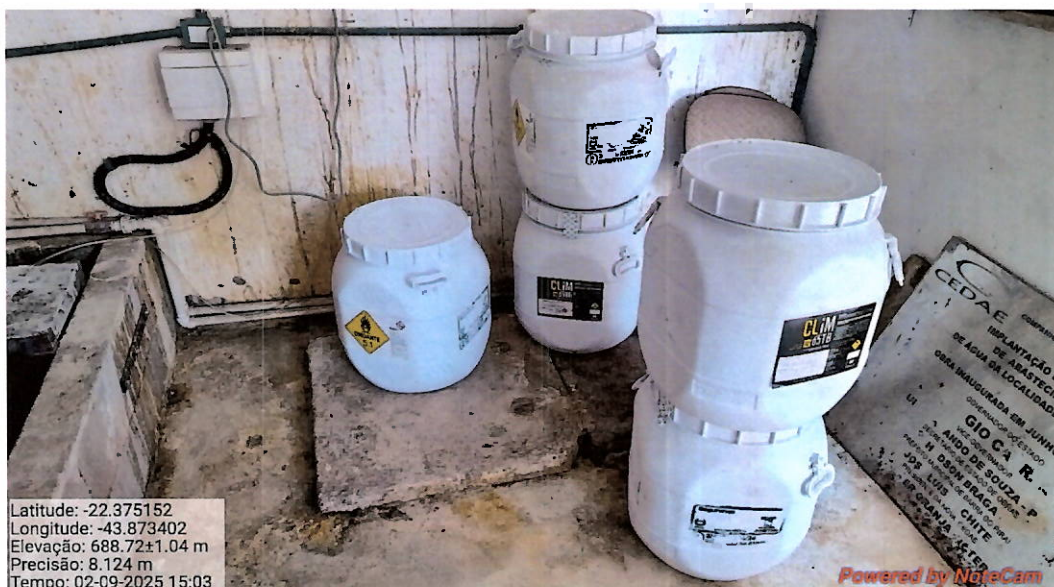
Foto 16: Armazenamento de hipoclorito de cálcio.
