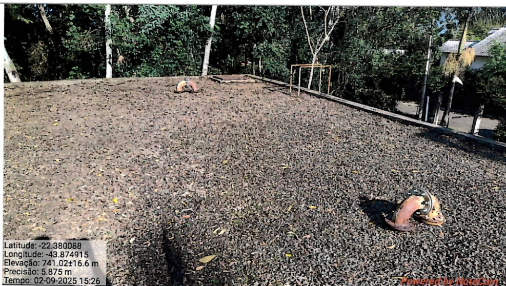
Foto 21: Ausência de guarda corpo.
