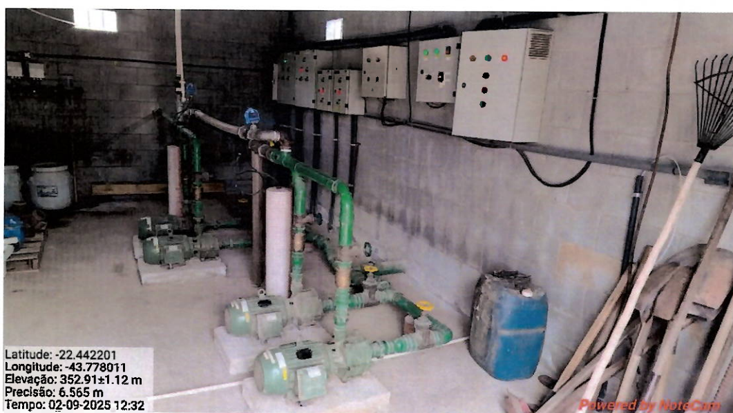
Foto 12: Conjuntos motobombas de potência 6 cv cada.
