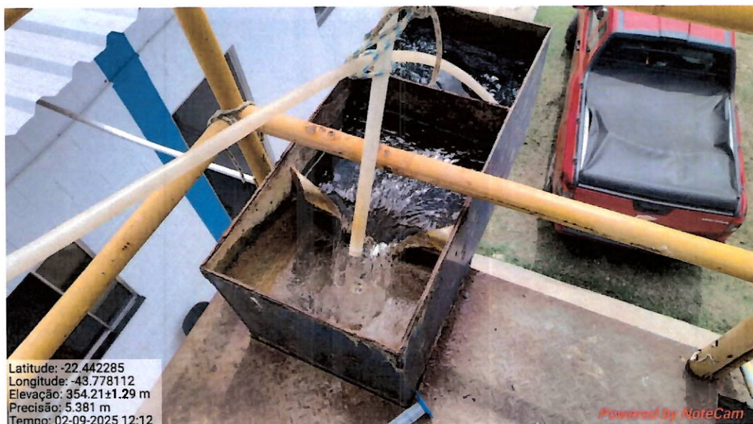
Foto 6: Entrada de água bruta na ETA.
