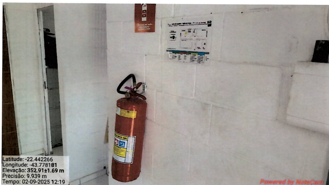
Foto 5: Extintor de incêndio e mapa de risco fixado.
