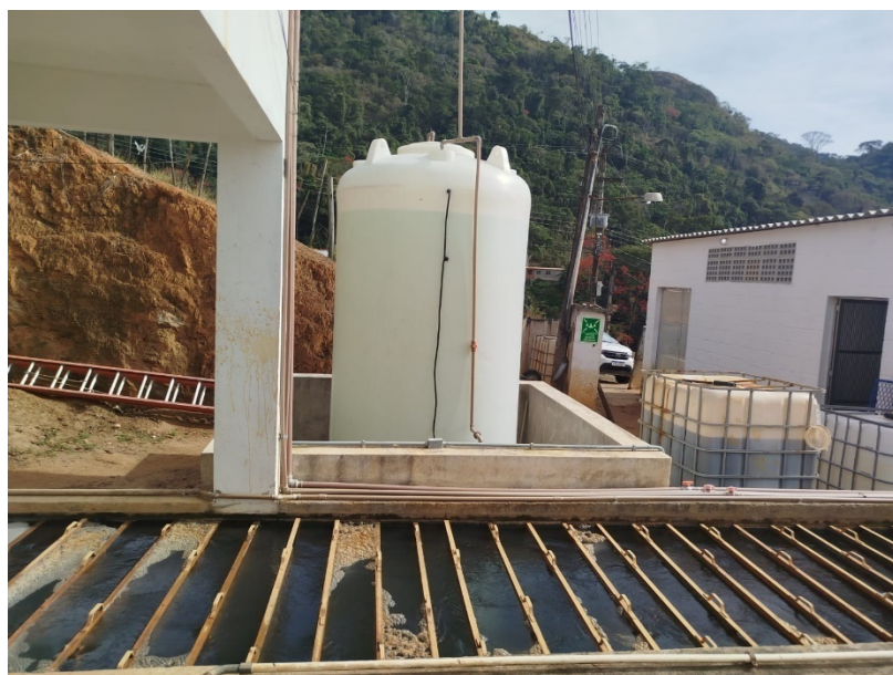
Foto 11 Reservatório de hipoclorito de sódio
