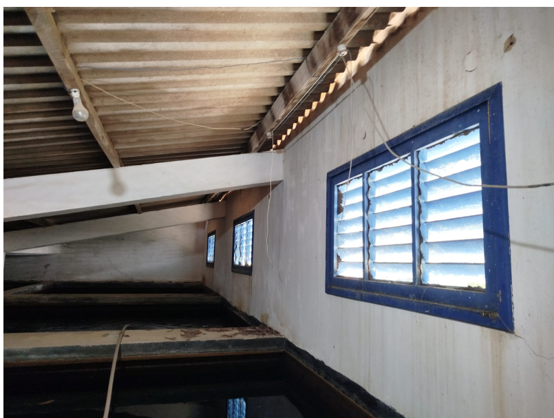
Foto 19 janelas do reservatório com frestas.
