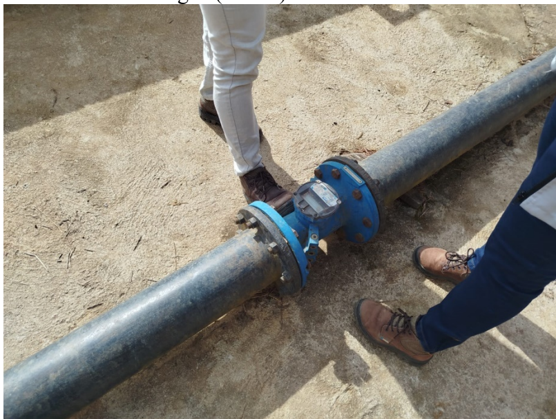
Foto 2 Macromedidor de entrada danificado.
