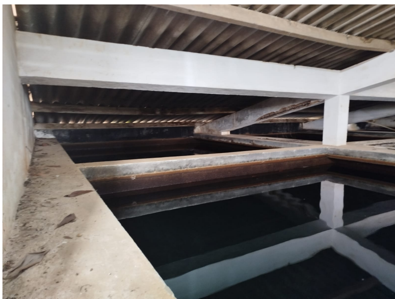
Foto 20 frestas no telhado e pontos com desagregação de material.
