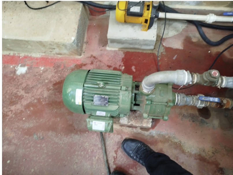
Foto 24 conjunto motobomba elevatória Morro do Estado.
