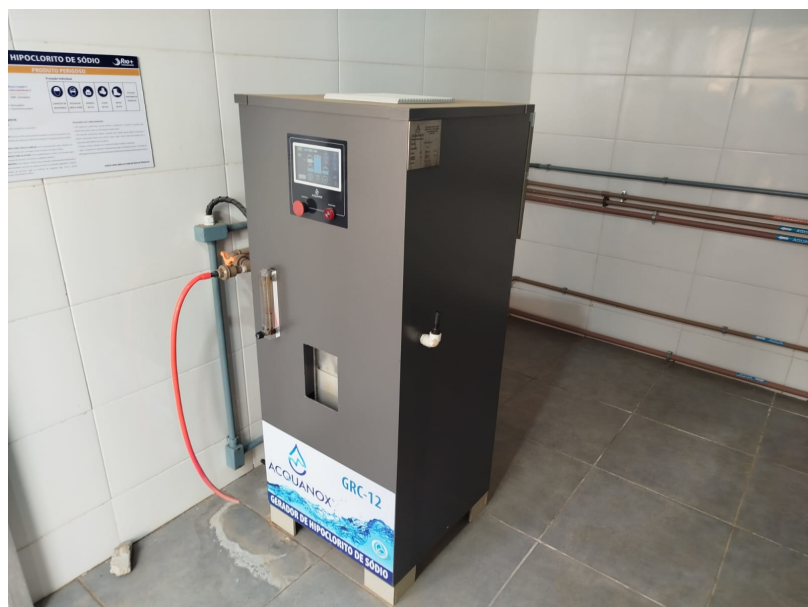
Foto 9 Gerador de hipoclorito de sódio
