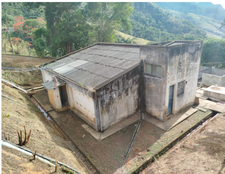
Foto 12 Sistema dosador de hipoclorito de sódio no reservatório
