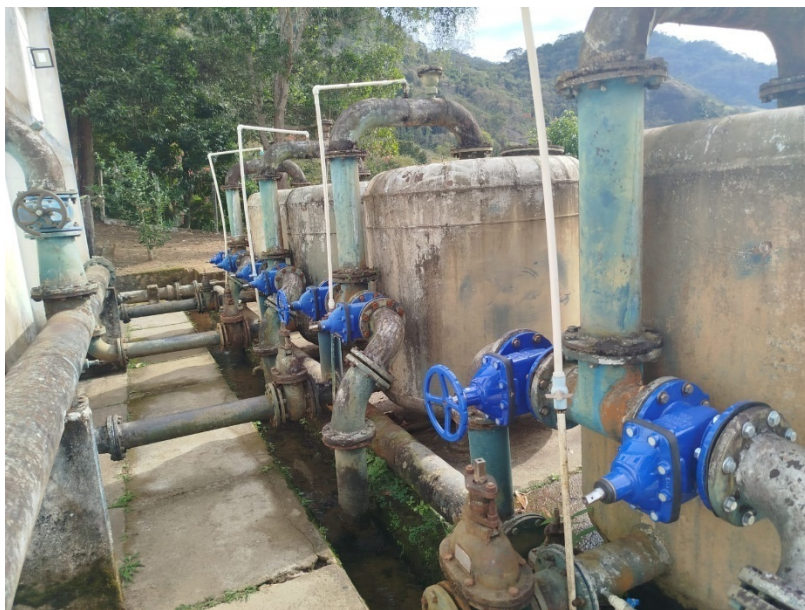
Foto 7 Filtros e válvulas
