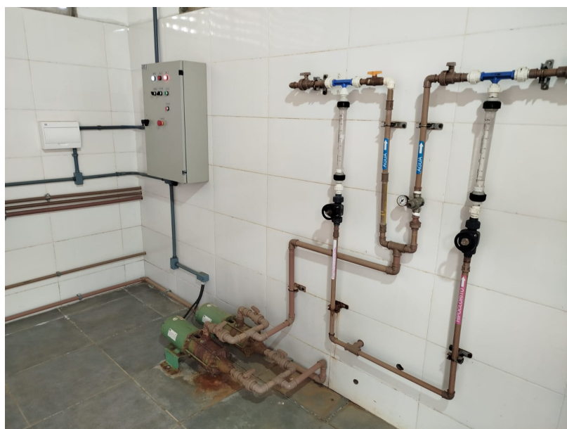
Foto 10 Sistema de bombeamento de hipoclorito de sódio para reservatório.
