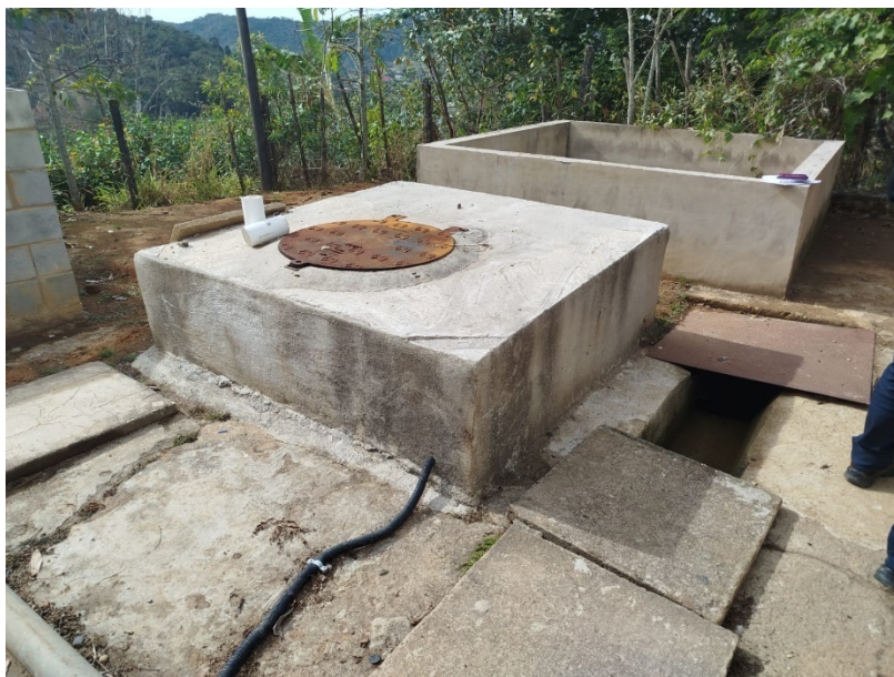
Foto 21 Local de instalação de Macromedidor na Rede de Distribuição.
