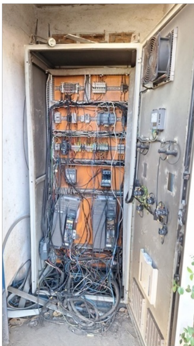
Foto 3 – Vista interna do quadro elétrico da EEE com os inversores de frequência
