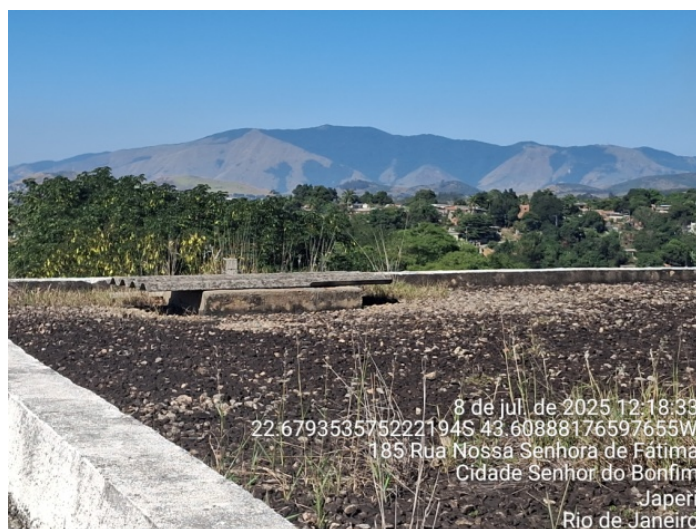
Foto 11 – Laje reservatório em evidência visita com “tamp” telha de amianto
