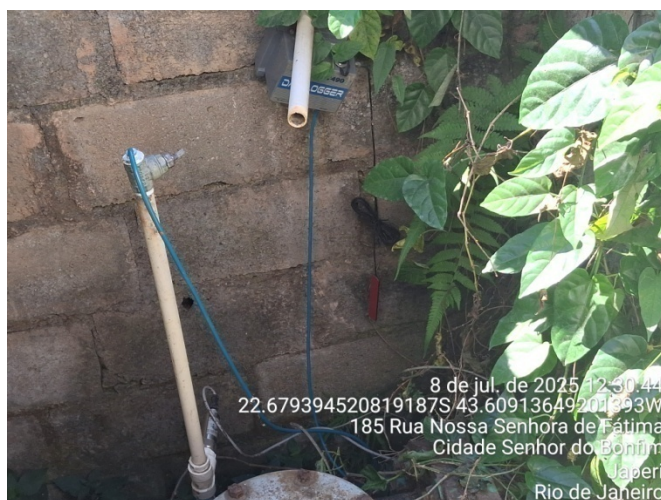
Foto 7 – Dattaloger no barrilete de chegada
