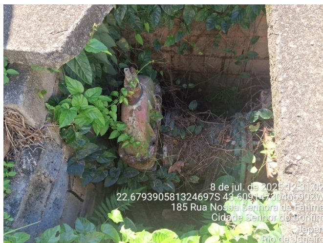
Foto 6 – Barrilete chegada reservatório
