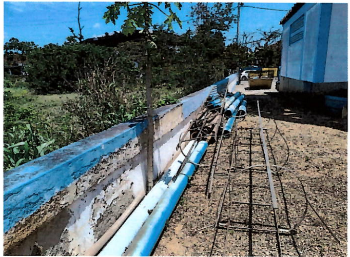
Foto 17: Muro lateral necessitando de reforma e ampliação de altura.
