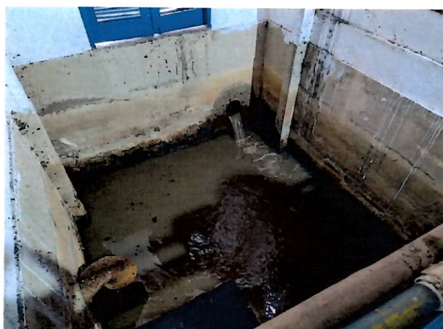
Foto 8: poço de recalque da EEAB.
