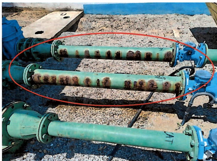
Foto 40: Adutoras DN 150 com sinais de corrosão.
