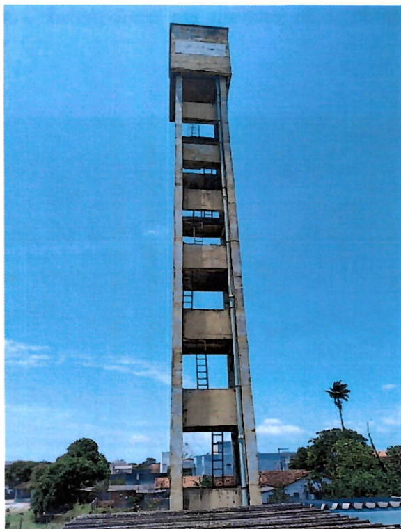
Foto 44: Reservatório aéreo desativado.
