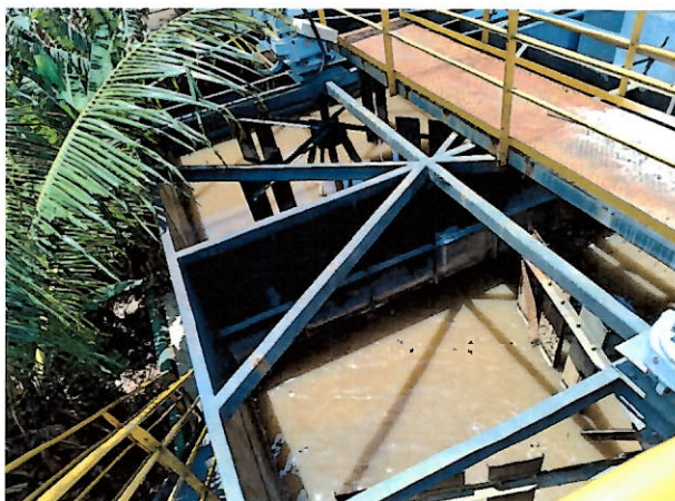
Foto 23: Floculadores da NETA (mecânico).
