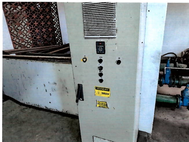
Foto 11: Pannel elétrico dos grupos motobombas.
