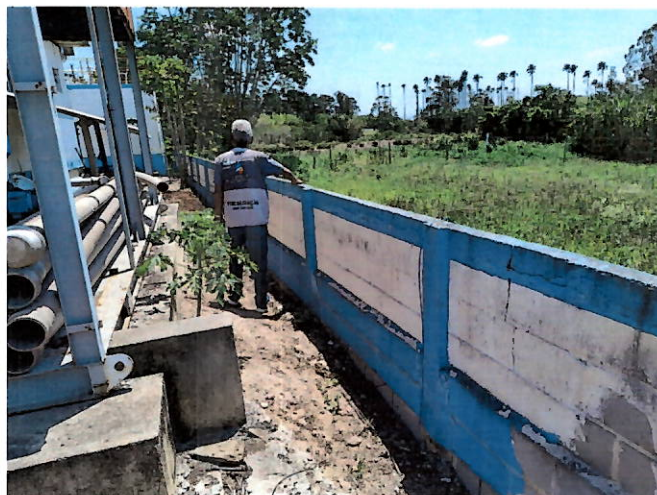
Foto 18: Muro de fundos necessitando de reforma e ampliação de altura.
