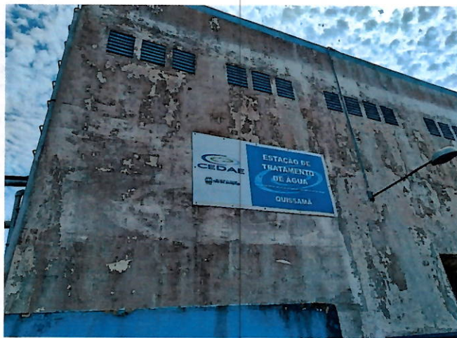
Foto 15: Prédio da ETA necessitando de pintura.
