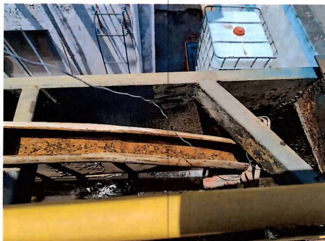
Foto 20: adição de coagulante sulfato de alumínio. (NETA).
