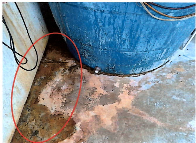
Foto 33: Vazamento proveniente do tanque de sulfato de alumínio.
