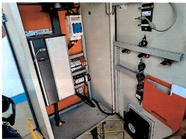
Foto 39: Quadro elétrico dos conjuntos motobombas.
