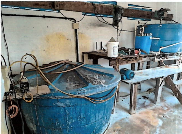
Foto 32: Tanques de sulfato de alumínio líquido (à esquerda) e cal (à direita) necessitando de bacias de contenção.
