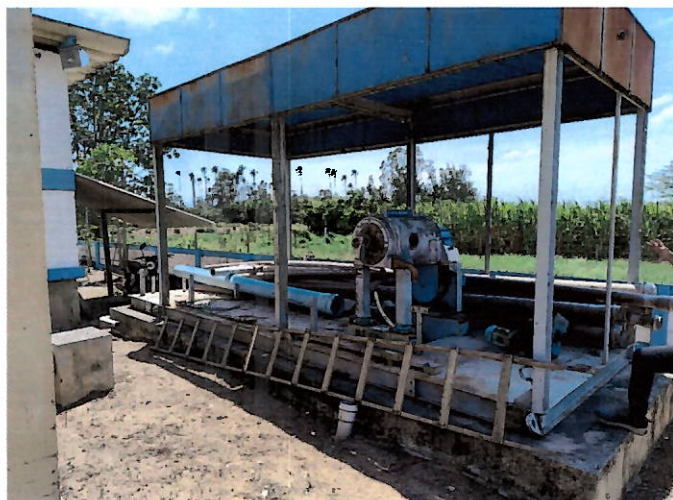
Foto 45: sistema de tratamento de lodo desativado.
