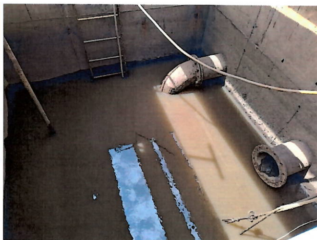
Foto 4: Interior do poço de recalque 1. Ausência de uma bomba afogada que foi removida para manutenção).
