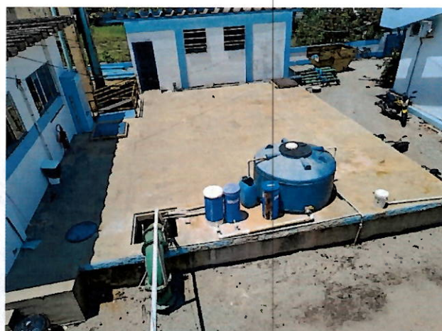
Foto 30: Vista superior do tanque de contato (capacidade de 250 m 3 ).
