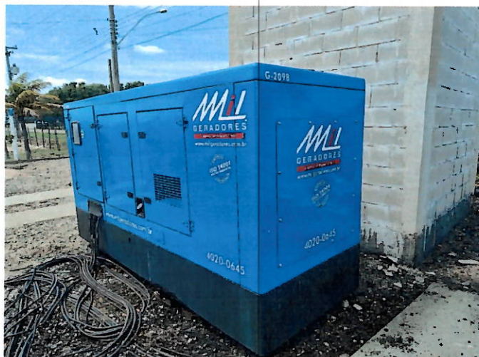
Foto 7: grupo gerador de energia elétrica.
