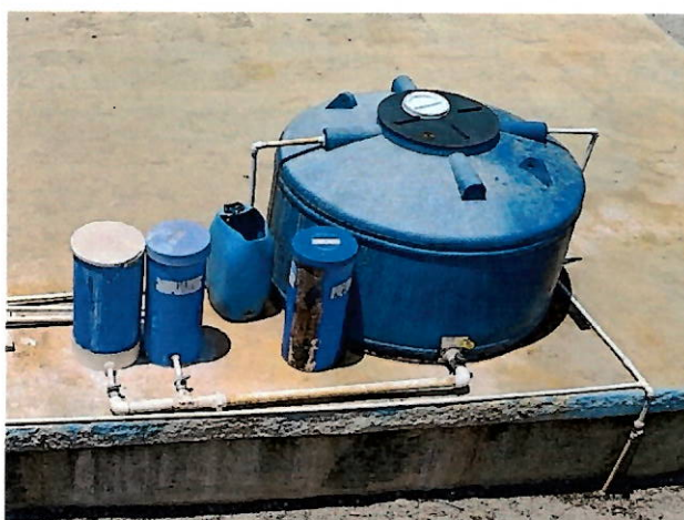
Foto 29: Sistema de desinfecção com Hipoclorito de Cálcio
