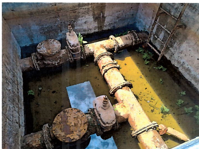
Foto 5: Interior do poço de recalque 1 .
