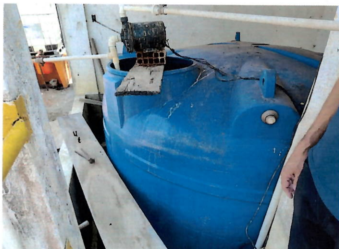
Foto 36: tanque de sulfato de alumínio com bacia de contenção.
