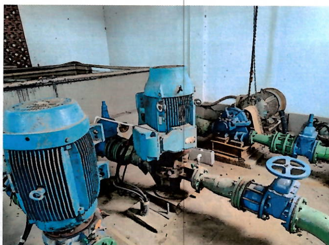
Foto 9: Conjuntos motobombas de 100 cv cada (1 em operação e 2 reservas).
