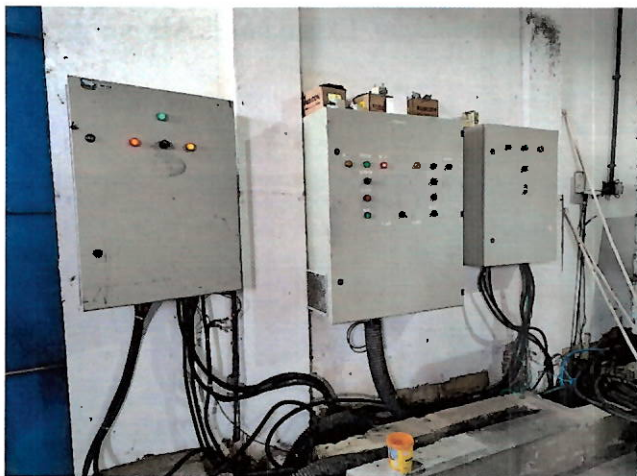
Foto 10: Painéis elétricos dos grupos motobombas.
