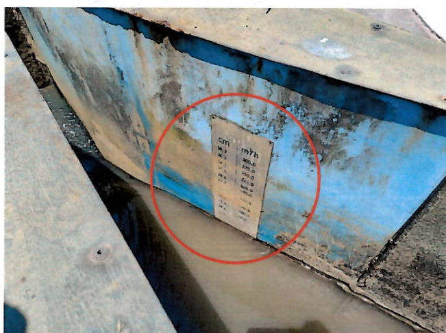
Foto 21: Calha Parshall (NETA). Necessidade de substituição de régua de medição. Não é possível medir a vazão em níveis mais baixos.
