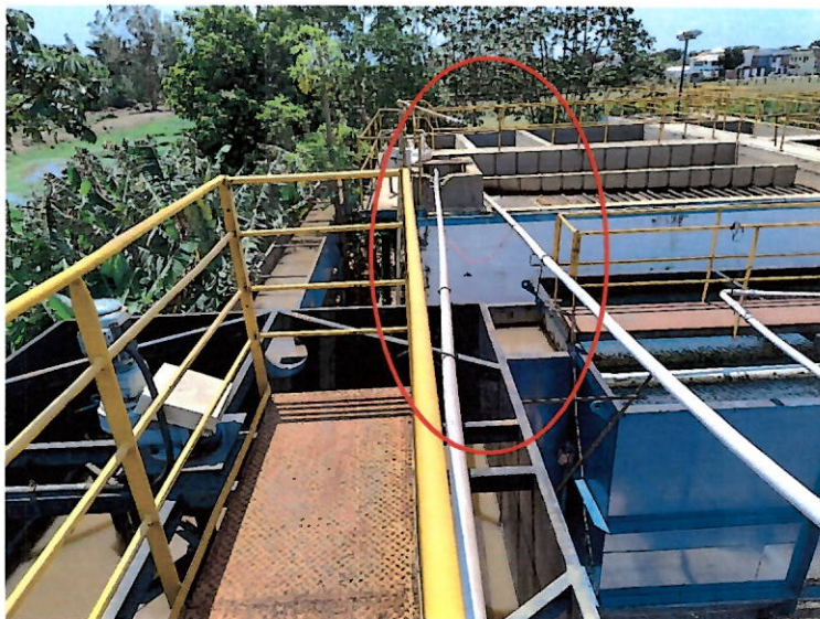
Foto 26: Ausência de passagem direta entre os flocculadores e decantadores (NETA).
