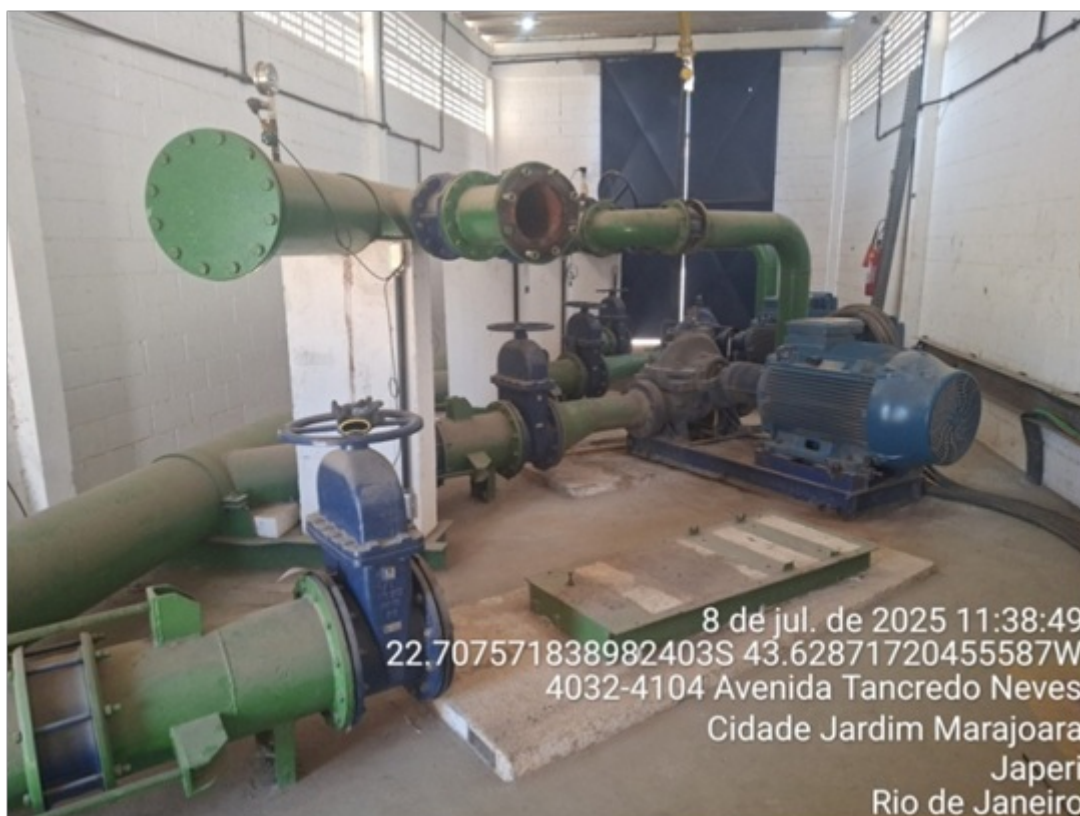
Foto 2 – Barrilete do booster e conjuntos motobombas
