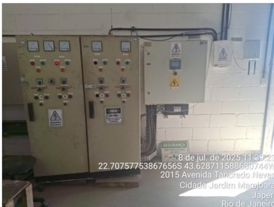
Foto 4 – Painéis de controle e automação
