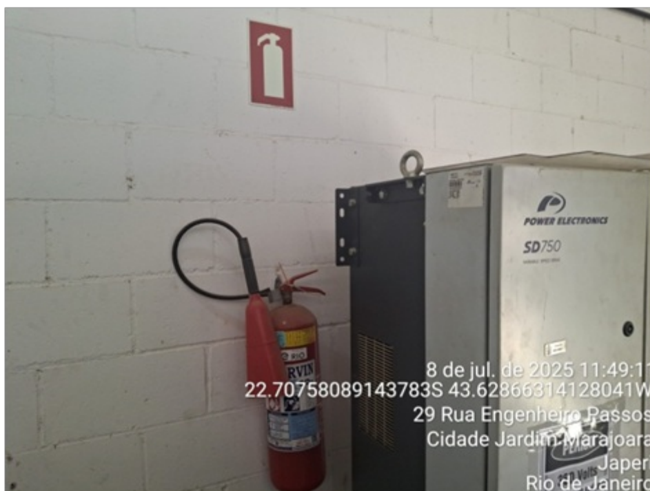
Foto 5 – Inversor de frequência e extintor válido
