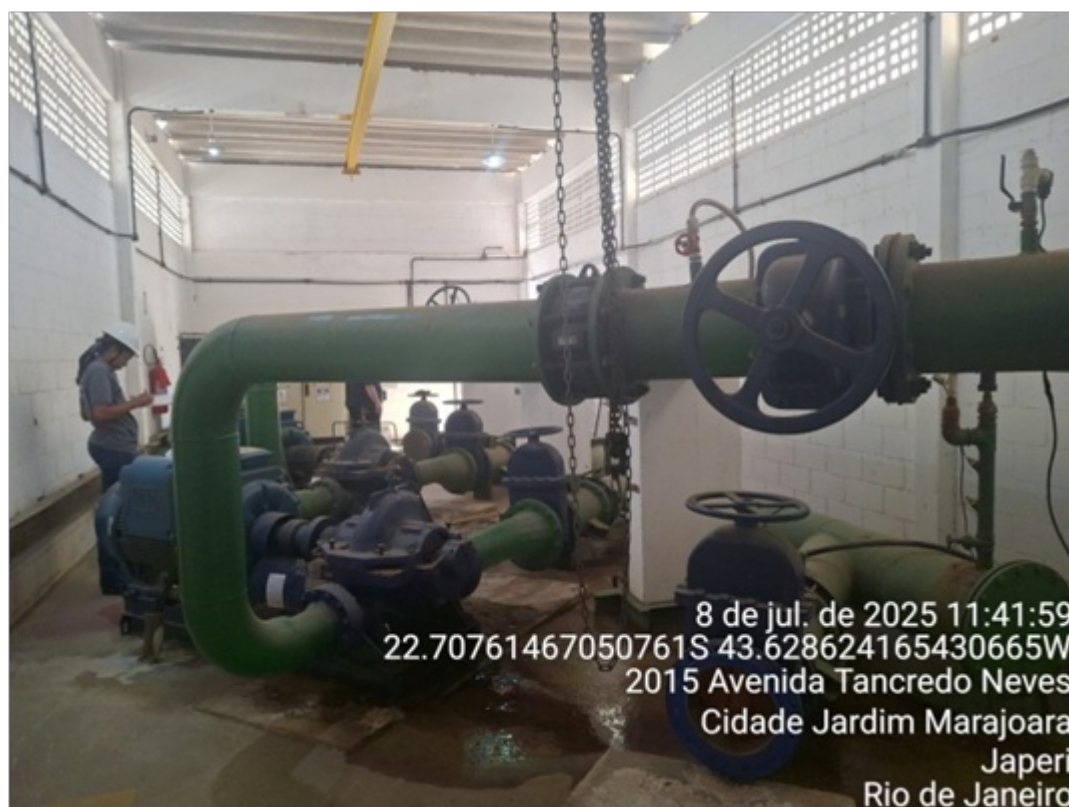
Foto 3 – Barrilete do booster e conjuntos motobombas
