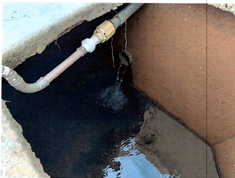
Foto 4 – Reservatório para cloração (UT), com vista da água captada (baixa turbidez).
