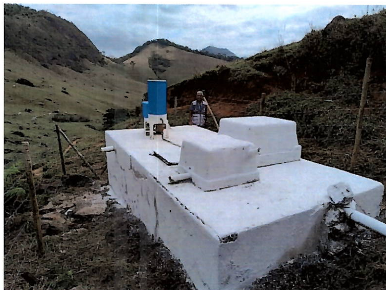
Foto 2 – UT Dubois com dosagem de hipoclorito de cálcio no reservatório.
