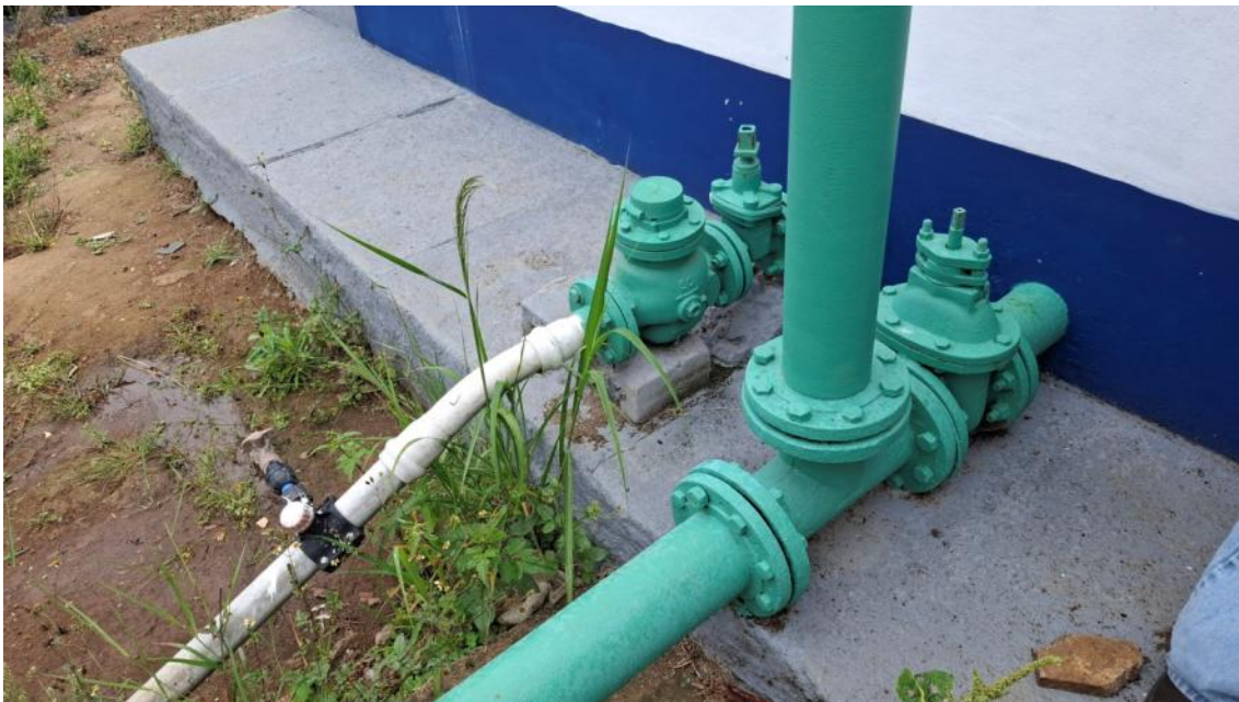
Foto 03 – tubulação de distribuição
