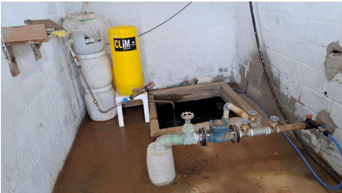
Foto 03 – estrutura de desinfecção
