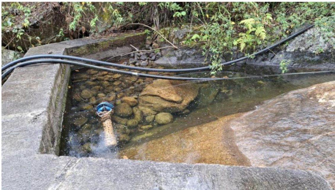
Foto 01 - barragem e crivo
