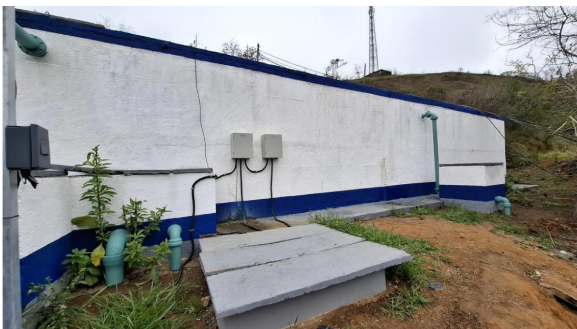
Foto 01 - vista da estrutura e tubulações de distribuição
