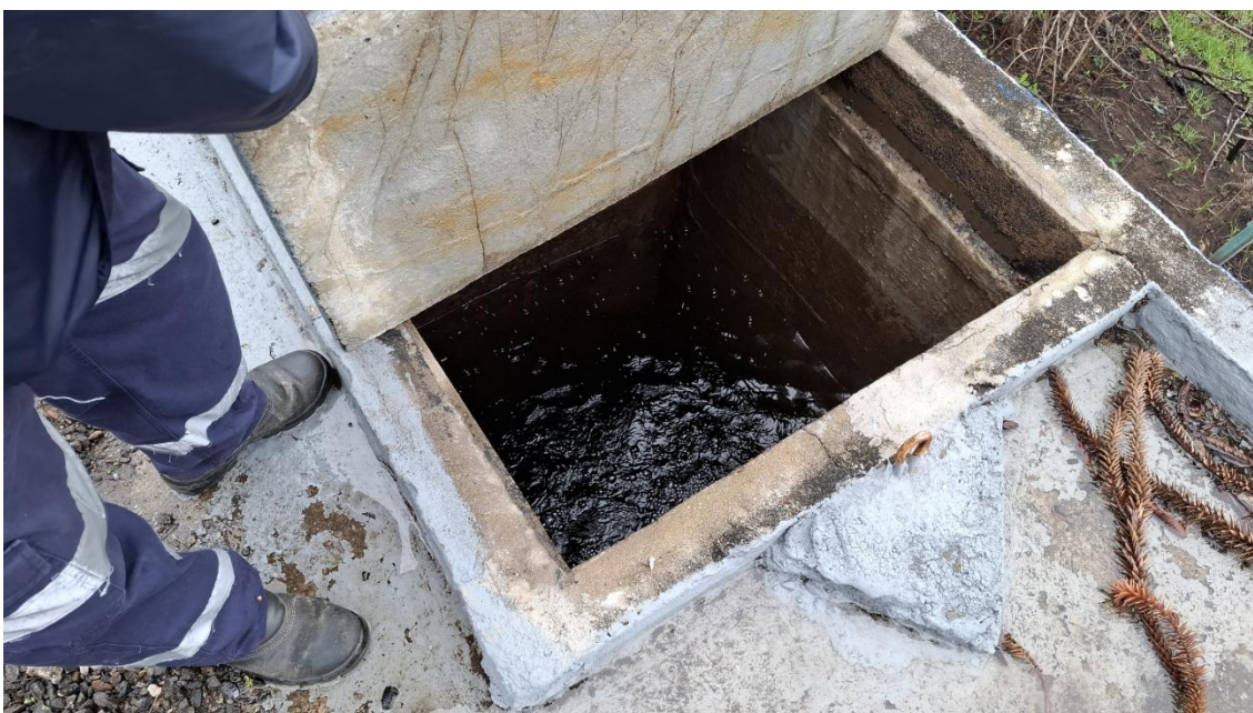
Foto 04 - caixa de inspeção
