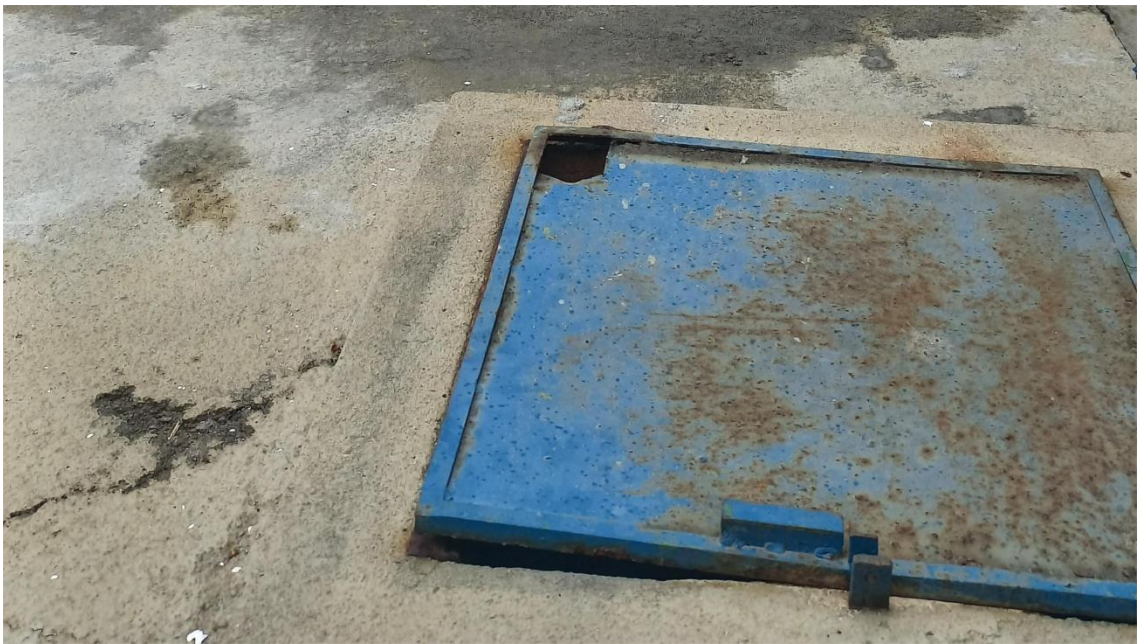
Foto 07 - avaria no tanque de contato
