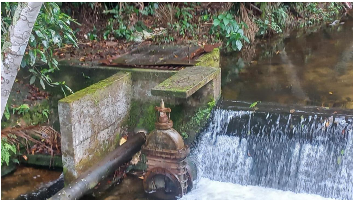
Foto 02 - crivo para captação
