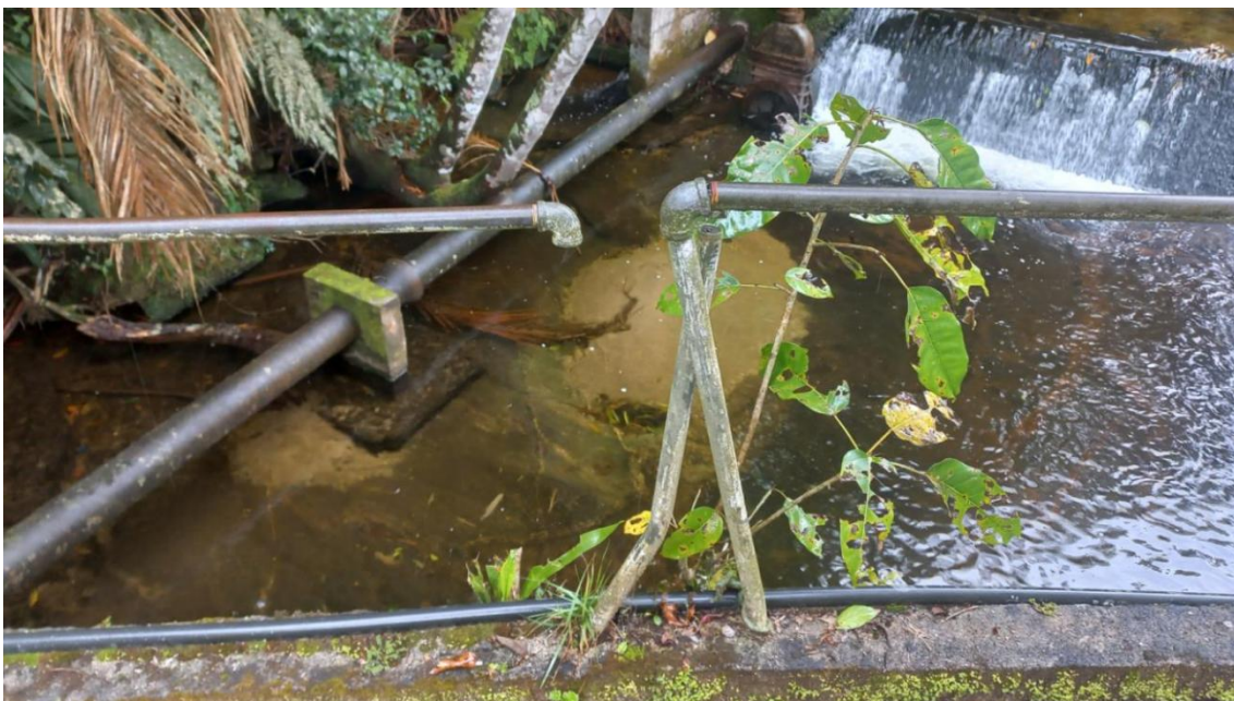
Foto 04 - ruptura no guarda-corpo
