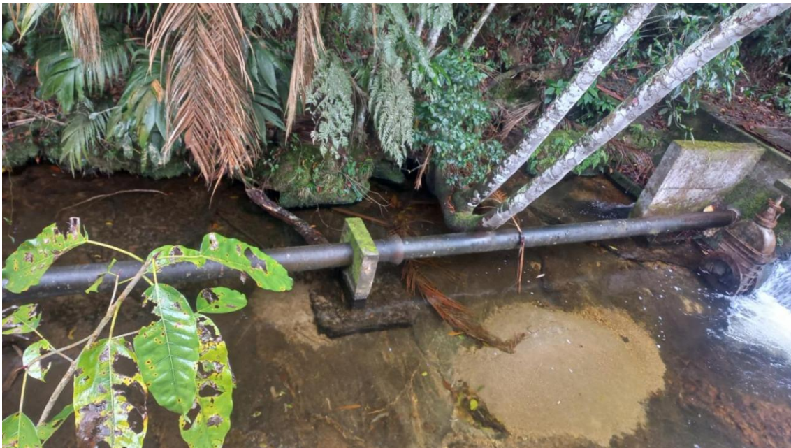
Foto 03 - tubulação para adução até a estação de tratamento
