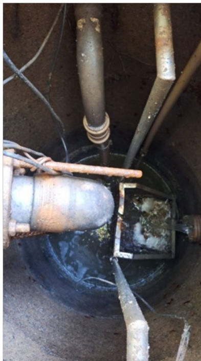
Foto 4 – Poço da EEE com uma bomba submersível em operação.
