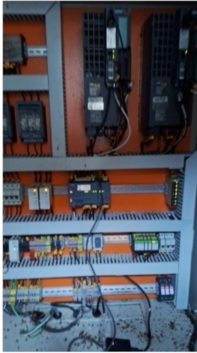
Foto 2 – Quadro elétrico da EEE com os inversores de frequência.
