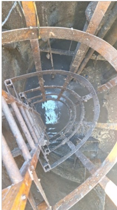
Foto 4 – Poço das bombas submersíveis, com uma de stand-by.
