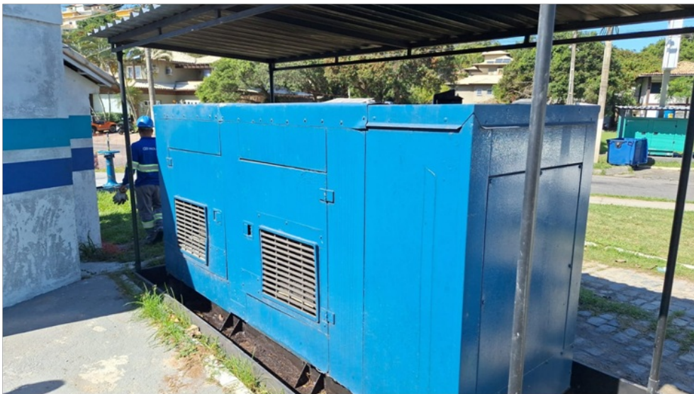
Foto 5 – Gerador para segurança operacional.
