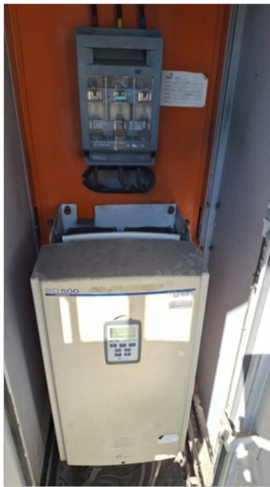
Foto 3 – Quadro elétrico com inversor de frequência.
