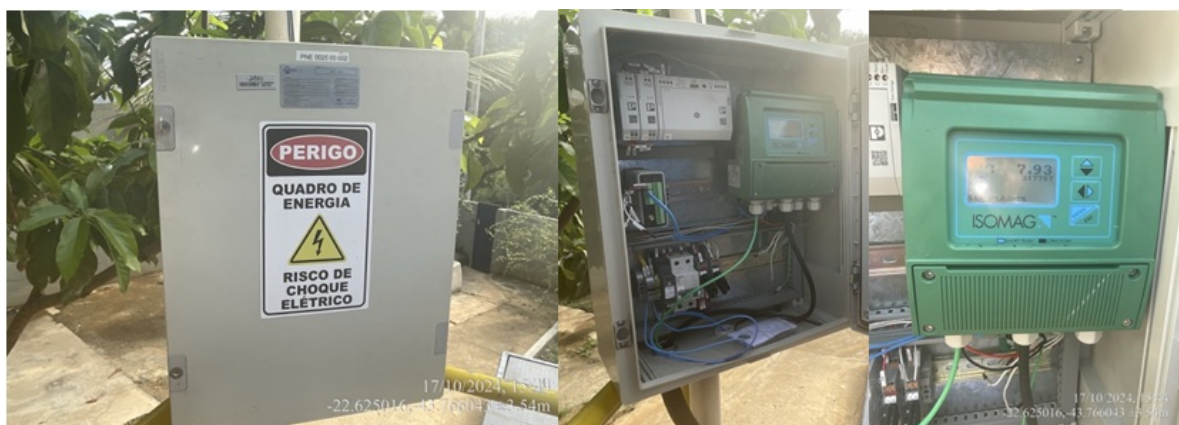
Foto 04 – Quadro de comando de entrada da água bruta com indicador de vazão
