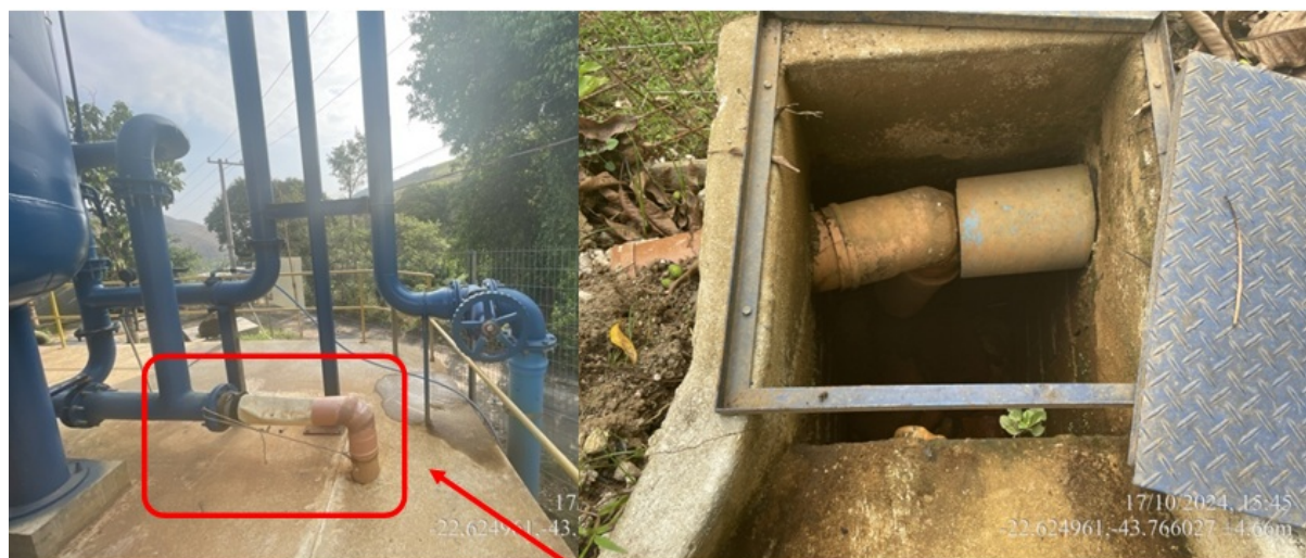
Foto 06 – Tubulação de saída de lodo
