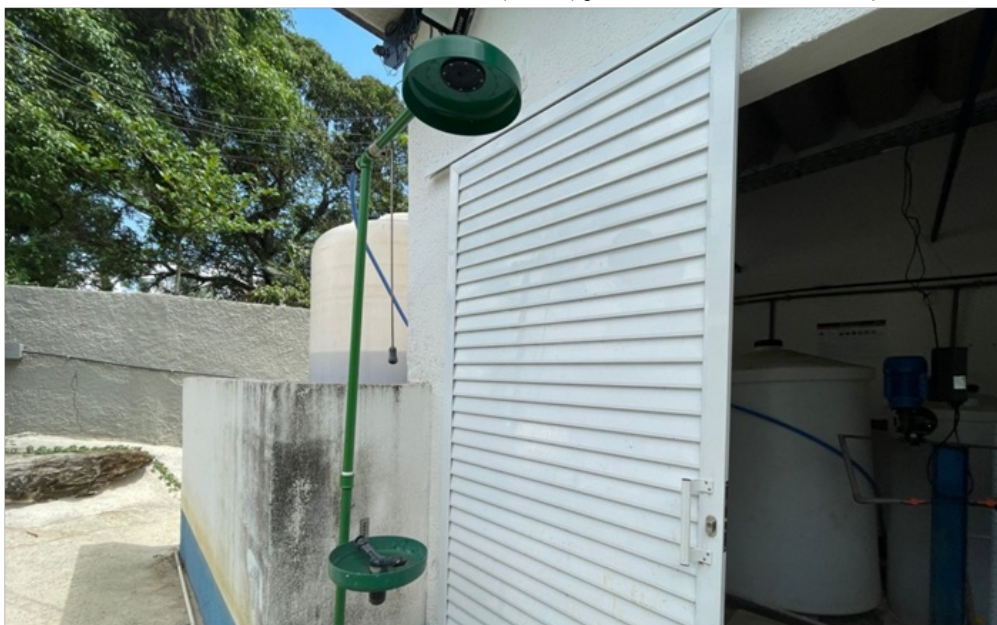
Foto 17 – Chuveiro e lavatório para emergências (acidente com produtos químicos)
