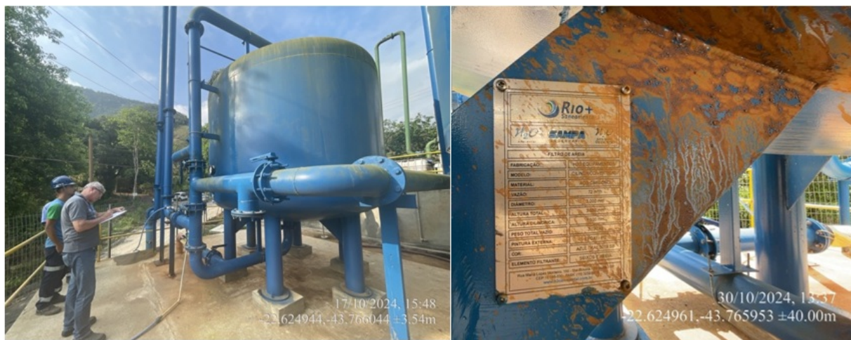
Foto 09 – Tanque de filtragem e cloração
