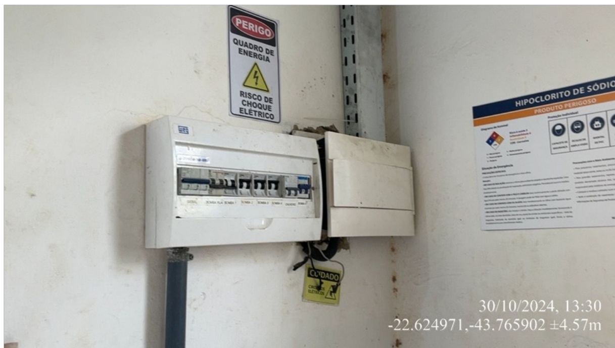
Foto 20 – Pannel de energia na sala de armazenamento de produtos e placa de Hipoclorito de sódio
