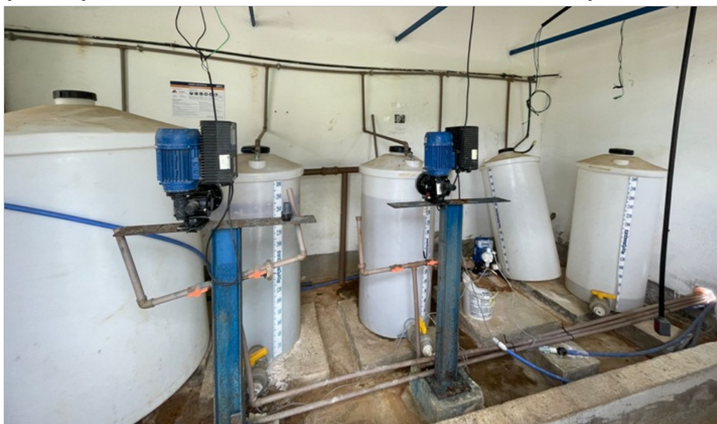
Foto 15 – Reservatório de produtos químicos interno
