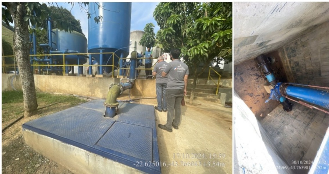
Foto 03 – Tubulação de entrada da água bruta no tanque de tratamento
