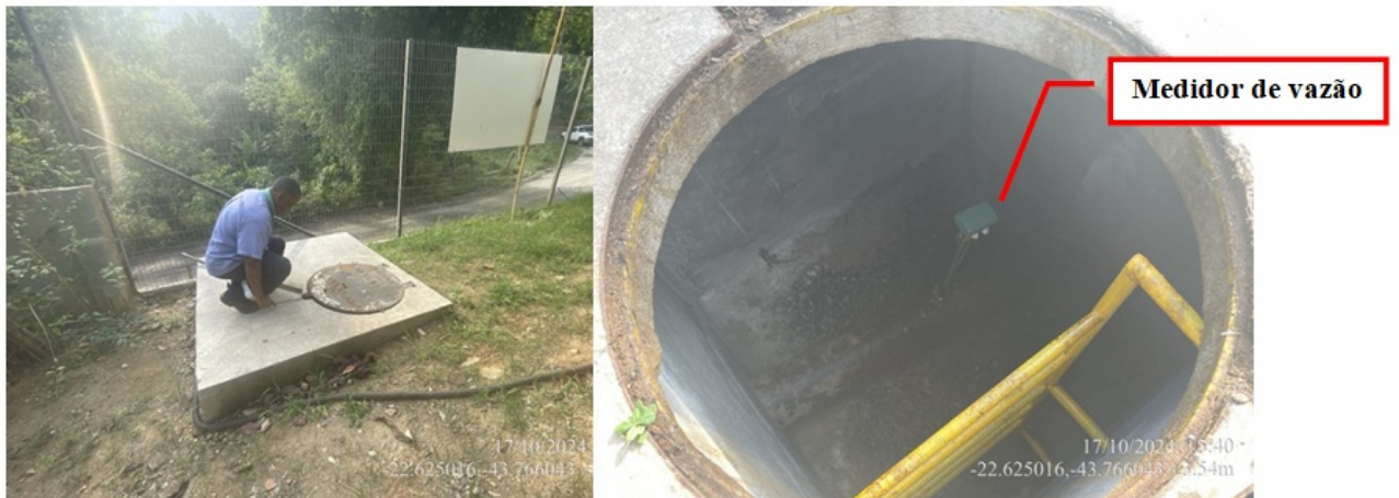
Foto 02 – Poço com tubulação de entrada da água bruta
