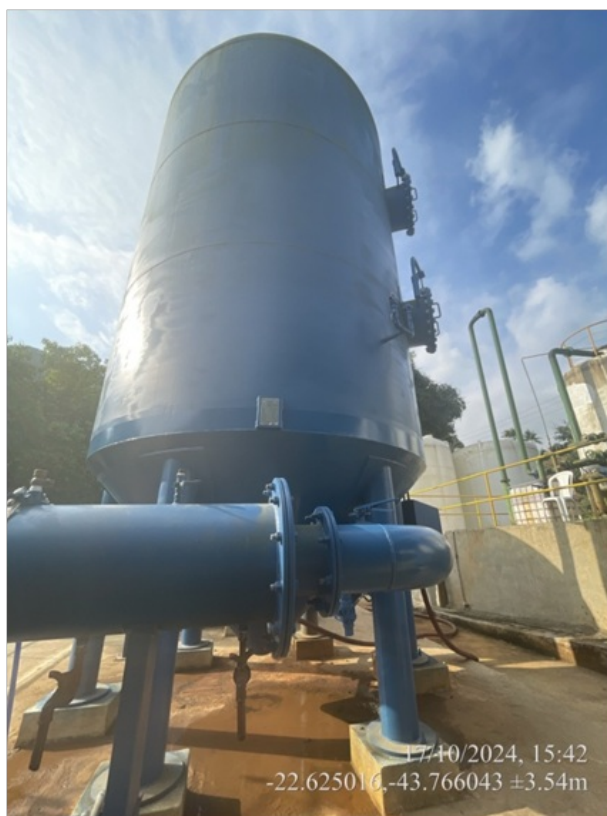
Foto 05 – Tubulação de transferência do tratamento preliminar para o floco-decantador
