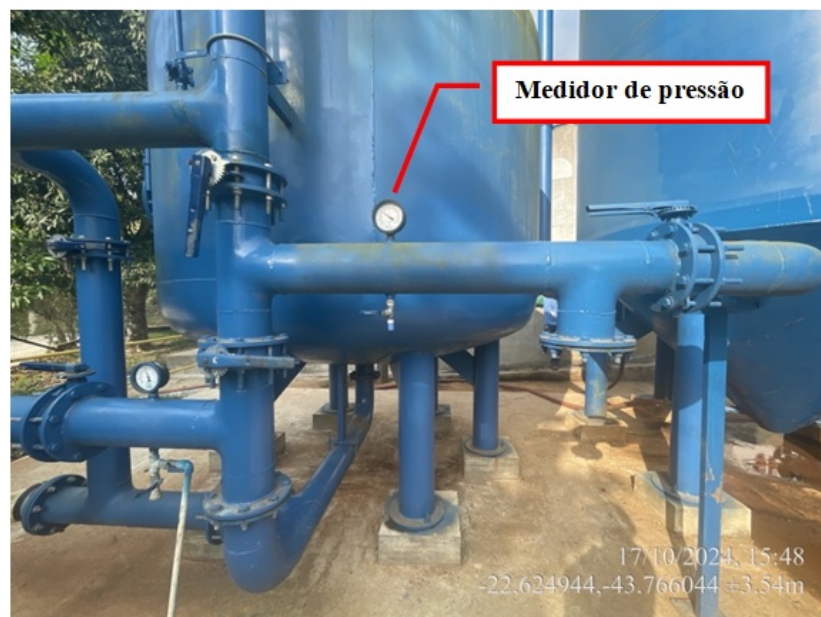
Foto 10 – Tubulação de filtragem e cloração com indicadores de pressão
