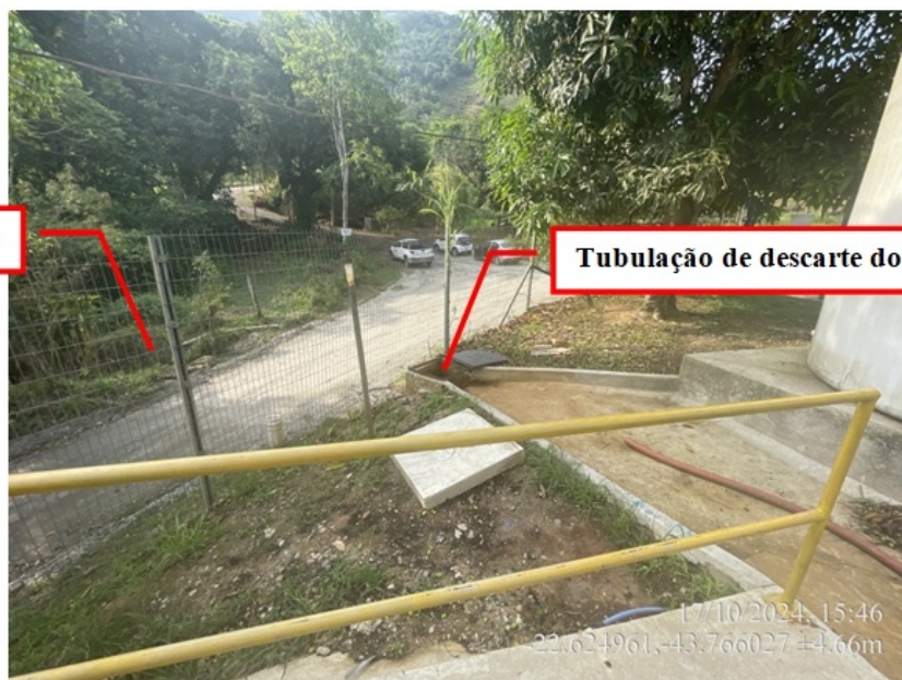
Foto 07 – Saída de lodo para o corpo hídrico
