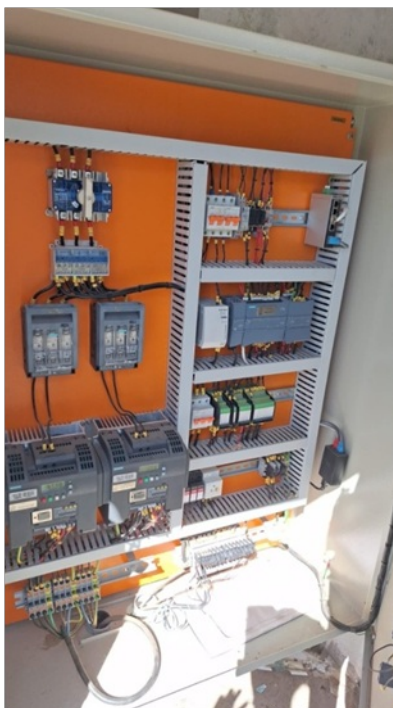
Foto 4 – Quadro elétrico da EEE com dois inversores de frequência.
