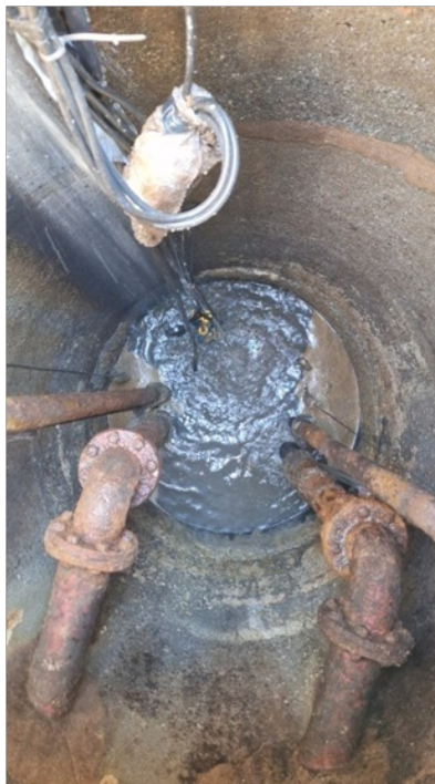
Foto 3 – Poço das bombas submersíveis, com uma de stand-by.
