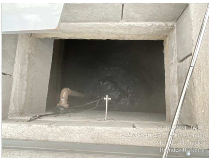
Foto 09 – Tanque SBR em aeração
