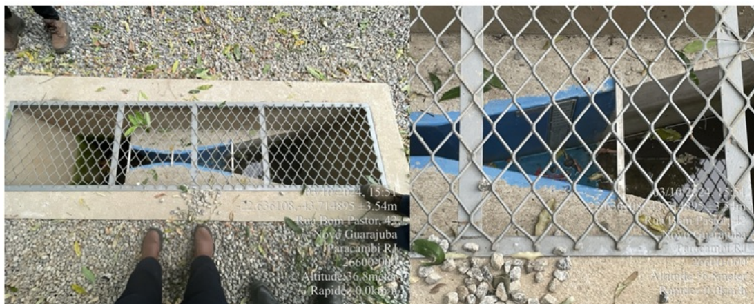
Foto 13 – Calha Parshall e Régua de medição de vazão
