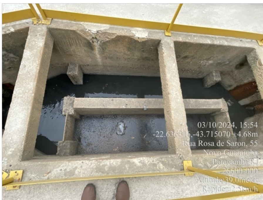
Foto 05 – Caixas de areia
