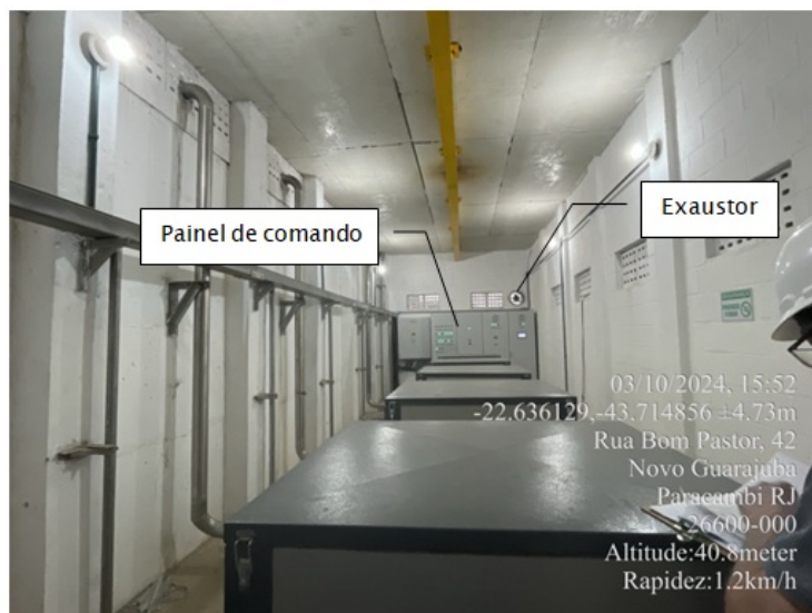
Foto 12 – Quadro de comando
