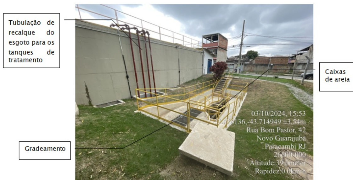
Foto 03 – Visão geral da chegada de esgoto
