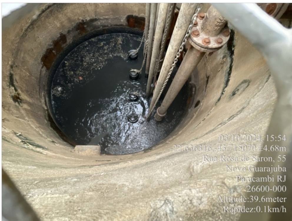
Foto 06 – Poço de sucção
