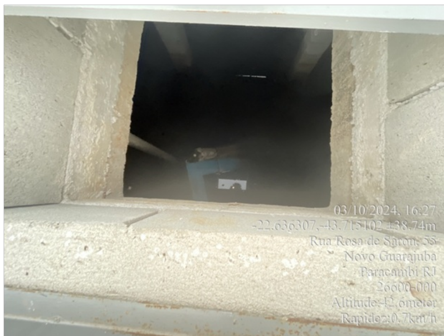
Foto 08 – Tanque SBR em decantação
