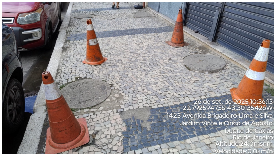
Foto 03 – Caixas de coleta do esgoto proveniente do estabelecimento.
