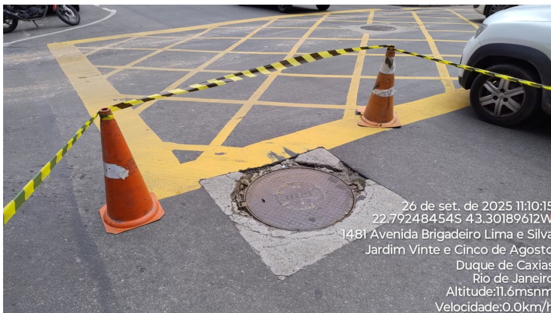
Foto 06: Poço de visita da rede de esgoto na esquina da Av. Brigadeiro Lima e Silva com a Rua General Dionísio.
