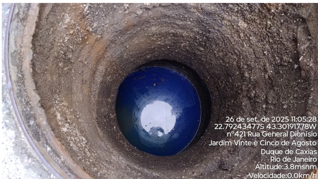
Foto 09: Poço de visita da rede de esgoto na esquina da Av. Brigadeiro Lima e Silva com a Rua General Dionísio após a chegada do corante.
