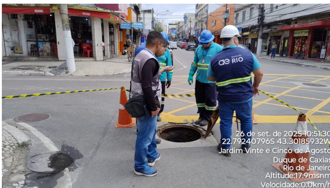
Foto 07: Poço de visita da rede de esgoto na esquina da Av. Brigadeiro Lima e Silva com a Rua General Dionísio.
