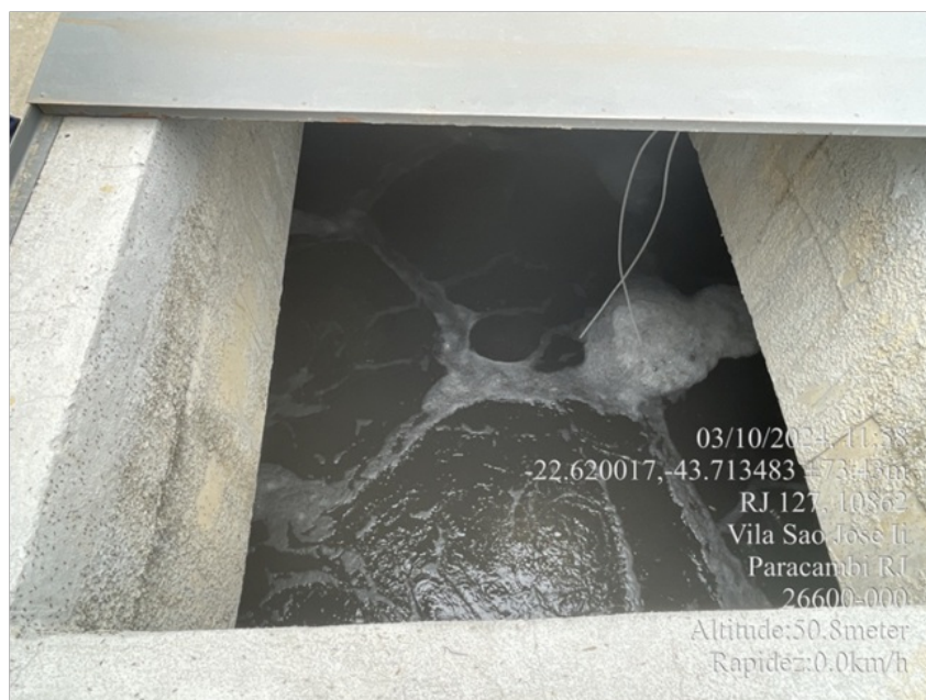
Foto 09 – Tanque de aeração
