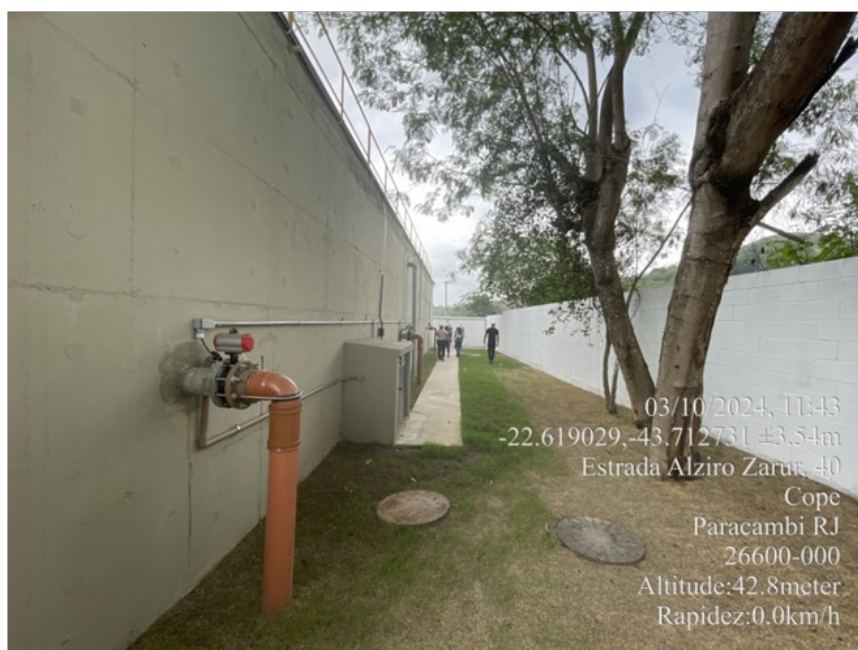
Foto 15 – Válvula de retenção na saída do efluente para calha
