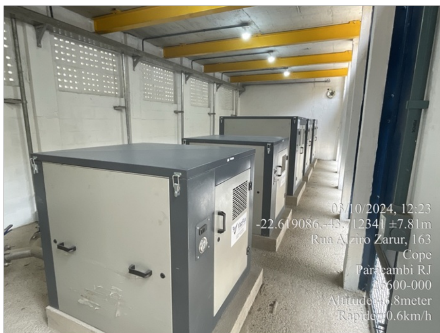
Foto 11 – Sala dos sopradores dos reatores
