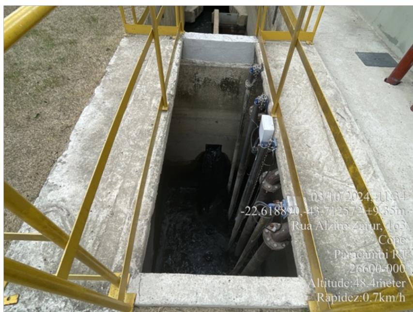
Foto 07 – Poço de sucção
