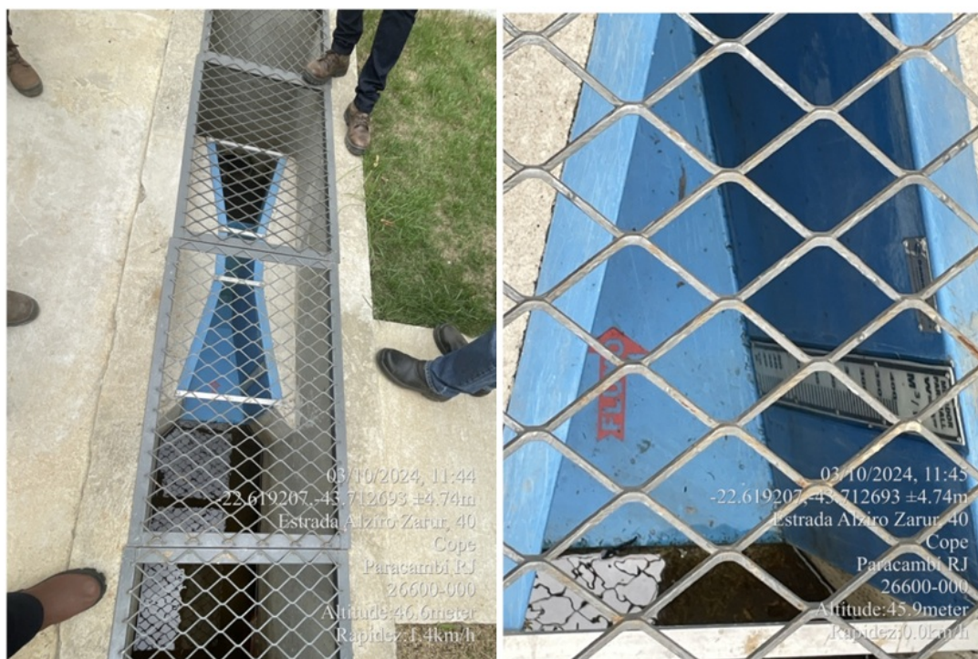
Foto 16 – Calha Parshall e Régua de medição de vazão
