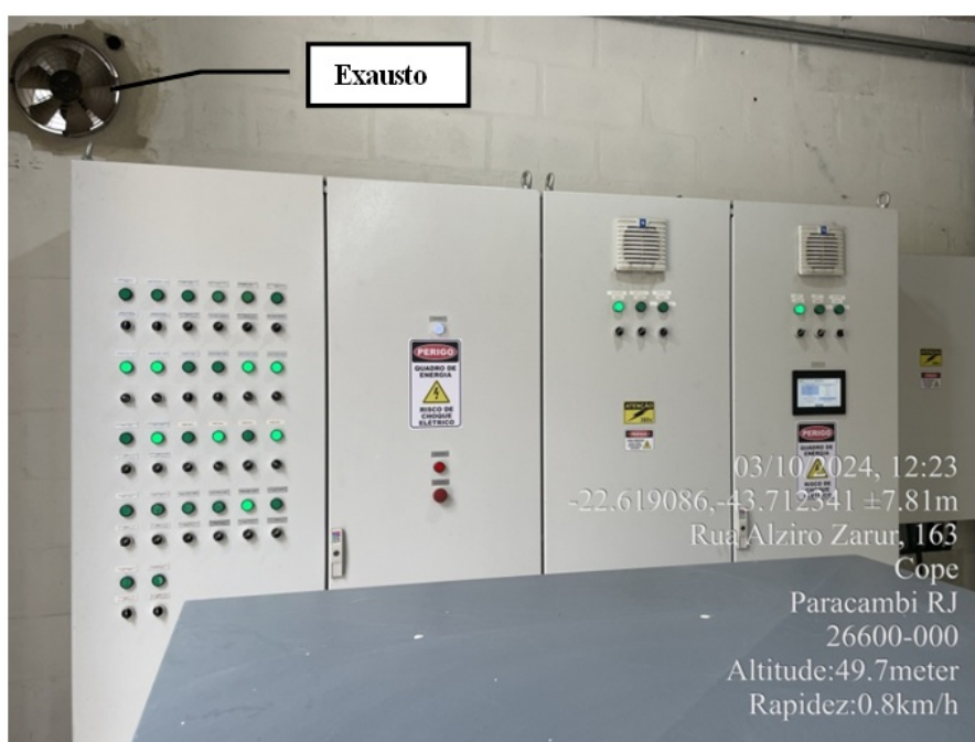
Foto 13 – Quadro de comando
