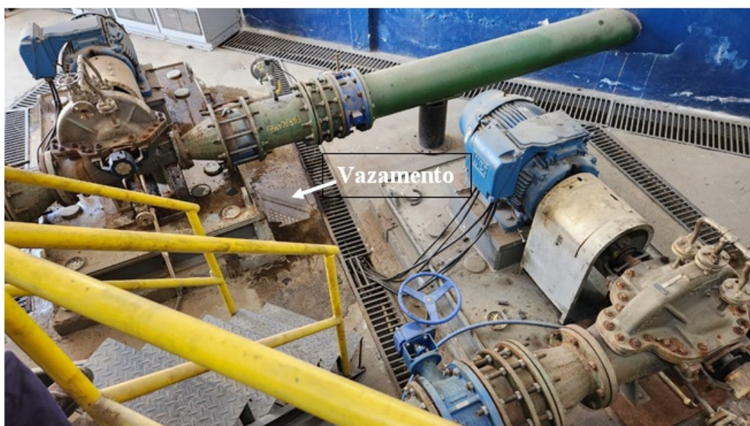
Foto 14 – Vazamento no G - 1
