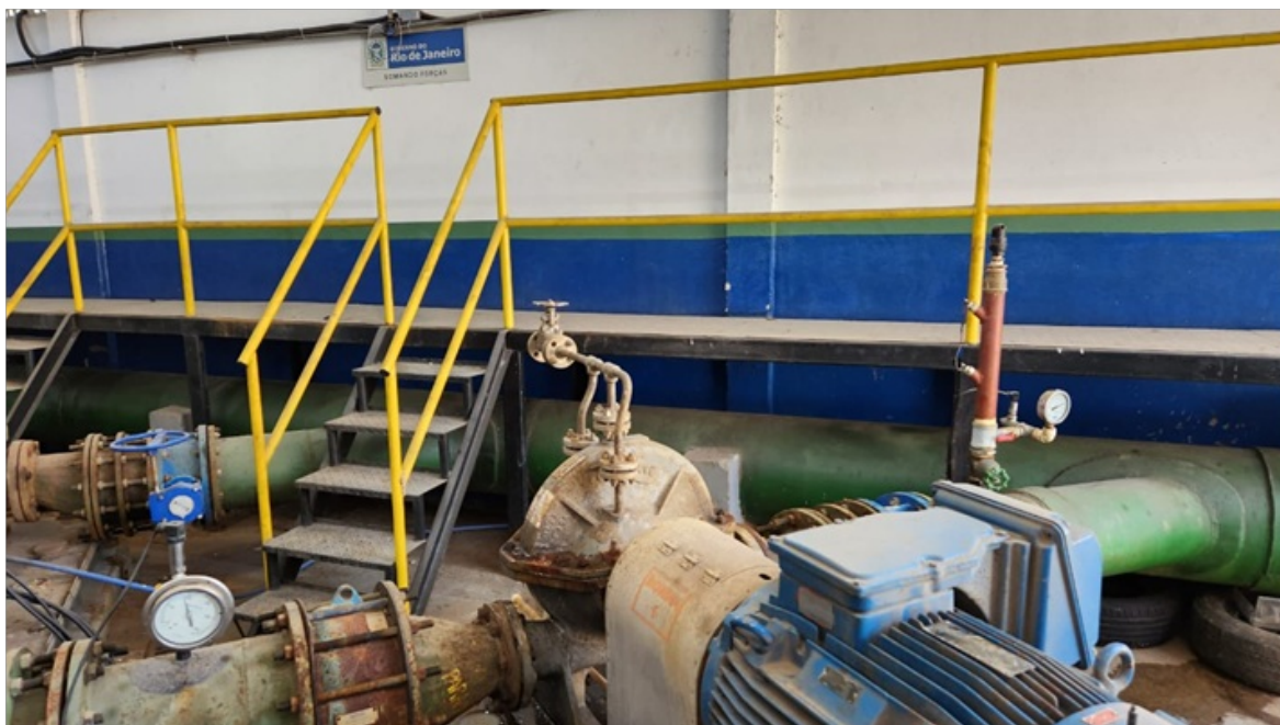
Foto 10 – Tubulação de retaguarda (DN 300 mm)
