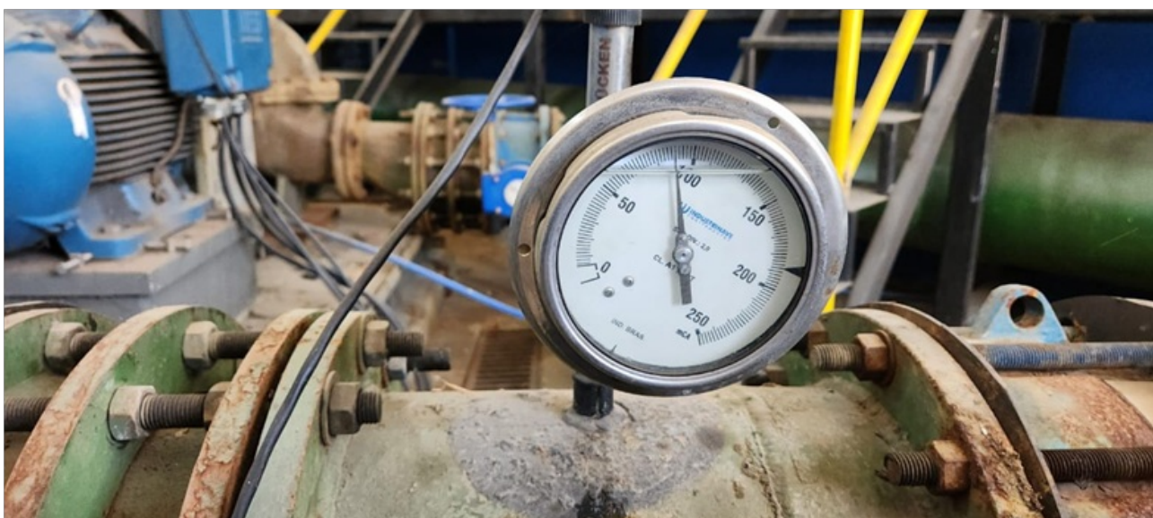
Foto 9 – Pressão manométrica de recalque
