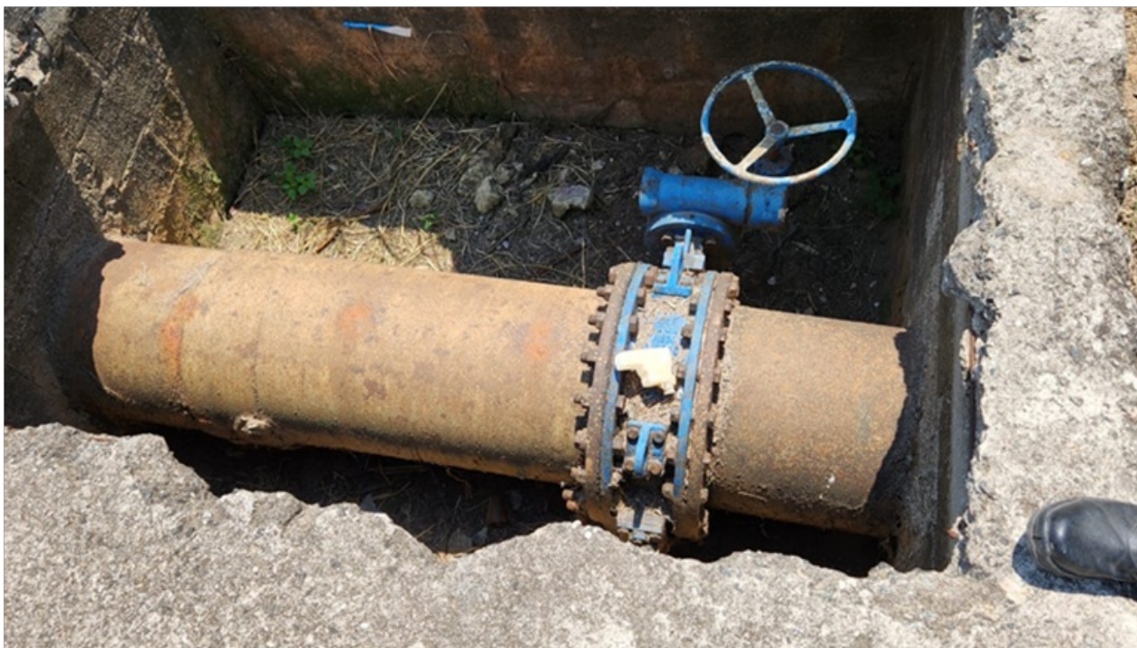
Foto 13 – Tubulação de saída do booster
