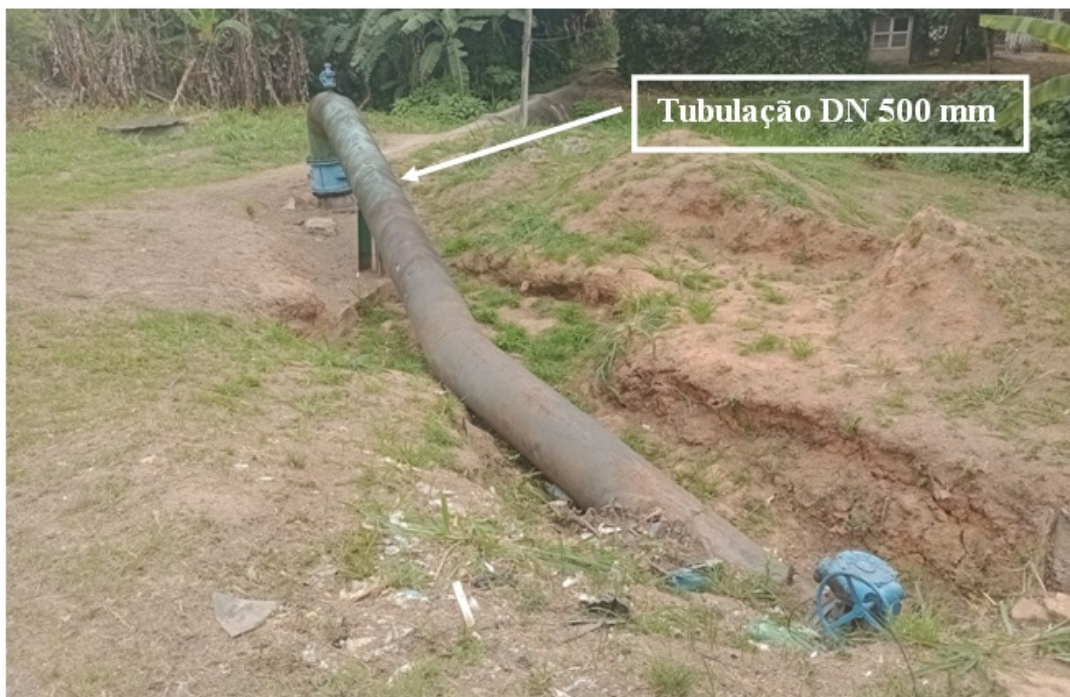
Foto 1 – Alça hidráulica (tubulação DN 500 mm) que sai da 1ª Adutora de Ribeirão das Lajes (1ª A.R.L.)
