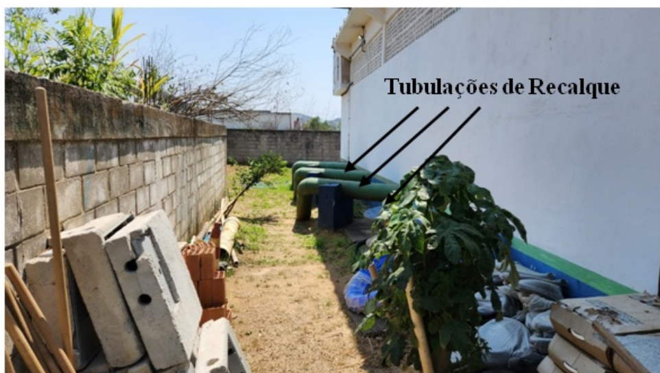
Foto 11 – Tubulação de recalque (DN 300 mm)
