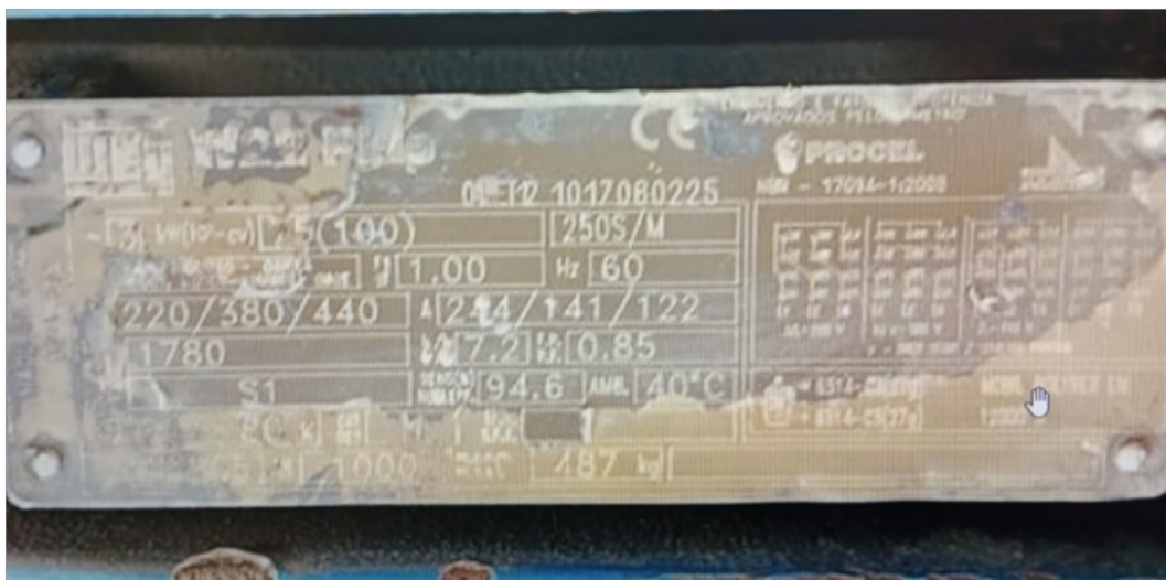
Foto 7 – Potência do equipamento
