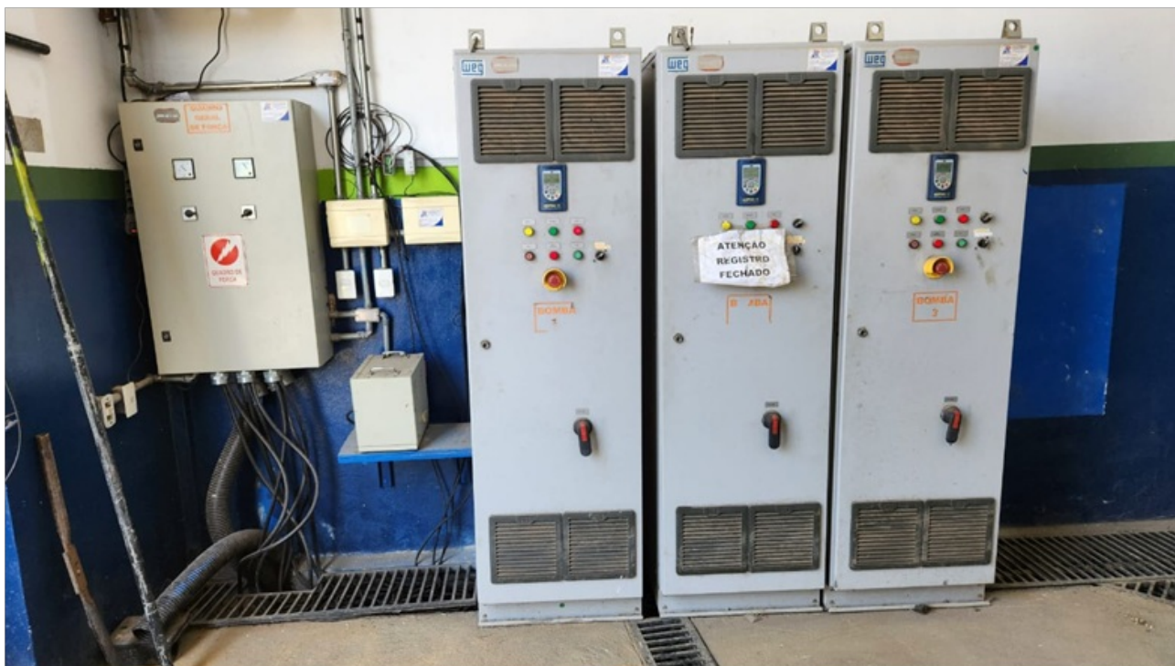
Foto 15 – Quadros elétricos e de automação
