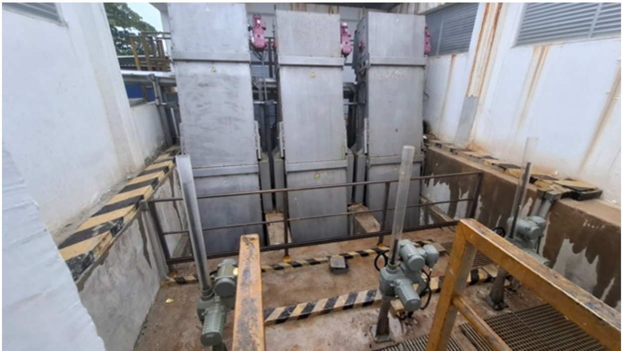
Foto 9 – Gradeamentos mecânicos com válvulas de fechamento
