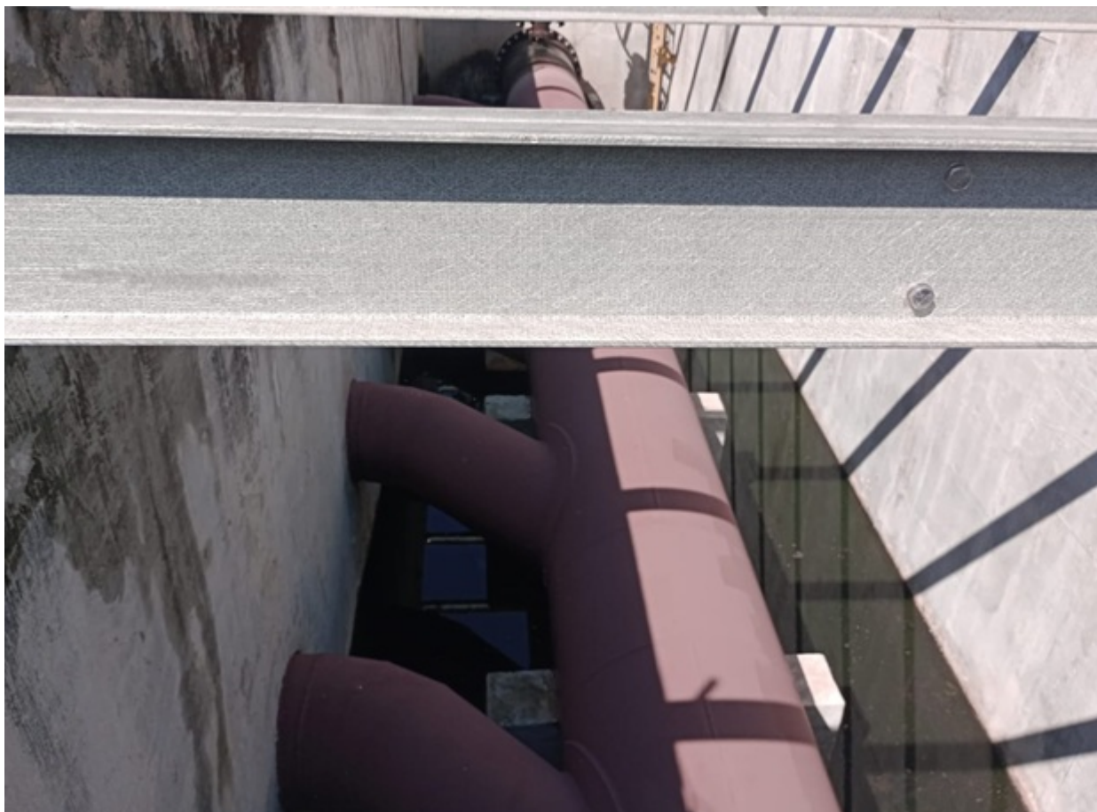
Foto 21 – Barrilete com as tubulações de recalque interligadas
