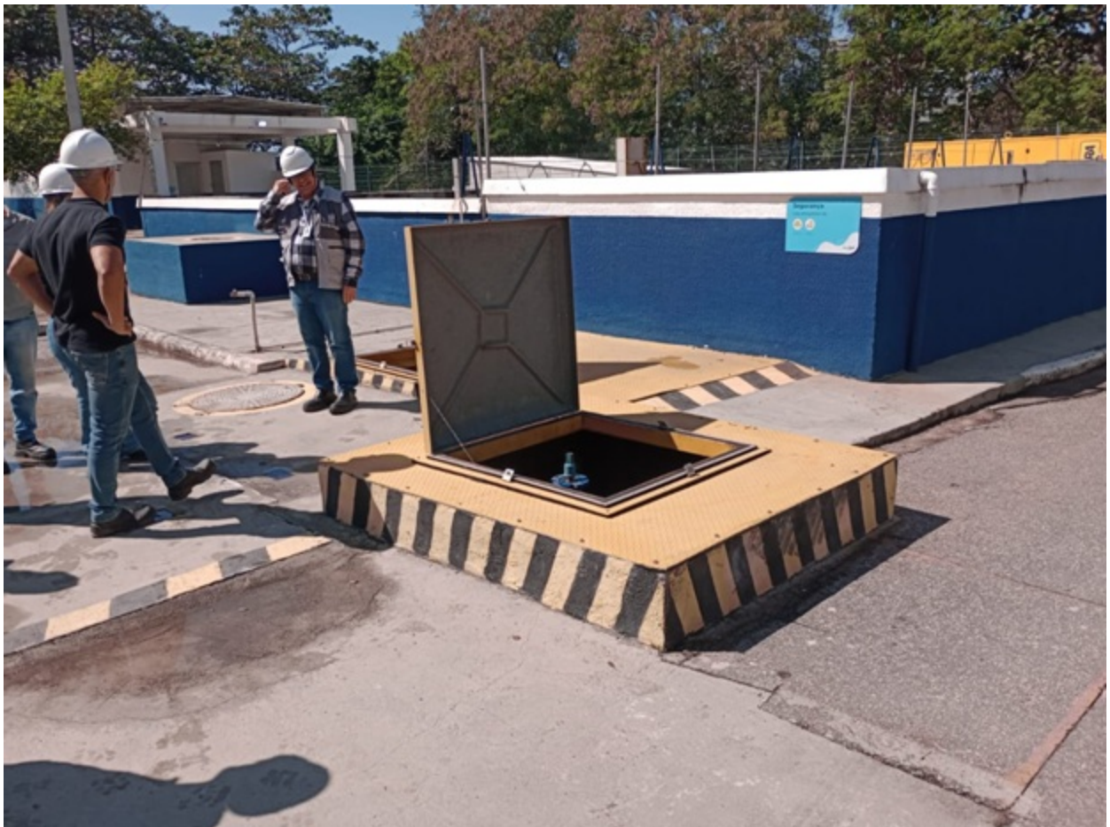
Foto 27 – Caixa da válvula de fechamento
