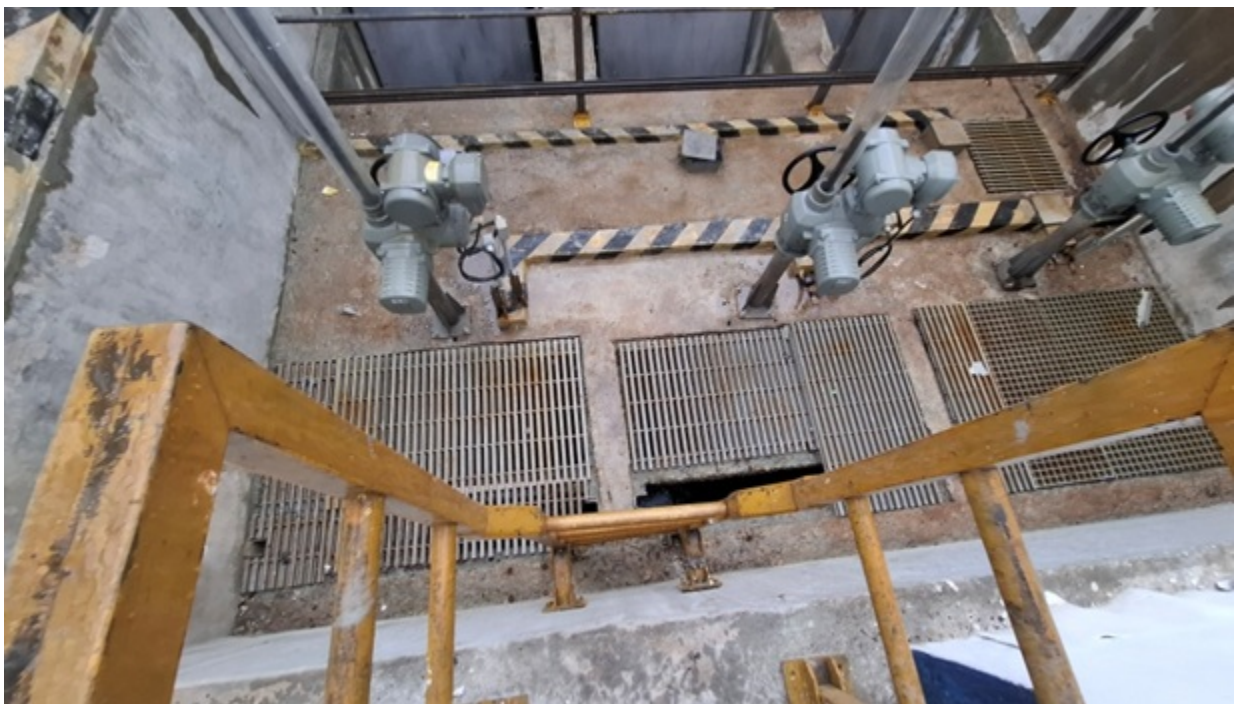
Foto 10 – Válvulas de fechamento
