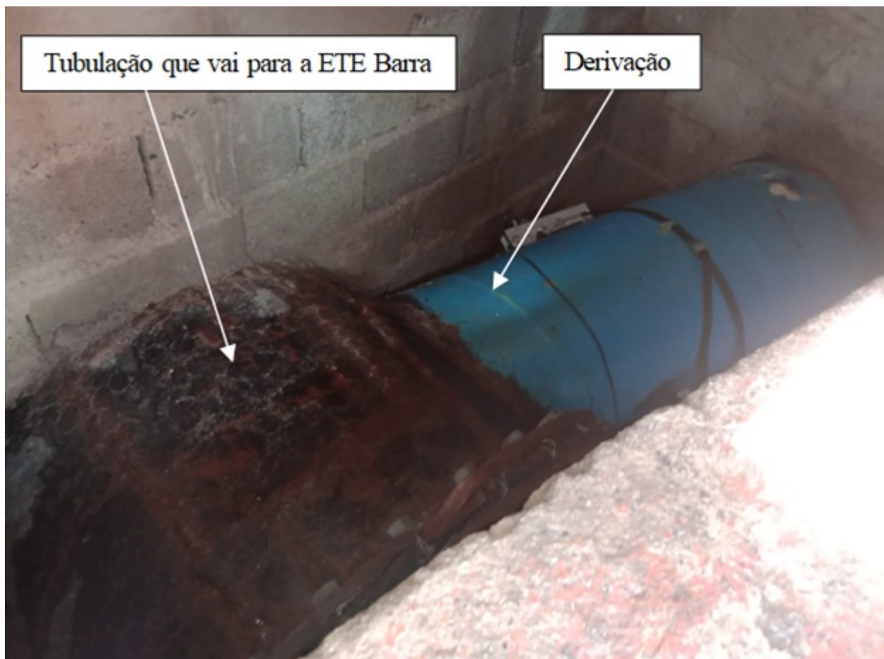
Foto 25 – Derivação da tubulação que é encaminhada para a ETE Barra
