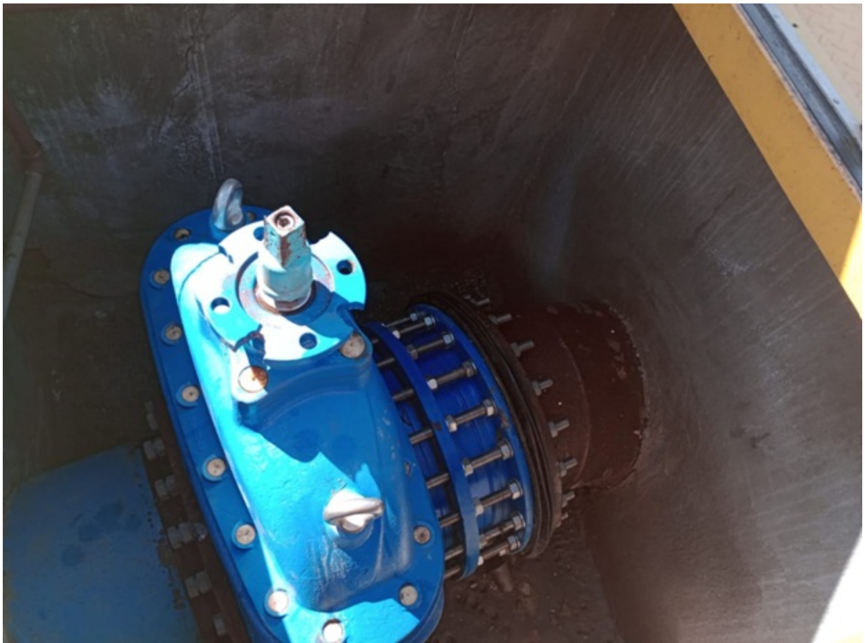
Foto 26 – Válvula de fechamento
