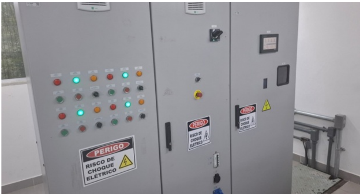
Foto 16 – Paineis de controle das motobombas
