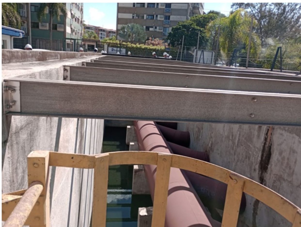
Foto 22 – Barrilete com as tubulações de recalque interligadas
