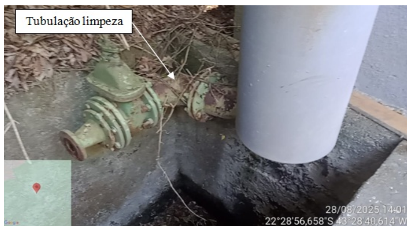
Foto 9 – Válvula e tubulação de limpeza
