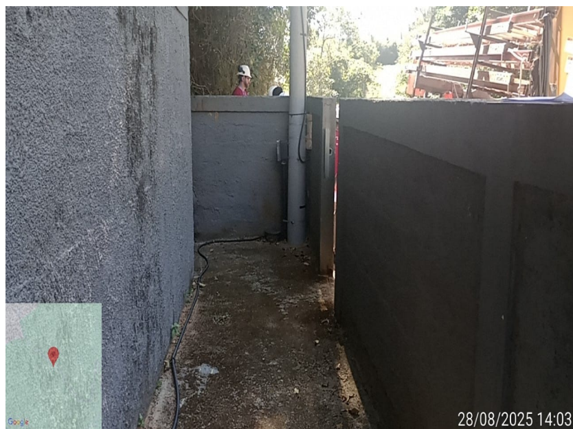
Foto 5 – Pintura da Caixa desgastada
