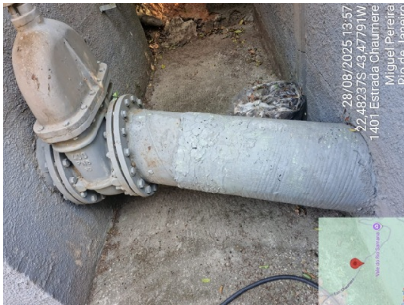
Foto 12 – Válvula e tubulação de distribuição
