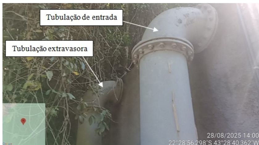
Foto 7 – Tubulações de entrada e extravasora
