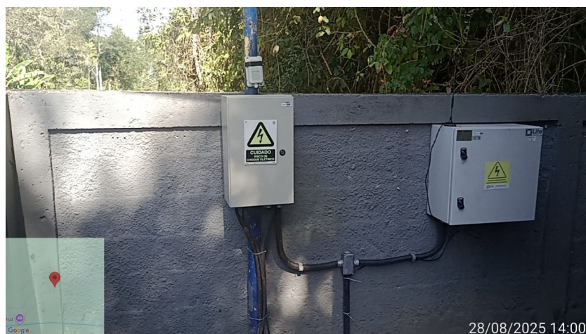
Foto 3 – Equipamentos elétricos com sinalização de advertência
