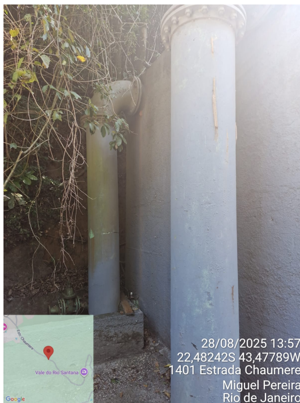
Foto 8 – Tubulações de entrada e extravasora
