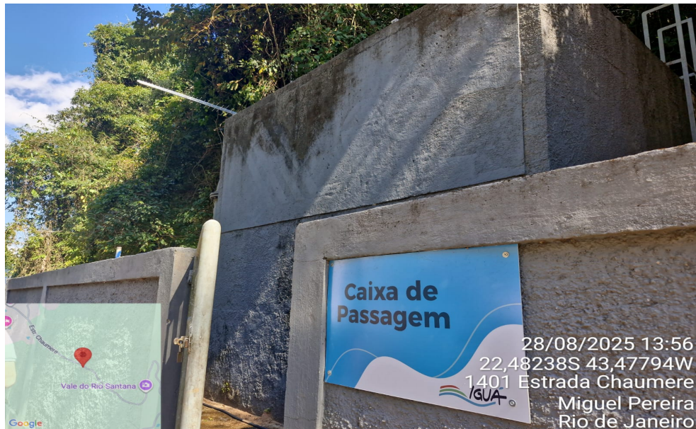
Foto 4 – Pintura da Caixa desgastada
