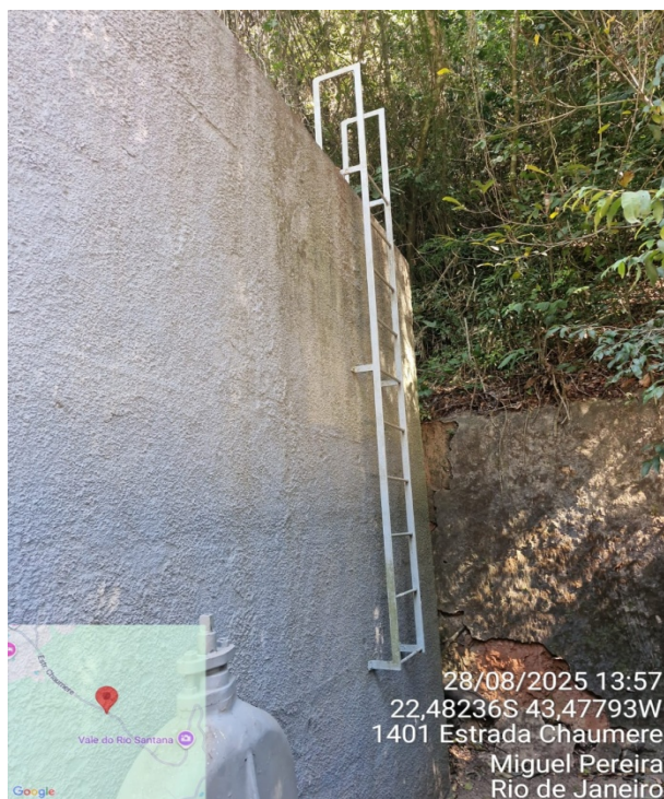
Foto 6 – Escada externa sem proteção
