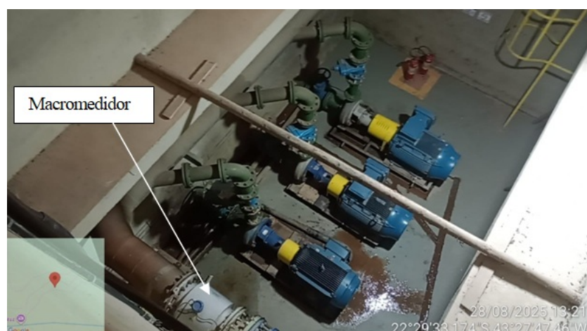
Foto 12 – Poço das motobombas
