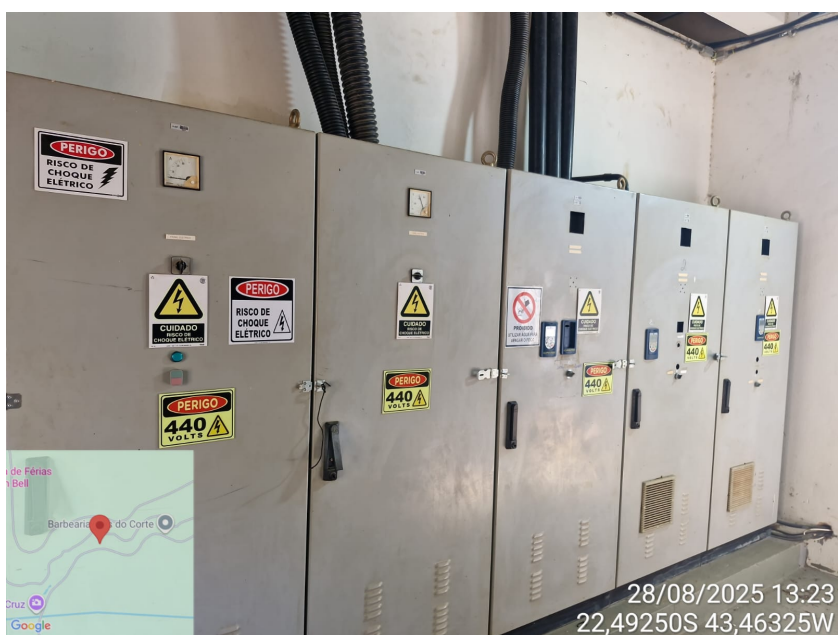
Foto 13 – Painéis das motobombas
