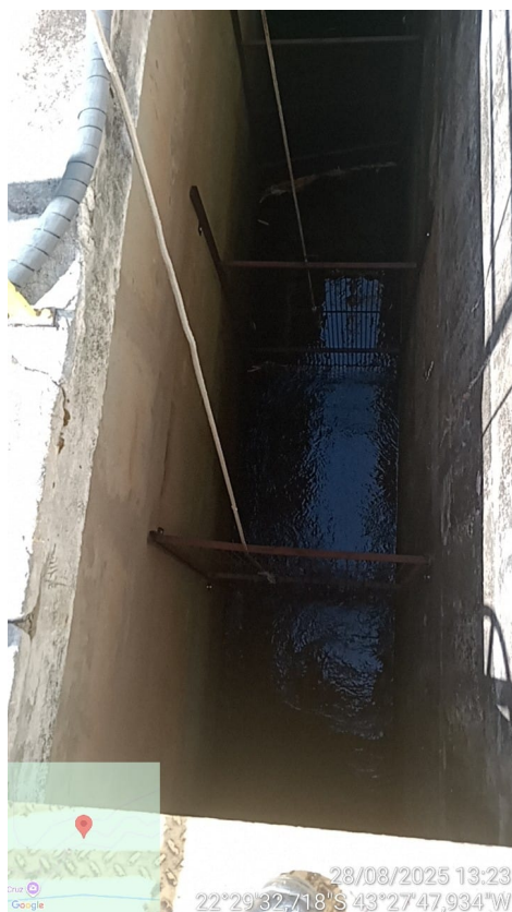
Foto 7 – Caixa de captação
