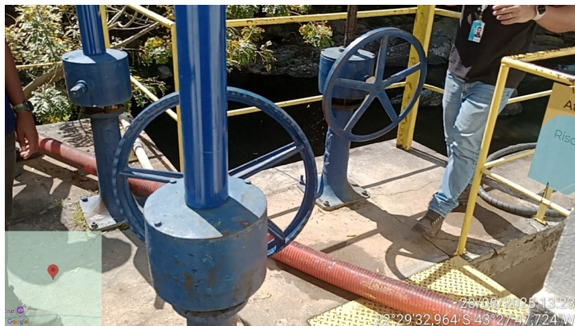
Foto 9 – Válvulas de fechamento
