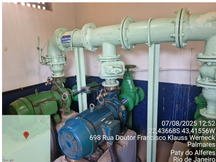
Foto 5 – Tubulações de sucção, recalque e barrilete
