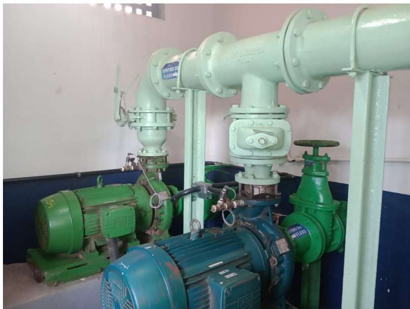
Foto 9 – Grupos motobombas e partes elétricas
