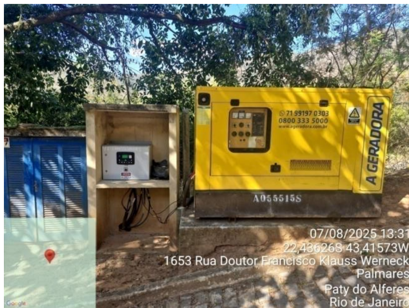
Foto 4 – Gerador e bacia de contenção
