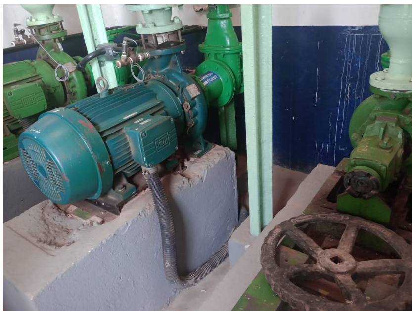
Foto 10 – Grupos motobombas e partes elétricas
