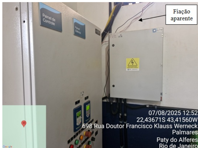
Foto 14 – Sinalização de advertência e fiação aparente
