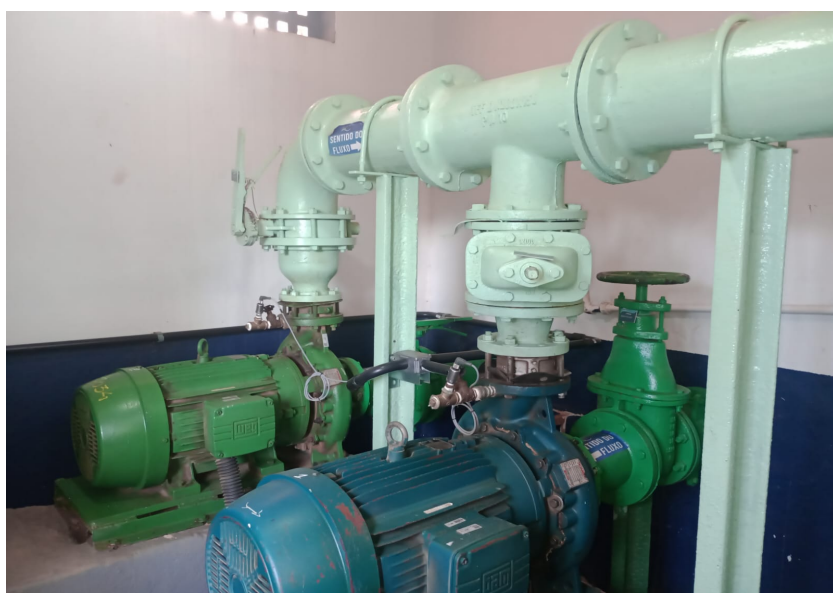
Foto 12 – Válvulas de fechamento e de retenção
