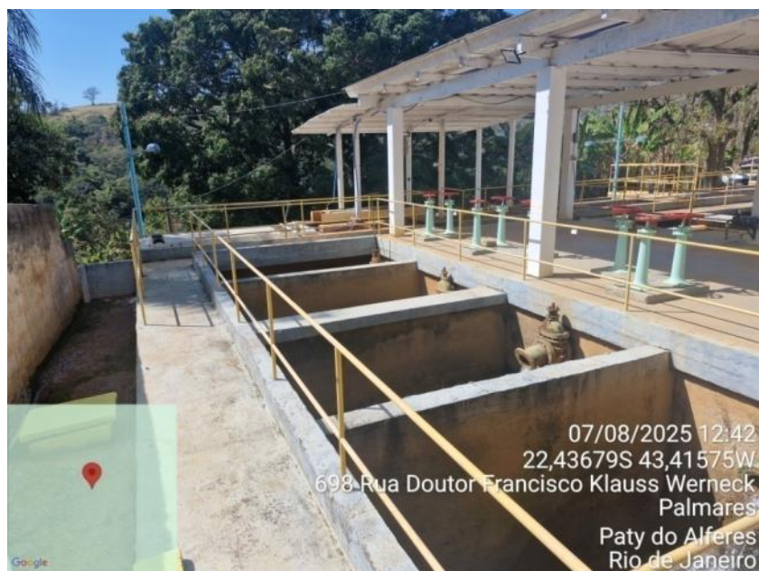
Foto 24 – Filtros da ETA
