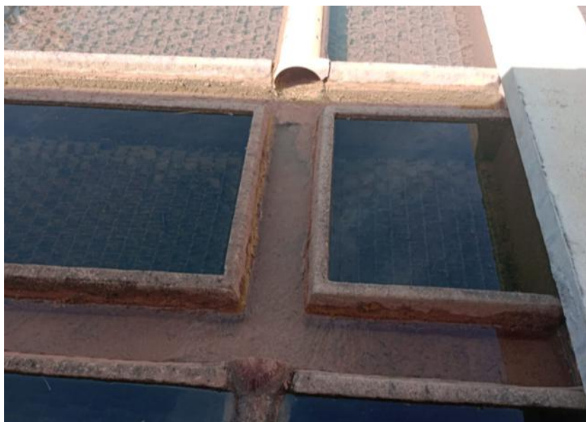
Foto 20 – Tubo desguando na canaleta
