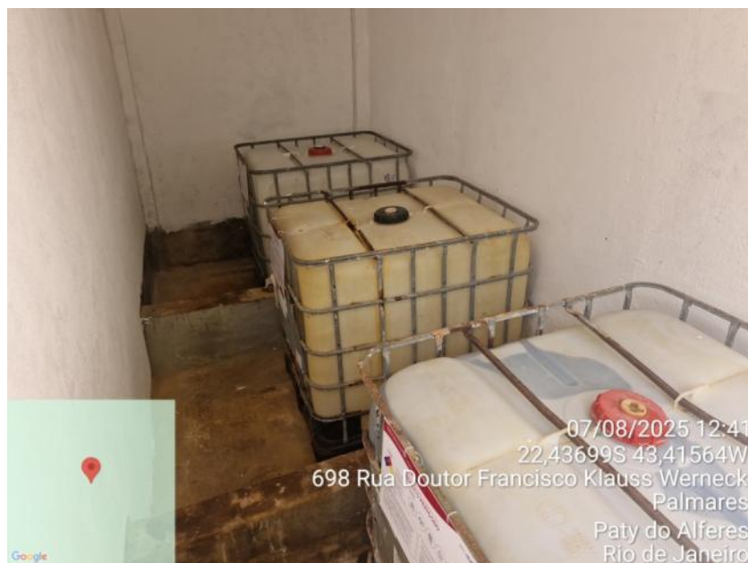
Foto 31 – Compartimento para estoque de produtos químicos (diques de contenção)
