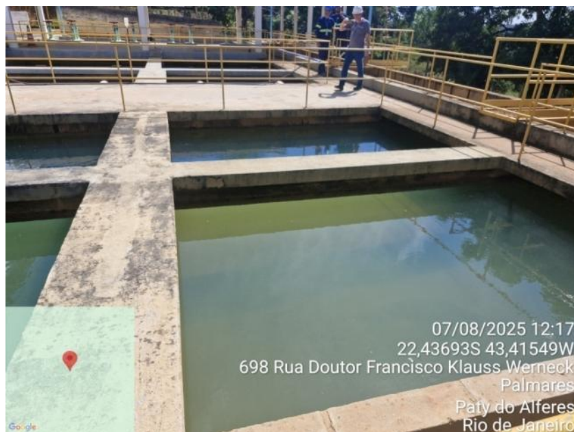
Foto 15 – Decantador 1(fluxo horizontal)
