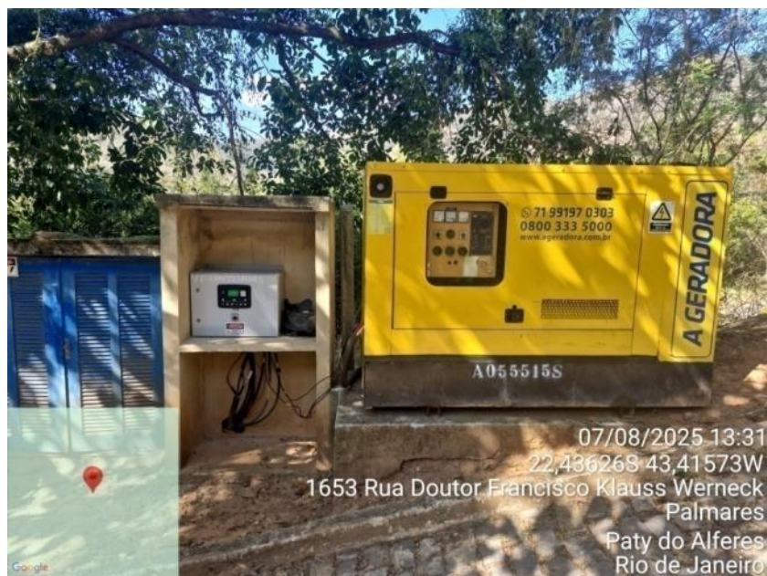
Foto 33 – Gerador de energia elétrica
