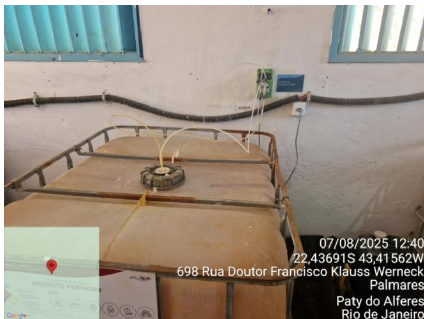
Foto 32 – Sistema de gotejamento
