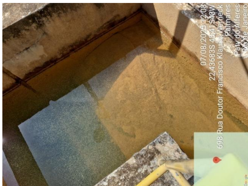
Foto 14 – Acúmulo de sedimentos
