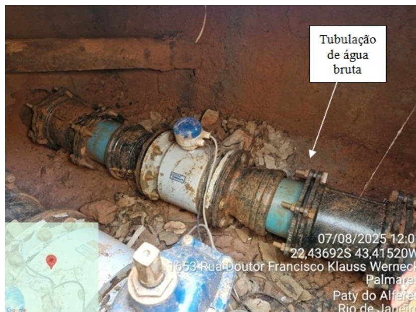
Foto 4 – Tubulação de água bruta (DN 200 mm) originária dos mananciais
