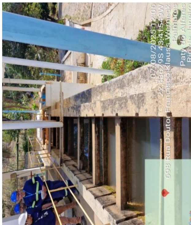
Foto 11 – Flocculador com chicanas verticais
