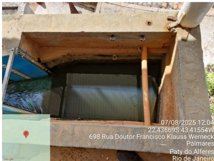
Foto 6 – Chegada da água bruta na Calha Parshall
