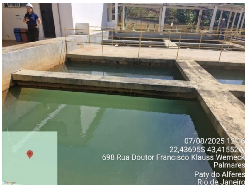
Foto 16 – Decantador 2 (fluxo horizontal)
