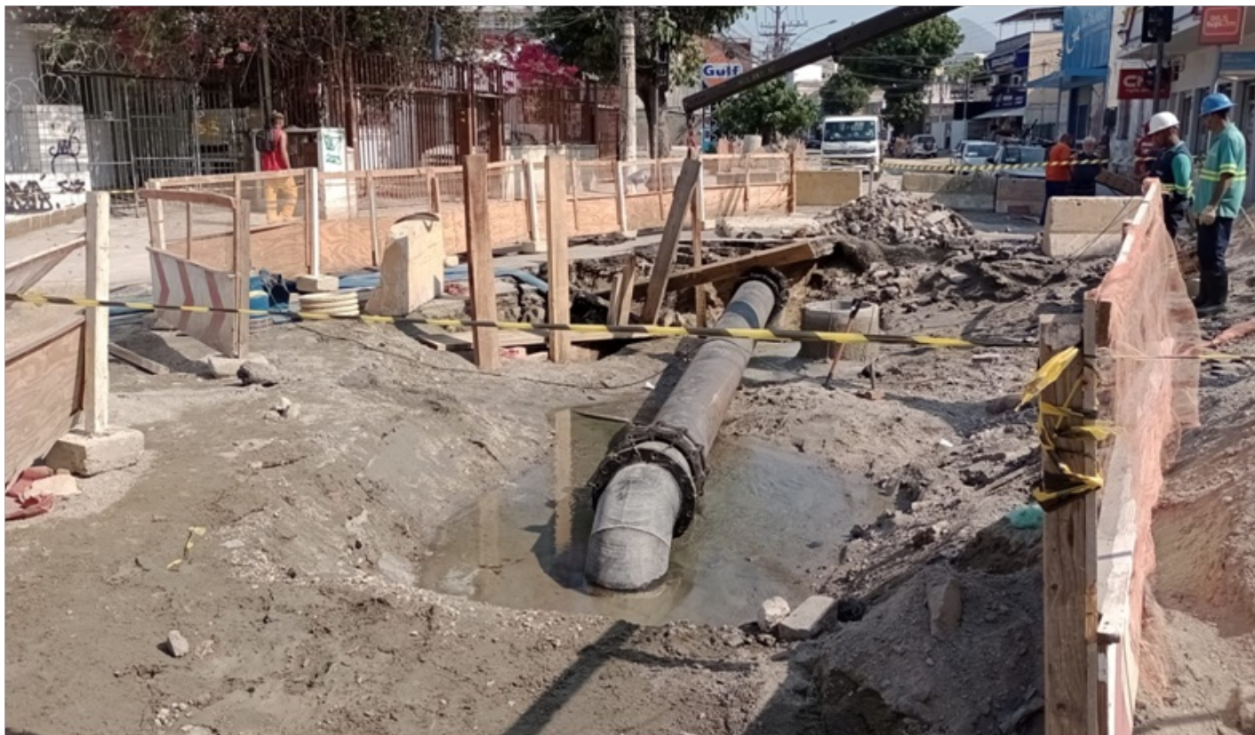
Foto 3 – Vazamento na tubulação à jusante
