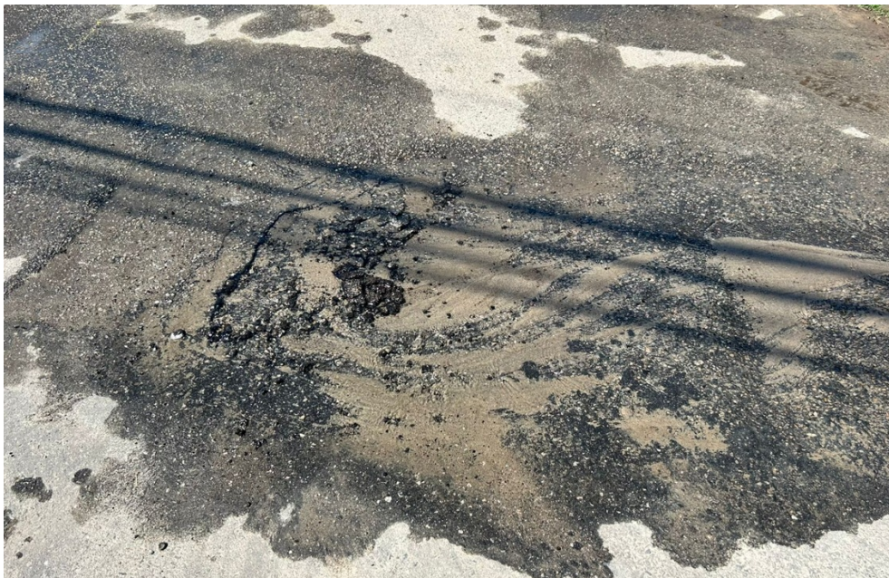
Foto 18 – Vazamento encontrado na Rua Palmácia, esquina com Rua Montezuma.
