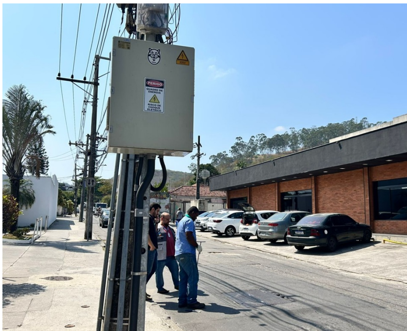
Foto 7 – Localização do booster implantado na Rua Hugo Gonçalves
