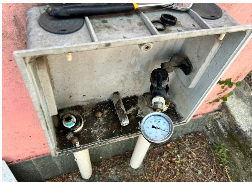
Foto 6 - Imóvel nº 116, aferição de pressão de 13 mca
