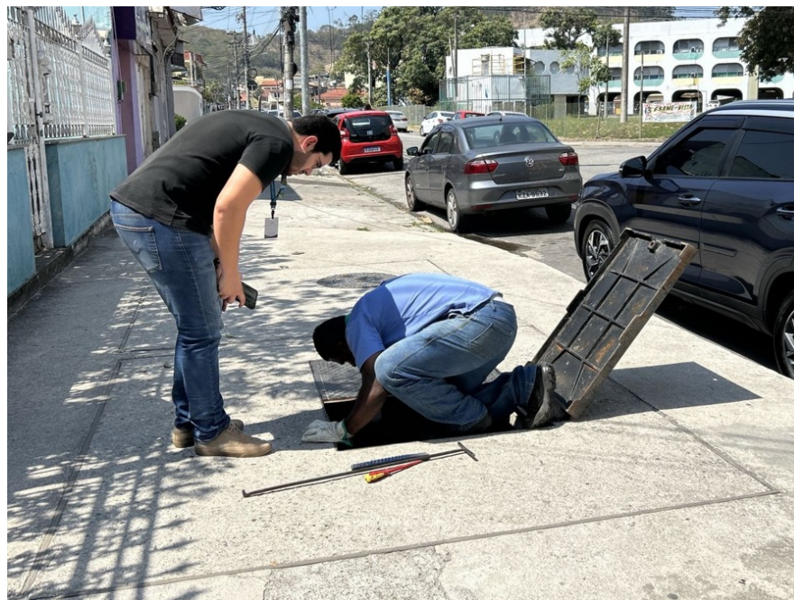
Foto 12 – Localização do booster na Rua Timbaúba
