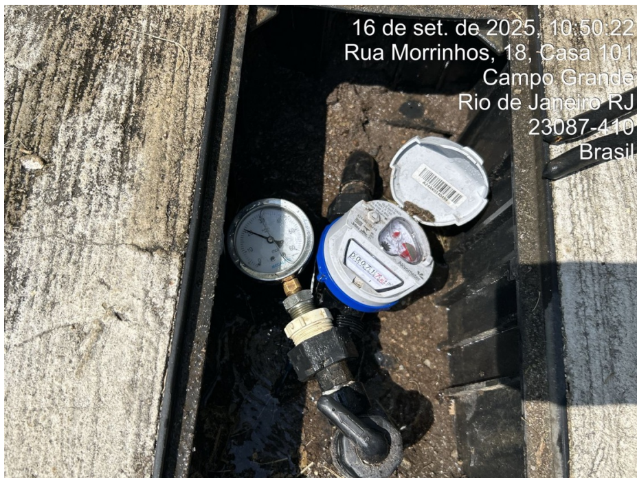
Foto 15 – Imóvel nº 18, Rua Morrinhos, aferição de pressão de 26 mca
